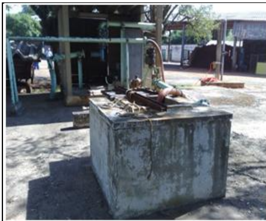
Figura 21 - Caixa de recirculação das águas de lavagem dos filtros
