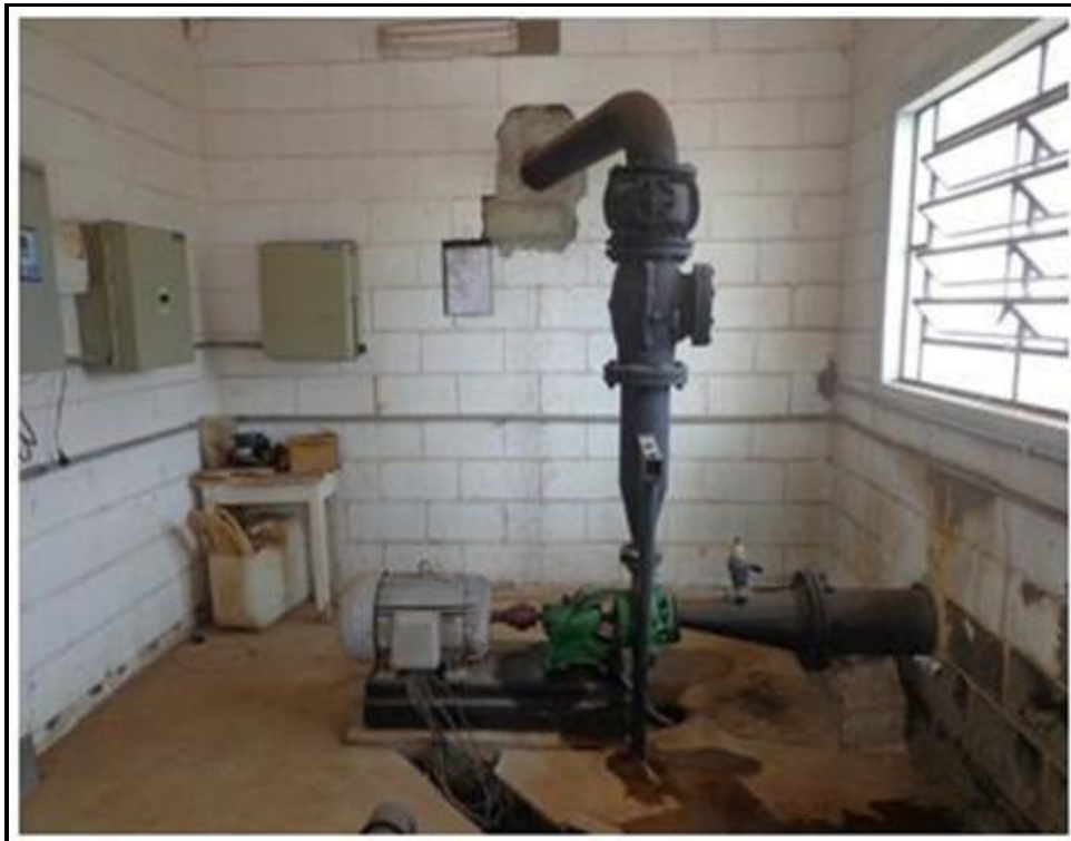
Figura 29 - Recalque para o reservatório Jardim São Francisco
