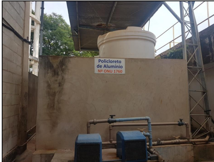
Figura 14 - Tanque de armazenamento de PAC
