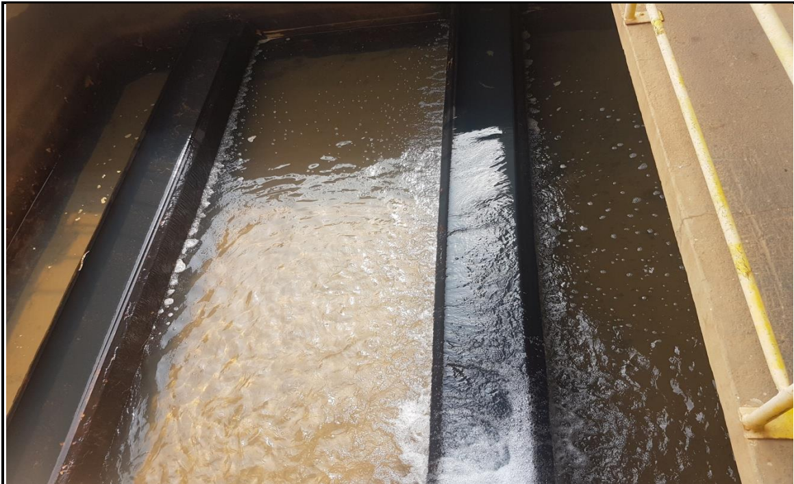
Figura 13 - Filtro em processo de lavagem
