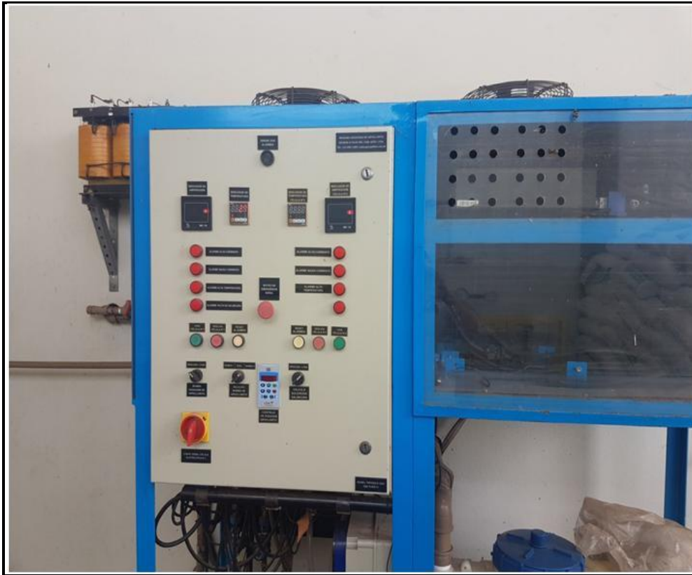
Figura 38 - Gerador de Hipoclorito
