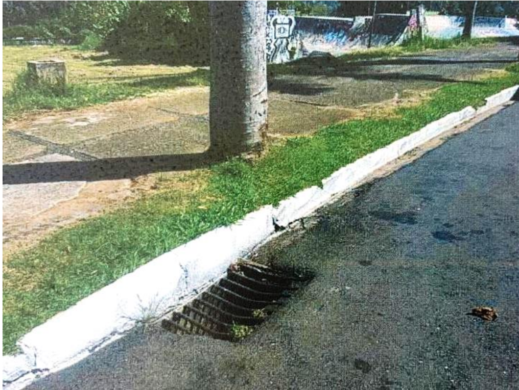
Figura 45 - Boca de lobo com grelha
