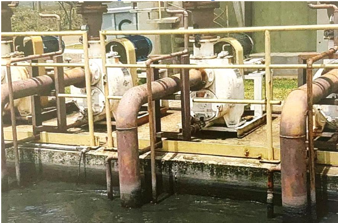
Figura 39 - Elevatória de esgotos
