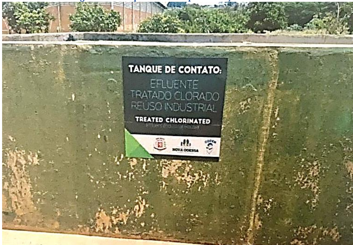
Figura 41 - Tanque de contato para cloração do efluente
