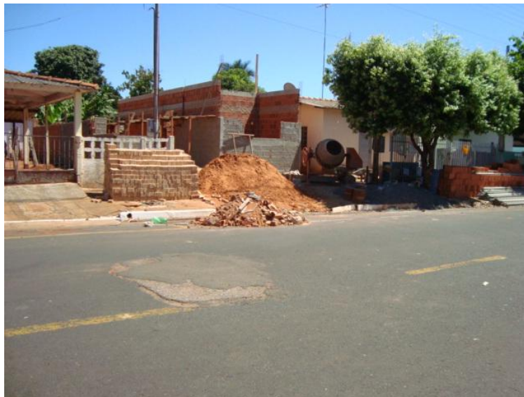
RESIDUOS DA CONST. CIVIL DISPOSTOS INADEQUAD/E EM LOGRADOUROS PUBLICOS.
