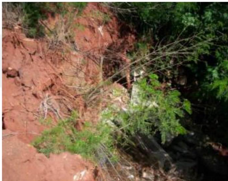
FIGURA 128 – Vista parcial do trecho inicial da erosão no cruzamento da Avenida Atlântica com a Alameda Itaipu, em detalhe o grau de destruição, ao lado galeria pluvial de diâmetro 1,20 m
