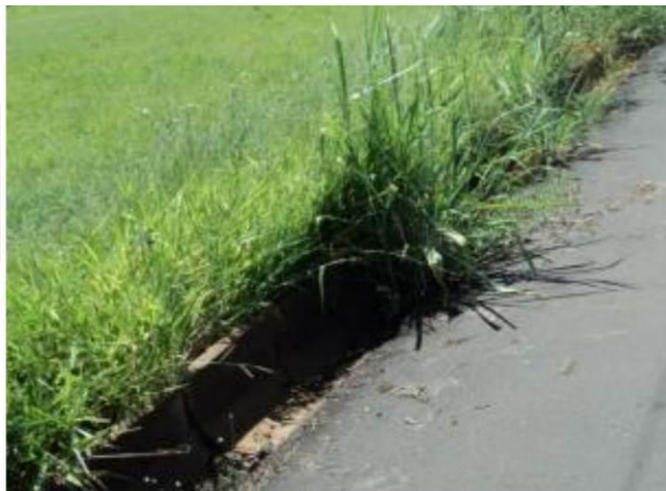
FIGURA 141 – Canaleta do sistema de drenagem urbana sem manutenção e limpeza necessária para seu adequado funcionamento
