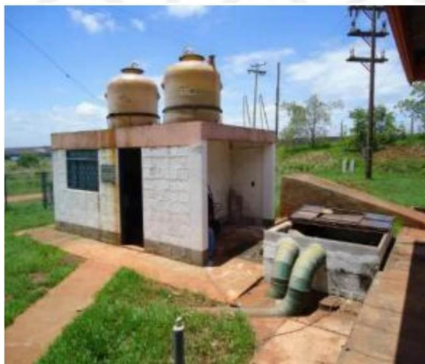
FIGURA 42 – Estação de Sistema de Recalque 3: caixa de chegada onde é dosado o flúor
