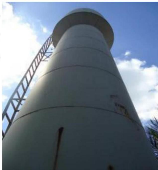
FIGURA 76 - Vista alternativa do reservatório de água potável no sistema Lote 76
