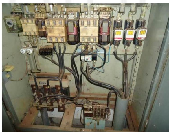
FIGURA 88 – Vista interna do painel de energização e comando dos conjuntos moto bomba da EEE 2
