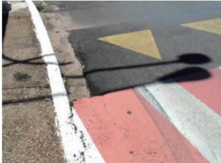
FIGURA 140 – Obstáculos redutores de velocidade sem canal para escoamento das águas pluviais
