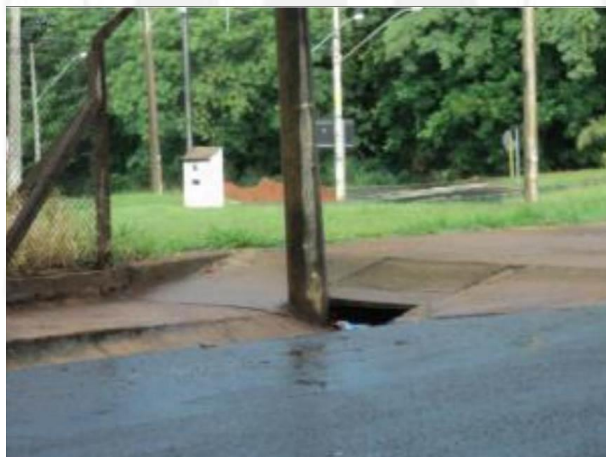
FIGURA 157 – Captação de água pluvial na Avenida Continental
