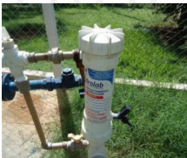
FIGURA 73 – Dosador de flúor integrado no reservatório de água potável no sistema Lote 76
