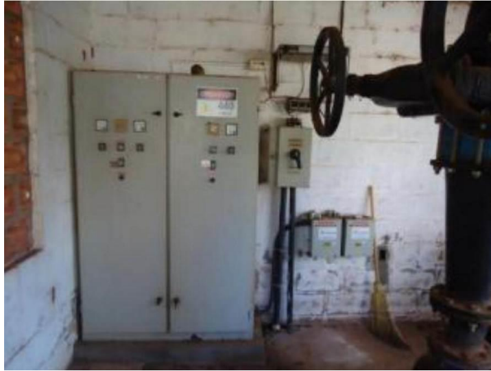
FIGURA 53 – Casa de máquina do sistema intermediário
