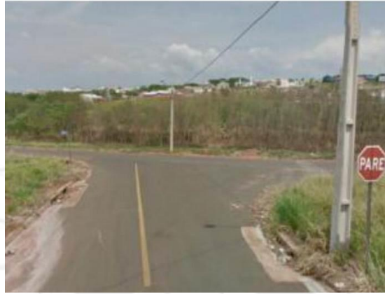
FIGURA 188 – Bocas de lobo obstruídas por folhas e detritos na esquina da Rua Cecília Meireles com a Rua Jorge Amado
