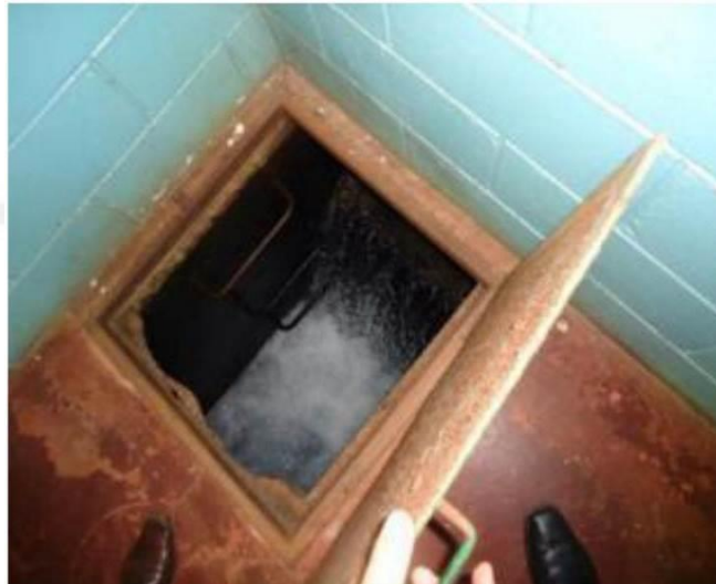
FIGURA 45 – Reservatório aterrado no Sistema de Recalque 3
