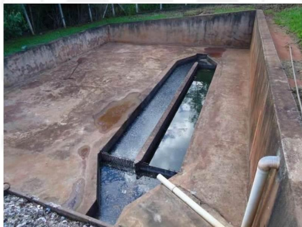
FIGURA 98 – Caixa de areia da EEE4
