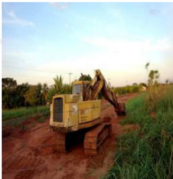
FIGURA 83 – Escavadeira de esteira do DAE auxiliando nas obras de saneamento do loteamento Morada do Sol
