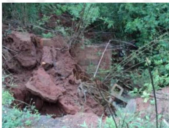
FIGURA 164 – Saída e lançamento a jusante da travessia da Avenida Atlântica com deslizamento do solo comprometendo a estabilidade da avenida
