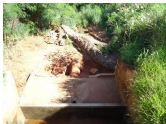
FIGURA 184 – Estrutura de controle do escoamento das águas pluviais danificada a jusante da travessia da Rua Sete de Setembro
