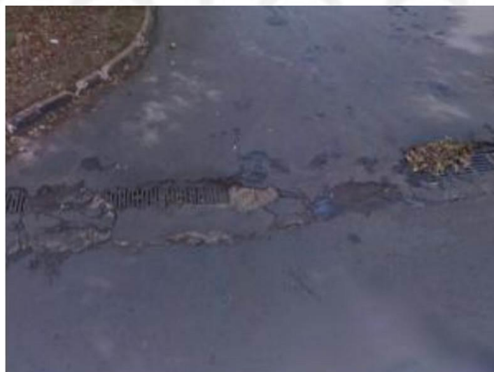
FIGURA 147 – Bocas de lobo na esquina das ruas Cristalina, Barras e Alameda Goiás
