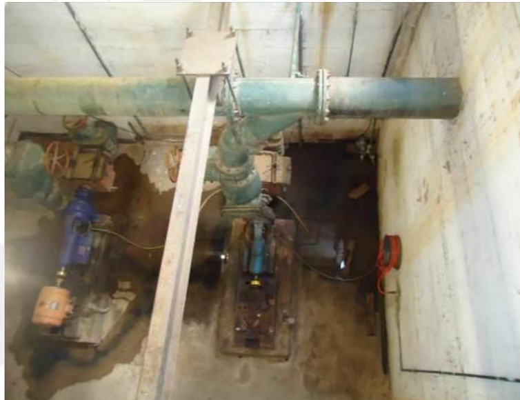
FIGURA 90 – Conjunto moto bomba 1 e 2 da EEE 2
