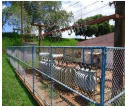
FIGURA 51 – Vista alternativa da subestação de energia elétrica responsável do abastecimento elétrico do Sistema de Recalque 3
