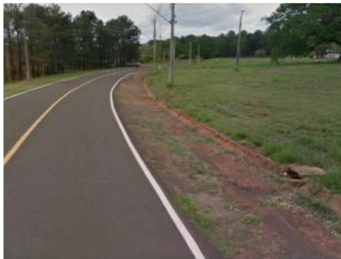
FIGURA 136 – Avenida Continental captação de águas pluviais por meio de canaletas circulares
