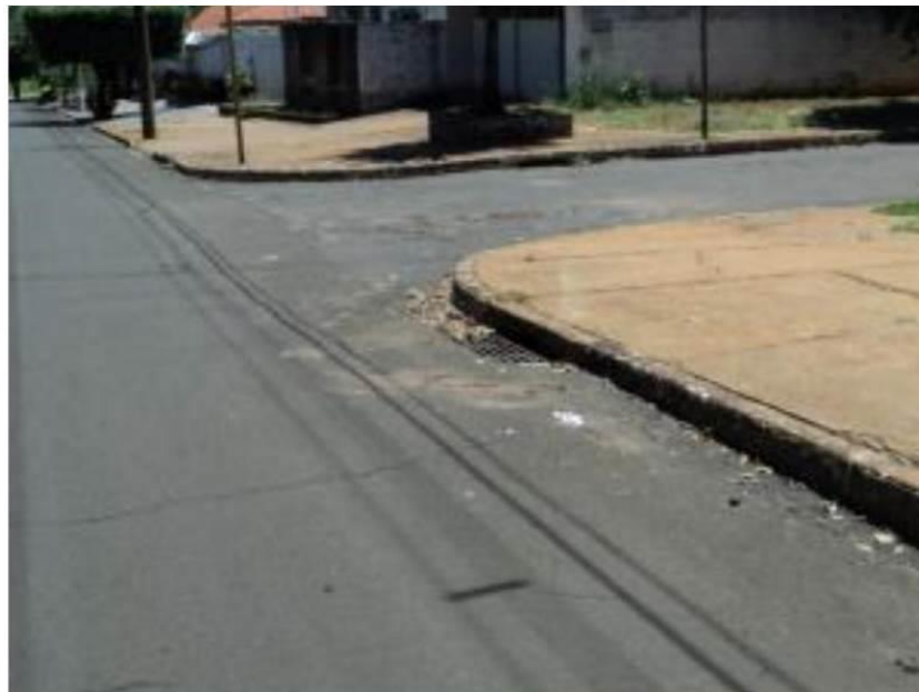
FIGURA 144 – Alameda Minas Gerais esquina com a Rua Ouro Preto: boca de lobo com depósito de folhagens
