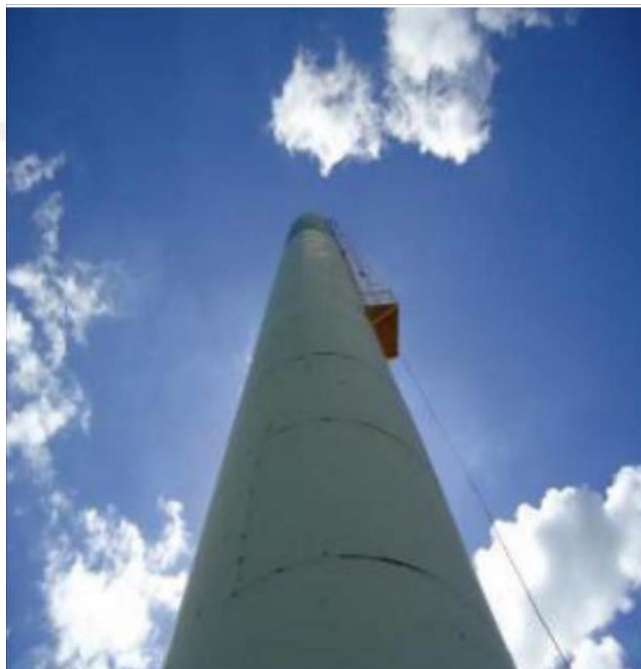
FIGURA 69 – Vista alternativa do reservatório de água potável no Recanto das Águas
