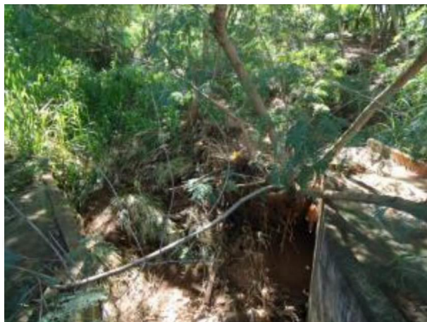
FIGURA 193 – Árvore caída devido à erosão lateral do córrego, obstruindo o canal
