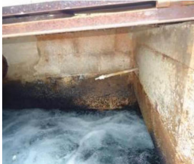
FIGURA 44 – Caixa de entrada das águas vindas dos poços de captação, em detalhe o dosador de flúor
