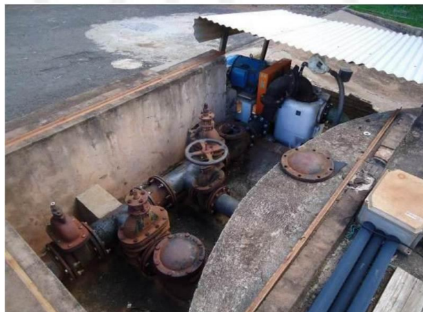
FIGURA 99 – Registro e válvulas de retenção no início da linha de recalque
