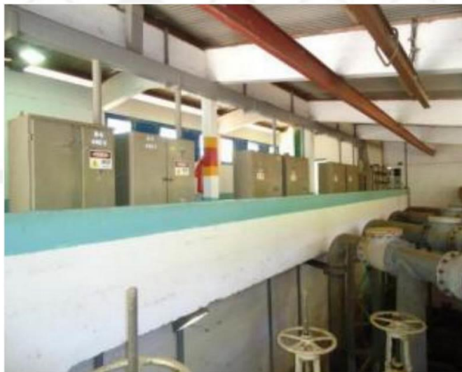
FIGURA 49 – Casa de máquinas do Sistema de Recalque 3
