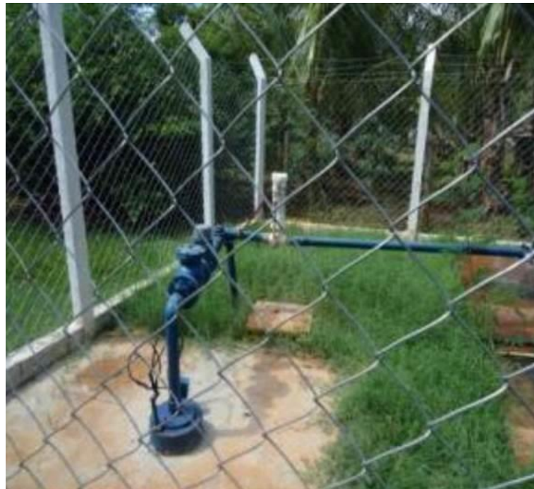
FIGURA 71 – Conjunto motobomba de captação de água do poço no sistema Lote 76
