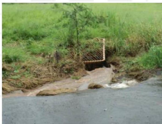
FIGURA 163 – Captação de água pluvial a montante da travessia na Avenida Atlântica
