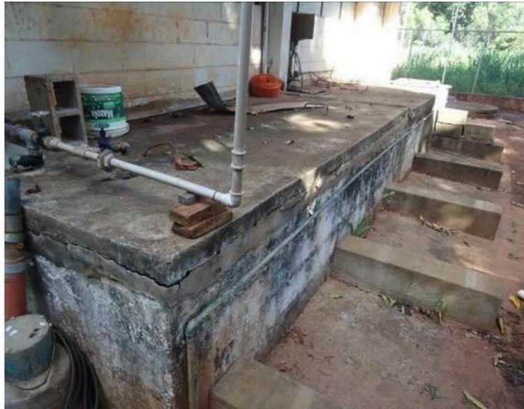
FIGURA 89 – Poço de sucção da EEE 2
