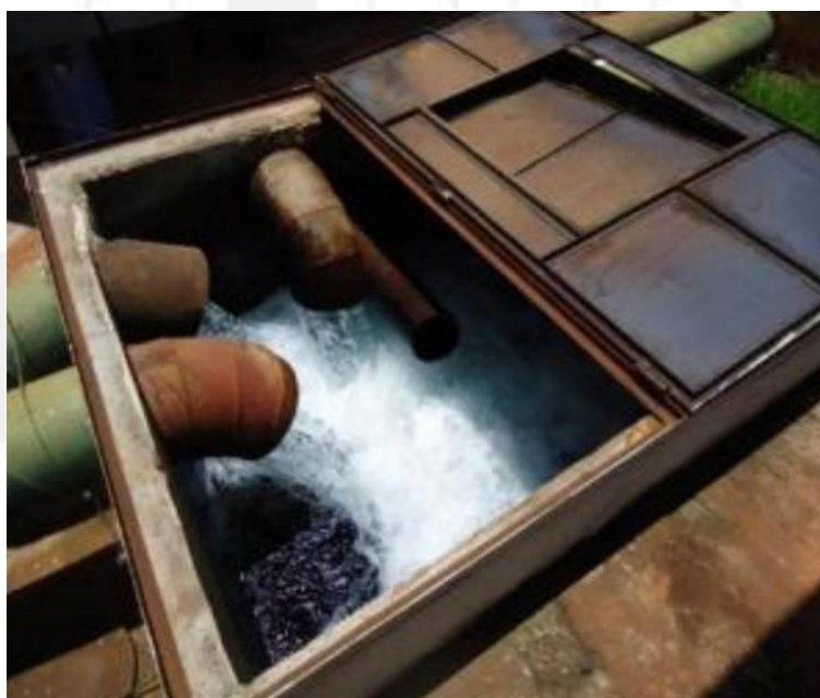
FIGURA 43 – Caixa de entrada das águas vindas dos poços de captação, onde é adicionado o flúor
