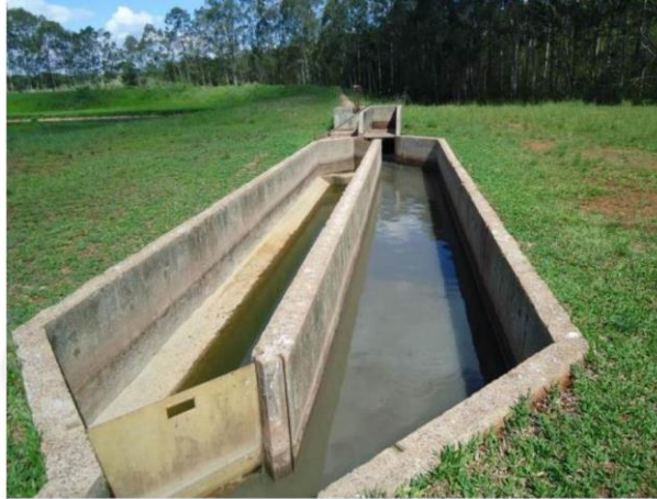
FIGURA 103 – Sistema de caixa de areia – Entrada da ETE Ilha Solteira
