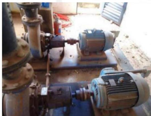
FIGURA 52 – Conjuntos motobomba Booster do sistema intermediário
