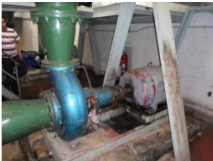
FIGURA 58 – Conjunto motobomba responsável pela elevação da água do reservatório aterrado para o reservatório elevado central
