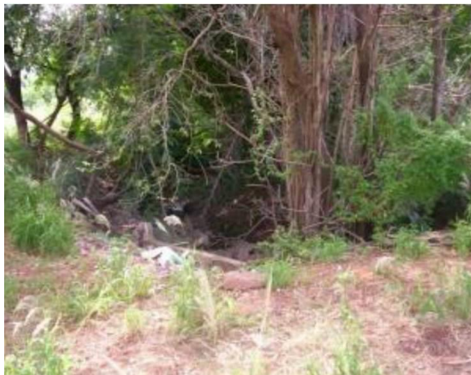
FIGURA 131 – Vista parcial do trecho inicial da Erosão nas imediações da Av. Continental, no local a saídas de galerias tubulares de diâmetro 1,20 m e 1,00 m
