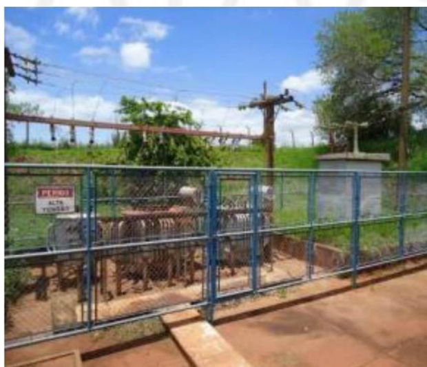
FIGURA 50 – Subestação de energia elétrica responsável do abastecimento elétrico do Sistema de Recalque 3
