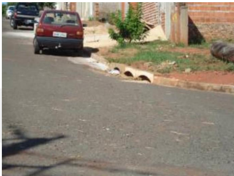
FIGURA 187 – Bocas de lobo parcialmente obstruída por folhas e galhos na esquina da Rua Fernando Pessoa
