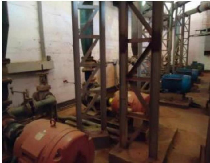
FIGURA 48 – Conjunto de seis motobombas do Sistema de Recalque 3
