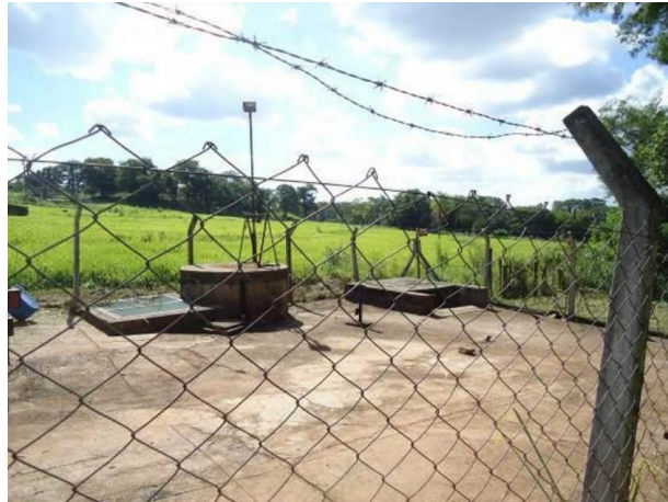
FIGURA 94 – Poço de sucção onde estão instaladas as bombas submersíveis da EEE5
