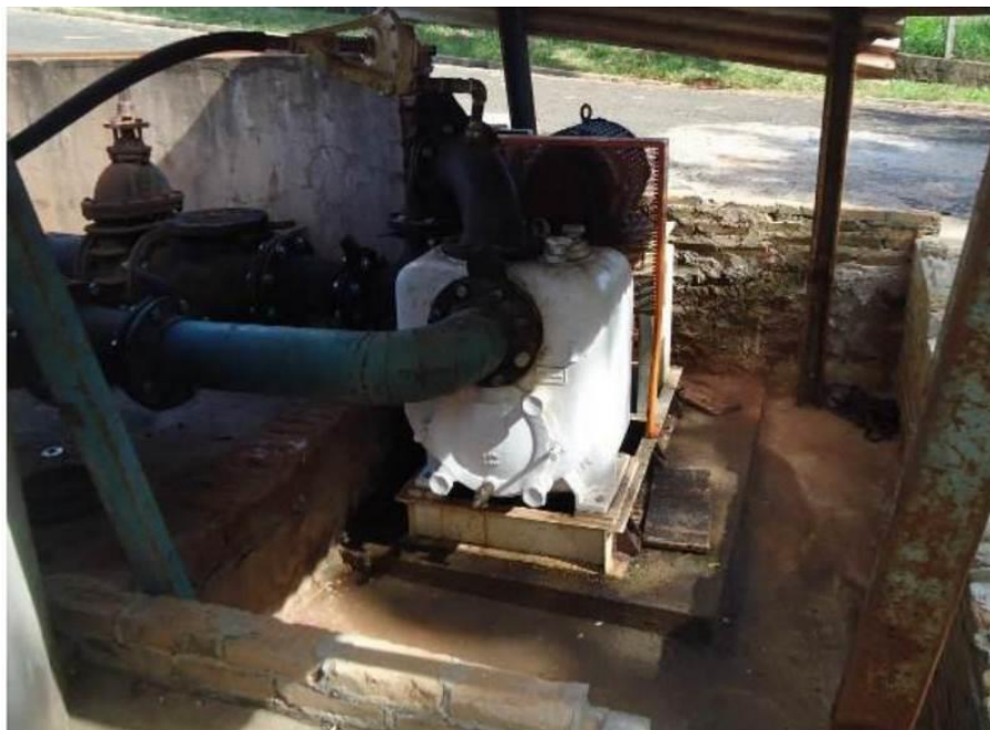
FIGURA 100 – Conjunto moto bomba Imbil da EEE 4
