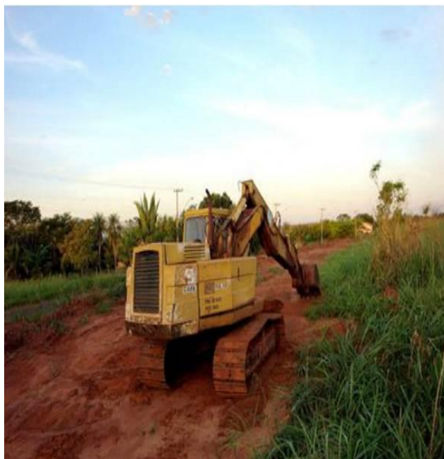
FIGURA 121 – Esteira de escavadeira do DAE auxiliando nas obras de saneamento do Jd. Morada do Sol
