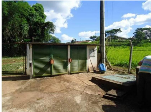
FIGURA 92 – Painel de energização e comando da EEE5
