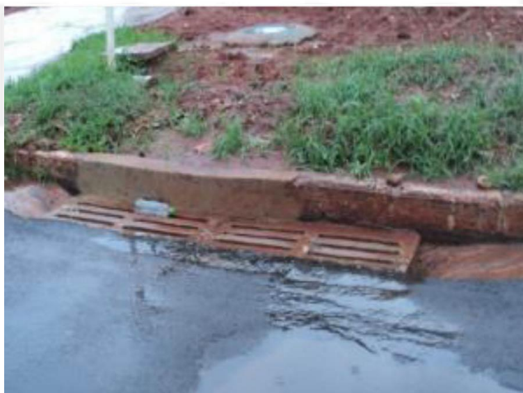
FIGURA 159 – Nova boca de lobo instalada na rotatória de entrada da cidade, Avenida Brasil Sul com a Avenida Atlântica
