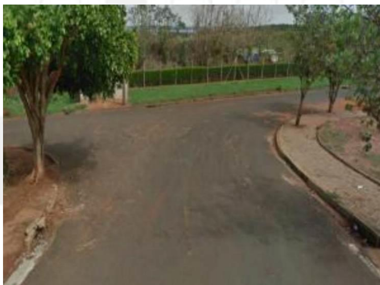
FIGURA 155 – Bocas de lobo na Alameda 2 esquina com a Alameda 3
