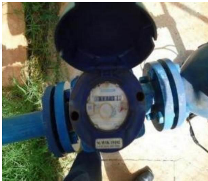
FIGURA 72 – Hidrômetro para macromedição no poço de captação de água no sistema Lote 76
