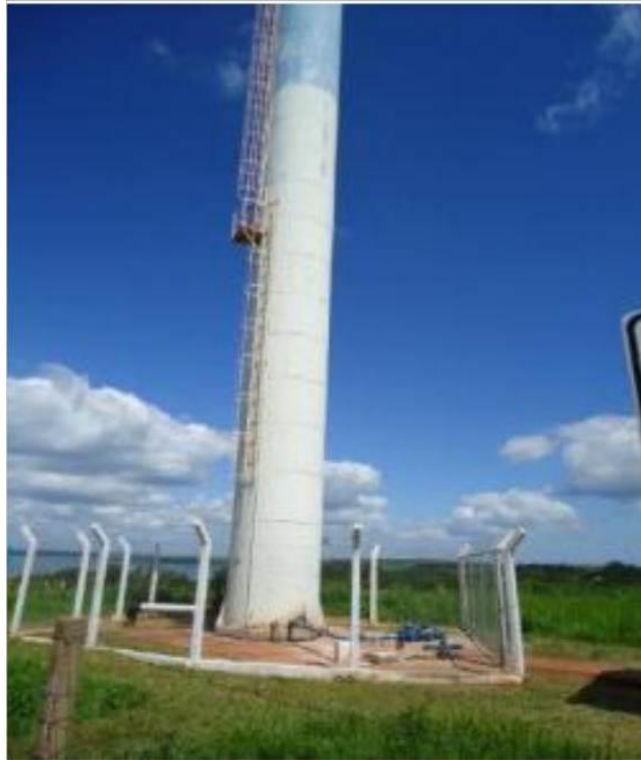
FIGURA 68 – Reservatório de água potável no Recanto das Águas
