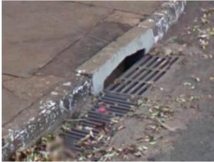
FIGURA 138 – Captação de água pluvial por meio de boca de lobo com grelhas
