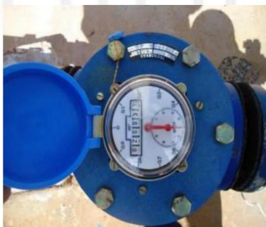
FIGURA 65 – Hidrômetro para macromedição no poço de captação de água do Recanto das Águas
