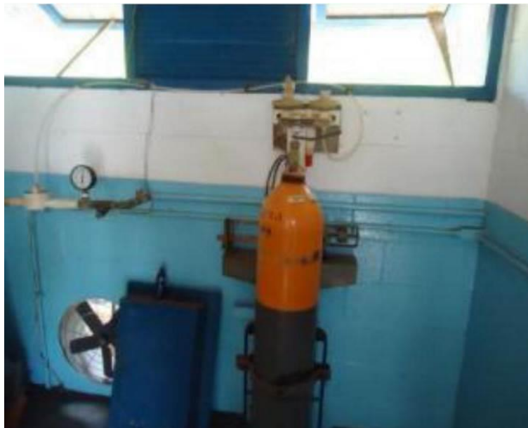
FIGURA 46 – Cilindro de cloro gasoso para a cloração da água
