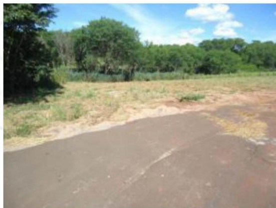
FIGURA 189 – Acúmulo de sedimentos em ponto de cota baixa do loteamento Nova Ilha - Esquina Rua Eça de Queiroz e Rua Jorge de Lima
