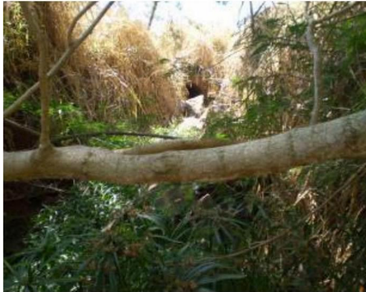
FIGURA 127 – Vista parcial do trecho inicial da Erosão a Avenida Atlântica e trecho da Rodovia SP-596, na área da Horta Comunitária, em detalhe o grau de destruição desse processo erosivo e ao fundo, galeria tubular
