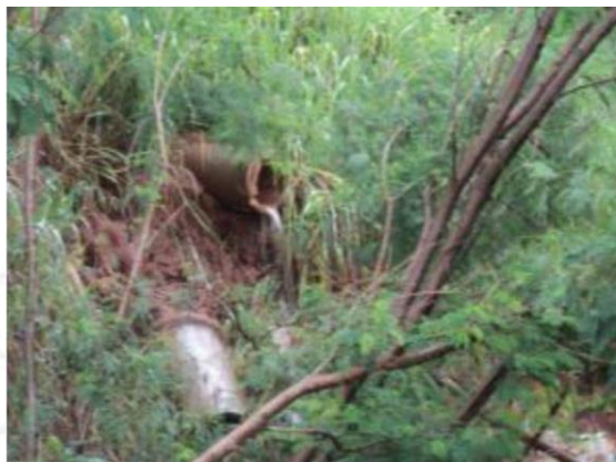
FIGURA 182 – Ponto de lançamento de águas pluviais a montante da travessia da Avenida Quinze de Novembro, com escorregamento da tubulação
