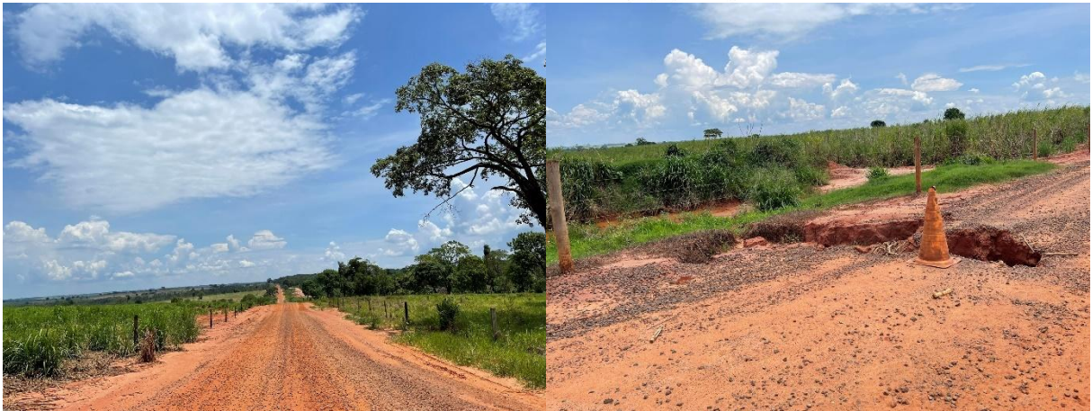
Figura 65 – JAL-168, processo erosivo na estrada.
