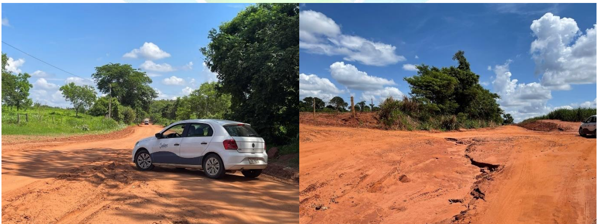
Figura 20 - Trecho Inicial da estrada e processo erosivo na estrada.
