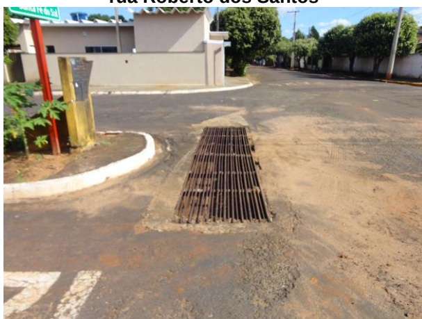
Foto 6.3 – Grelha transversal na avenida Brasil
