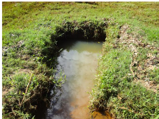
Foto 6.6 - Dissipação da rede de galerias pluviais na margem da rodovia municipal 37
