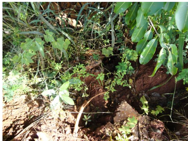
Foto 6.8 - Ponto de erosão causado pela dissipação da avenida Sete de Setembro
