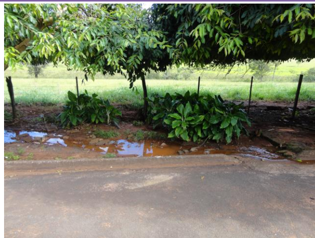
Ponto de alagamento
