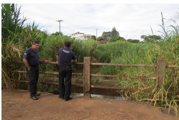
FOTO 63. Vista da drenagem que provoca as inundações em trecho do rua Padre Anchieta.
