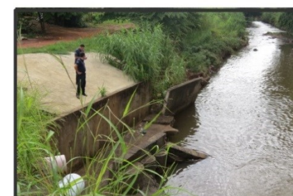
Vista das obras de contenção, localizadas nas proximidades da ponte, que apresentam problemas estruturais.
