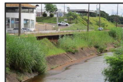
Vista da margem esquerda do ribeirão do Ouro, com destaque para erosão que afeta o calçamento da avenida.
