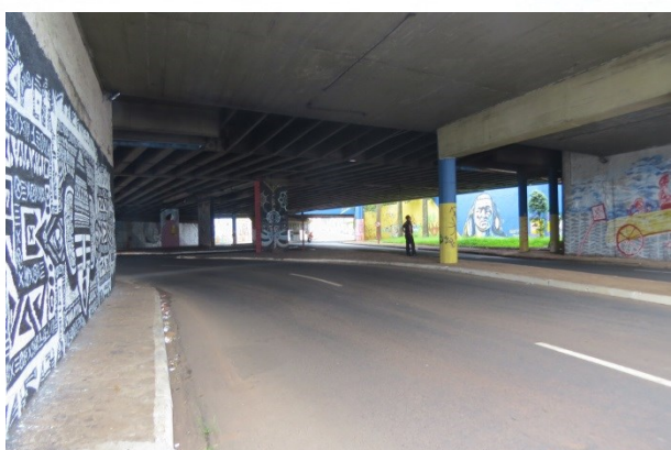
FOTO 41. Vista do trecho afetado por inundações do córrego da Servidão, próximo ao Terminal de Integração de ônibus.
