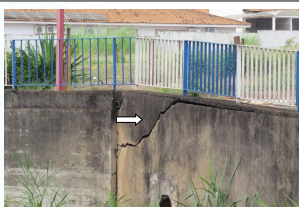
FOTO 46. Vista detalhe da FOTO 45, referente a uma trinca indetificada próxima à cabeceira da ponte.
