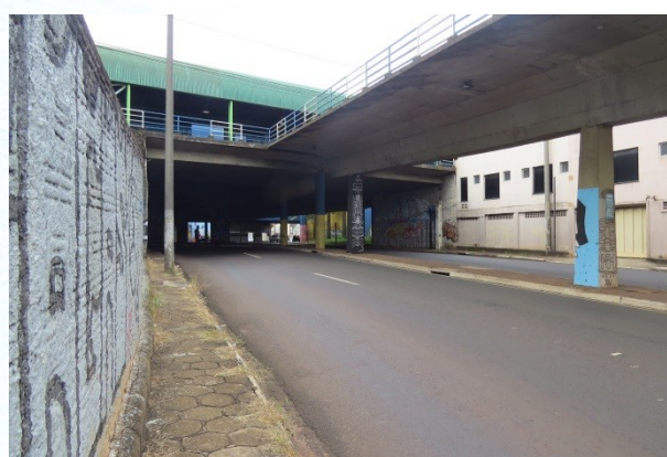
FOTO 40. Vista de trecho intensamente afetado por inundações do córrego das Servidão.
