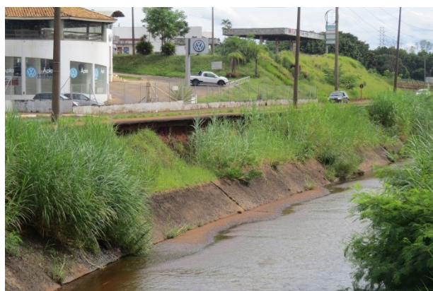
FOTO 49. Vista da margem esquerda do ribeirão do Ouro, com destaque para erosão que afeta o calçamento da avenida.
