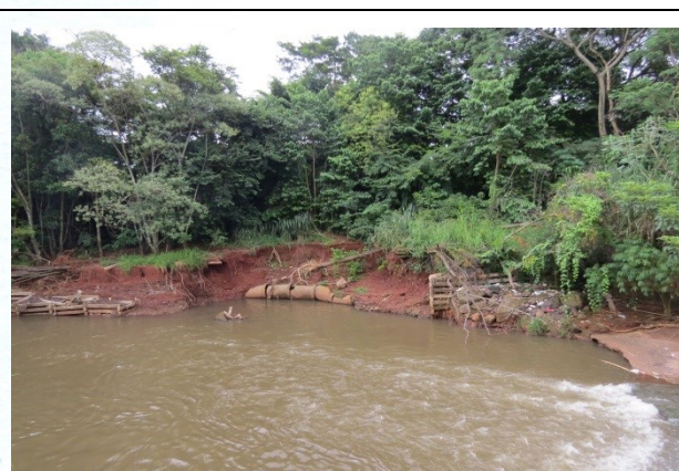
FOTO 32. Registro de solapamento de margens de pequenas dimensões.
