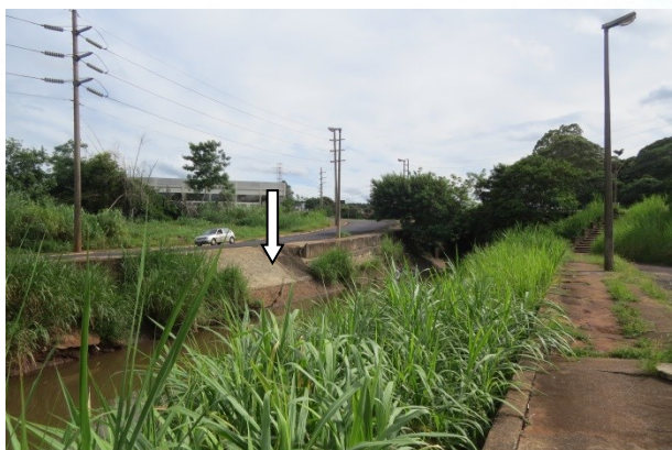
FOTO 57. Vista de estrutura contruída (seta) para acelerar a retirada das águas do sistema viário.
