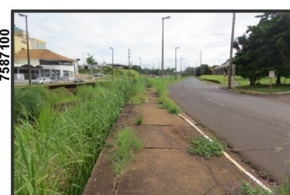
Vista geral de trecho da margem direita o qual apresenta uma série de fissuras e rachaduras.
