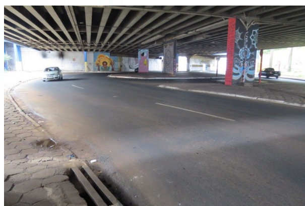
FOTO 42. Vista do sistema viário afetado por inundações do córrego. As águas podem atingir cerca de 1,5 m de altura.
