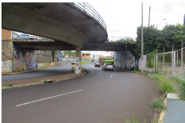
FOTO 37. Vista da área muito afetada por inundações do córrego da Servidão, canalizado. Segundo dados da COMPDEC os eventos de inundação podem atingir até 2 m de altura.
