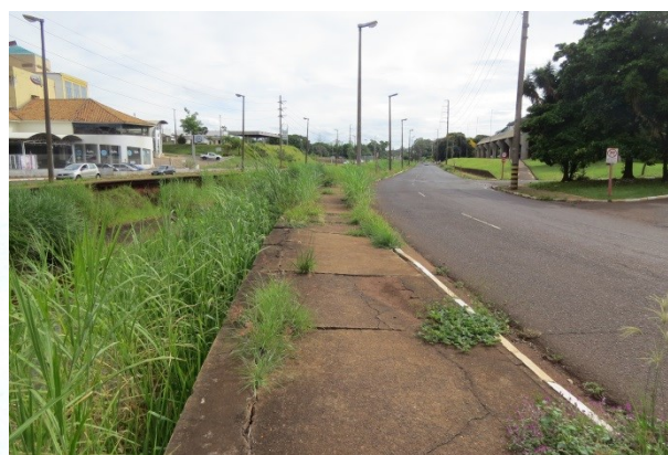
FOTO 50. Vista geral de trecho da margem direita o qual apresenta uma série de fissuras e rachaduras.
