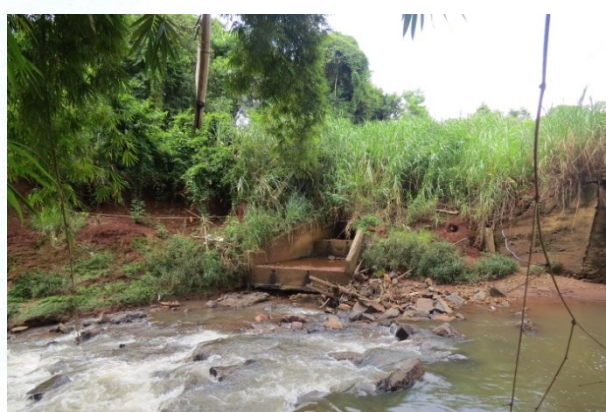
FOTO 20. Vista de sistema de drenagem localizado na margem direita do córrego do Ouro (coleta as águas da estrada). Notar condições estruturais do sistema.
