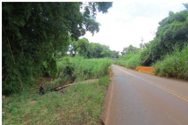
FOTO 17. Vista geral de trecho da estrada Abílio Augusto Corrêa em local afetado por inundações e solapamento de margem (afetando a cabeceira da ponte). Trata-se de área de travessia do córrego do Ouro.
