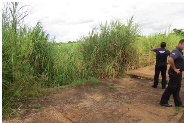
FOTO 65. Vista de trecho afetado pelas inundações do ribeirão do Ouro (cabeceira direita da ponte) e no qual há processo erosivo em evolução.
