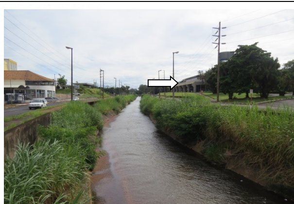
FOTO 48. Vista geral do ribeirão do Ouro, nas proximidades da Rodoviária (seta). Notar dimensões da drenagem (altura da margem e largura). As inundações afetam as duas pistas da avenida.
