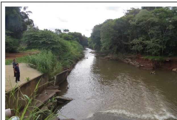
FOTO 33. Vista, de montante para jusante, do córrego. Notar dimensões (largura e altura das margens) e contenções laterais que apresentam problemas (ver FOTO 34).
