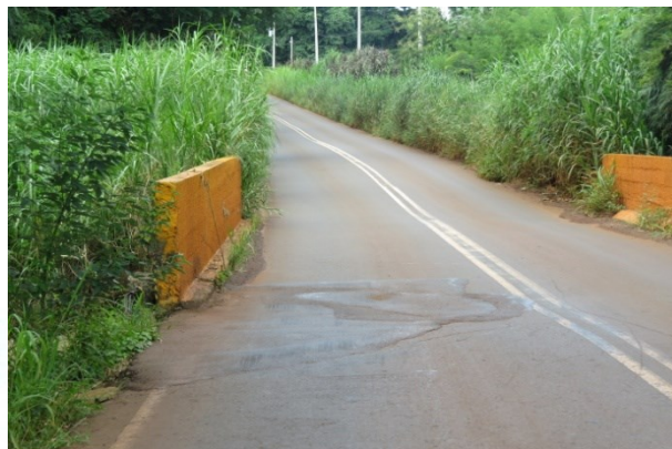
FOTO 18. Registro de feições de movimentações que afetam o pavimento da estrada Abílio Augusto Corrêa.
