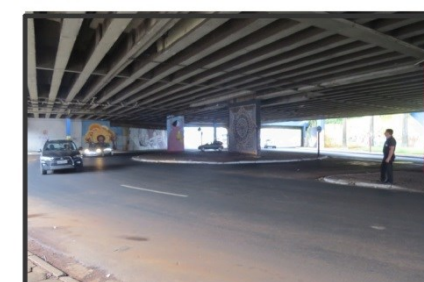
Vista geral de trecho afetado por inundações.
