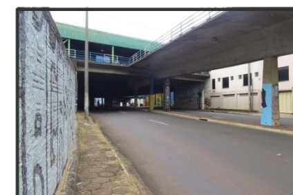
Vista de trecho intensamente afetado por inundações do córrego das Servidão. O córrego encontra-se canalizado neste trecho.
