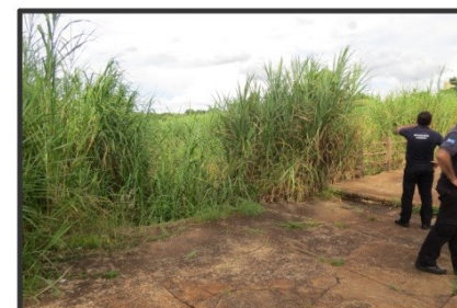
Vista de trecho afetado pelas inundações do ribeirão do Ouro (cabeceira direita da ponte) e no qual há processo erosivo em evolução.
