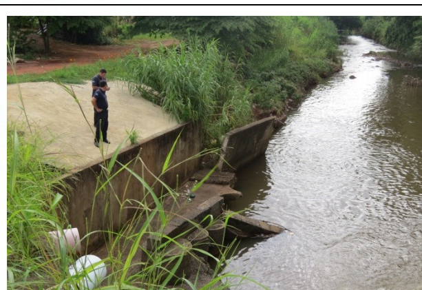
FOTO 34. Vista das obras de contenção, localizadas nas proximidades da ponte, que apresentam problemas estruturais.
