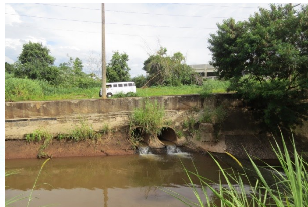
FOTO 56. Vista de tubulações que canalizam águas de afluente da margem esquerda do ribeirão do Ouro.
