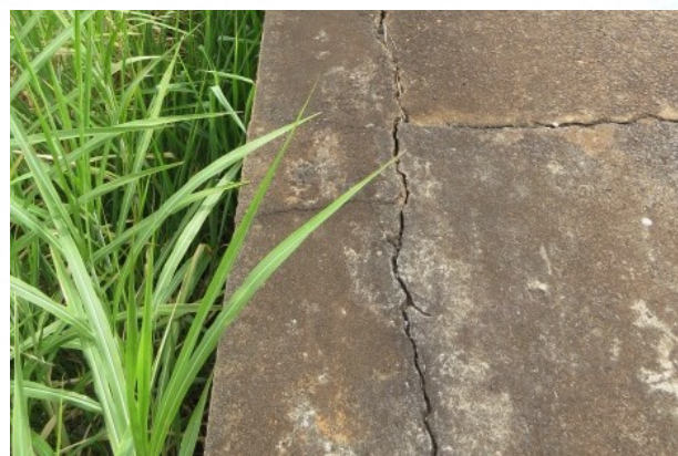
FOTO 51. Detalhe da Foto 50, das fissuras presentes no calçamento da avenida, localizados na margem direita do córrego.
