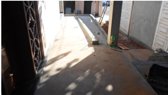
Execução de rampa de acesso e ajuste do layout do muro da fachada, execução de acabamen...
