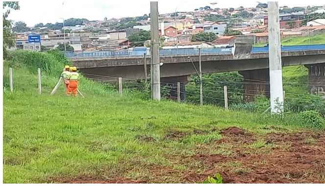
Início de implantação do Canteiro de Obras com a execução da cerca.
