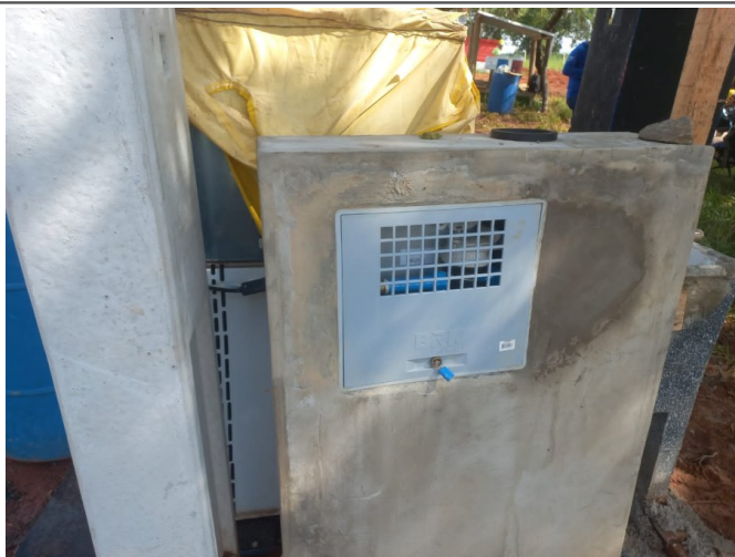
Entrada Provisória de agua e Energia .
