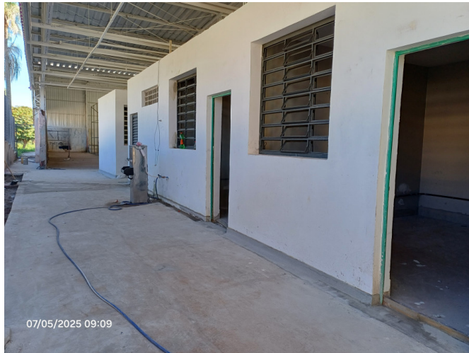
Esquadrias de ferro.
