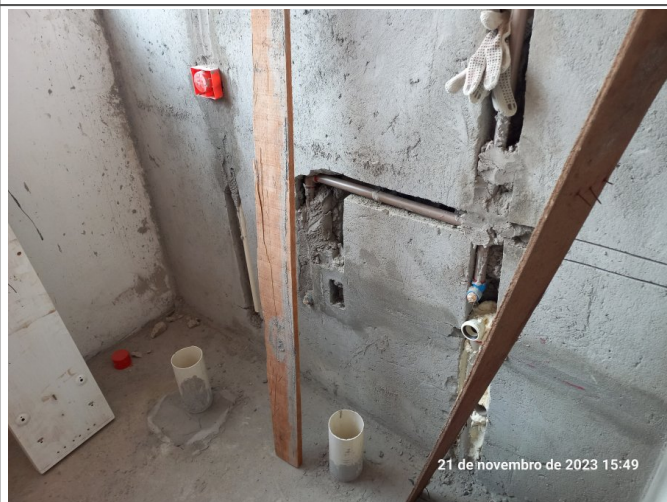
Execução da instalação hidráulica de água fria e esgoto do sanitário PCD de Obras.
