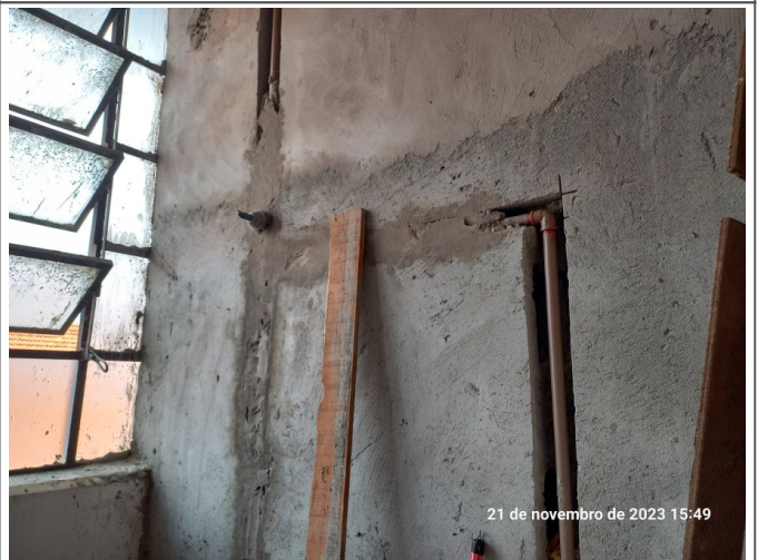
Execução da instalação hidráulica de água fria do sanitário PCD de Obras.
