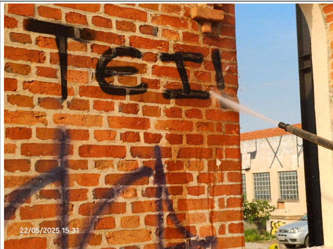
Teste para remoção da pichação com aplicação de produto específico para tal fim.
