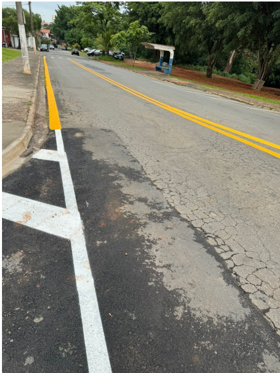
Prolongamento da Rua Placidina Ferreira Braga.: Pavimentação e sinalização de trânsito concluída.
