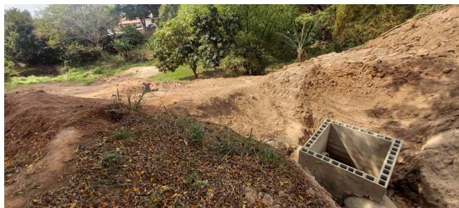
Poço de visita.
