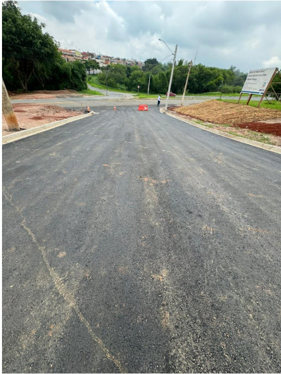
Prolongamento da Rua Placidina Ferreira Braga: Execução da camada de Concreto Asfáltico. (CBUQ).
