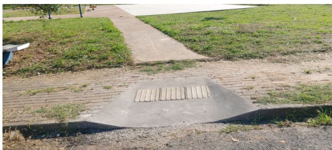
Rua Mário Ferraz x Rua Antonio Salviatti, Jd. Novo Horizonte - Rampa de acessibilidade
