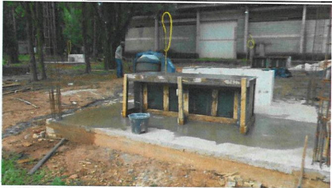
Foram executadas as demolições e limpeza para execução das fundações, estacas e radiers...
