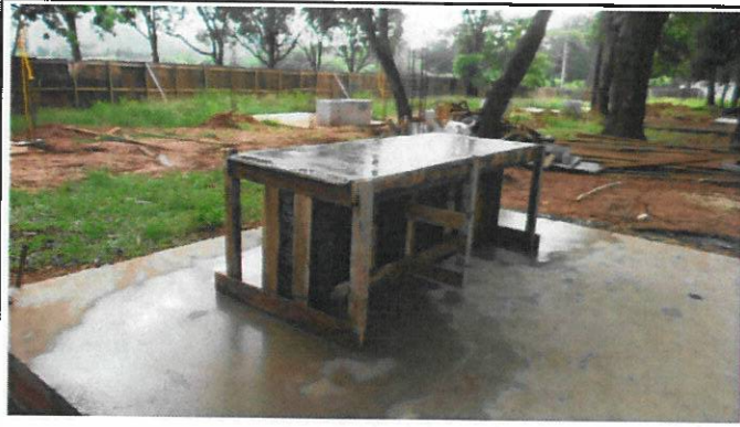
Foram executadas as demolições e limpeza para execução das fundações, estacas e radiers...
