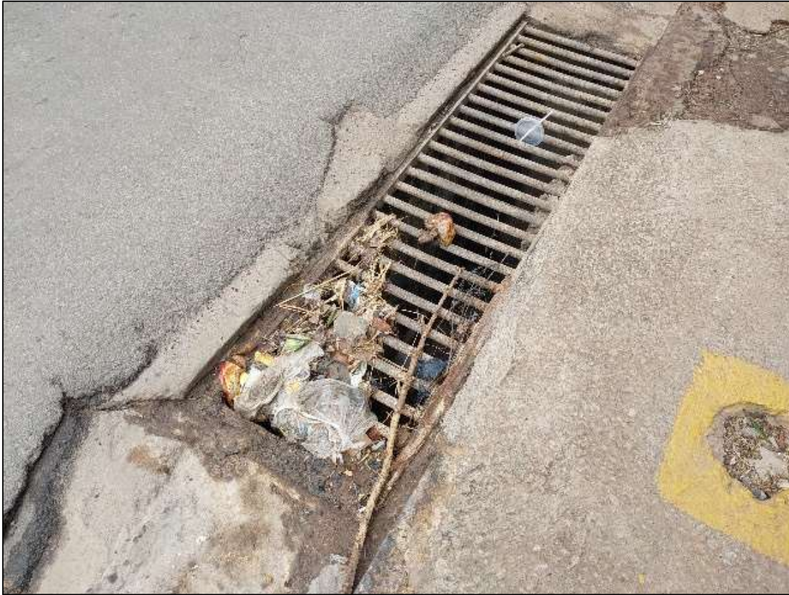
Figura 31 – Presença de resíduos nas bocas coletoras.
