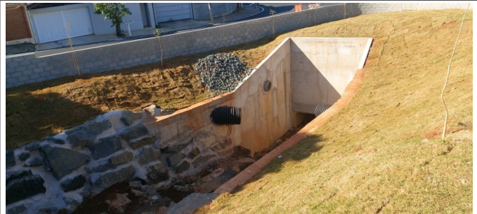
Muro ala jusante, contensão de talude com pedra argamassada e plantio de grama em talude.
