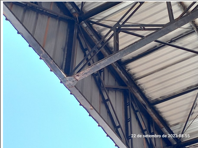
Ponto de ferrugem na estrutura metálica que será recuperada.
