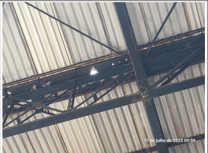
Calha com processo avançado de corrosão necessitando de substituição.
