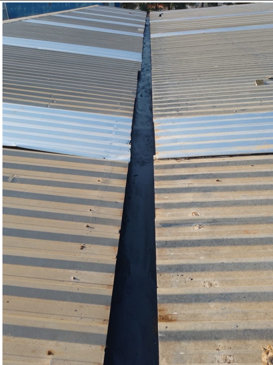
Limpeza e pintura anticorrosiva da calha antiga, para sobreposição de nova calha.
