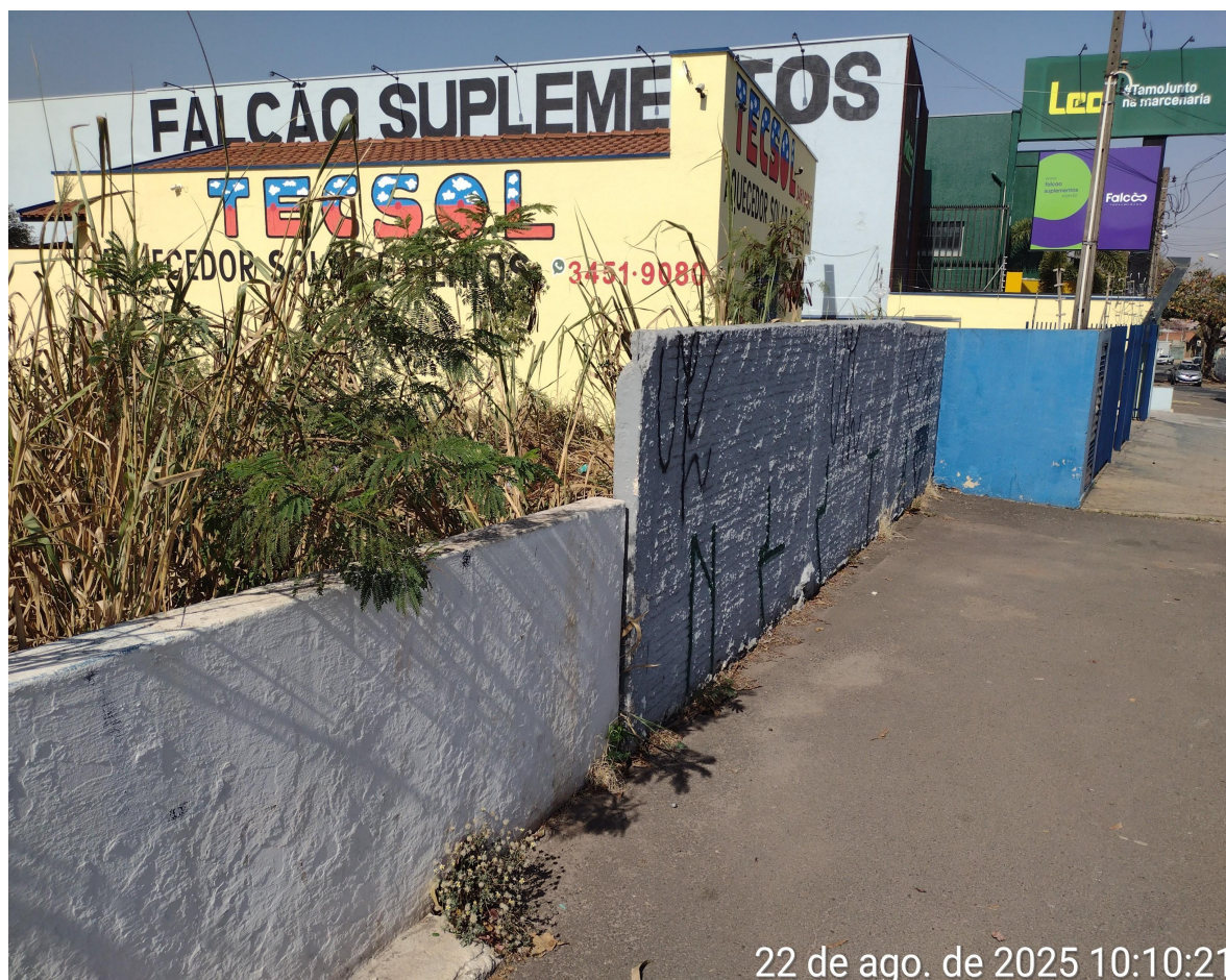
Figura 4: Ausência de sarjeta de concreto
