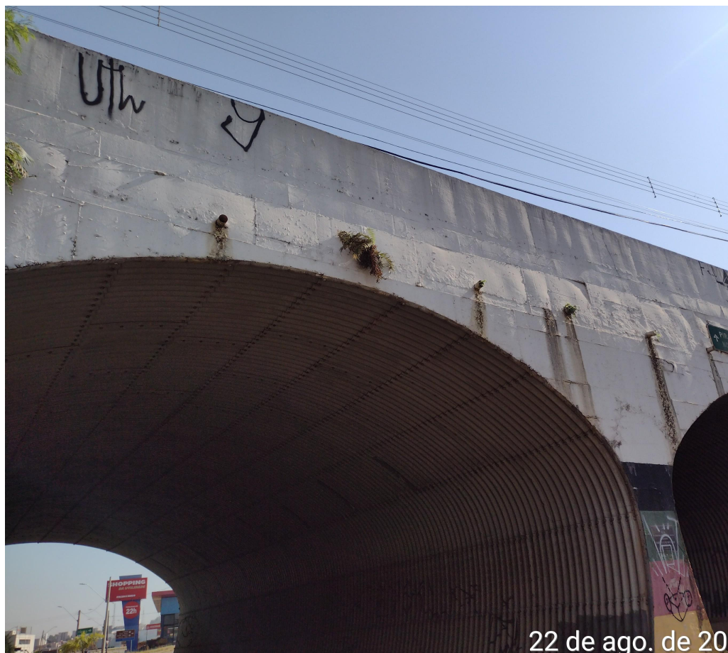
Figura 2: vista anel Viário – entupimento de barbacãs por vegetação, podendo ocasionar infiltrações na estrutura do pavimento
