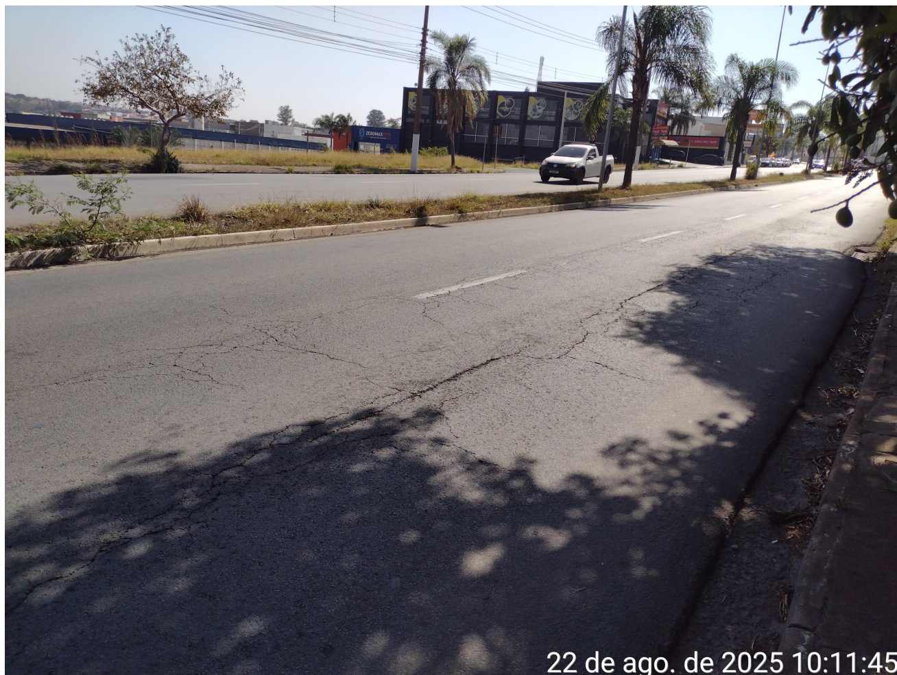
Figura 17: trincas longitudinais nos encontros das emendas do pavimento
