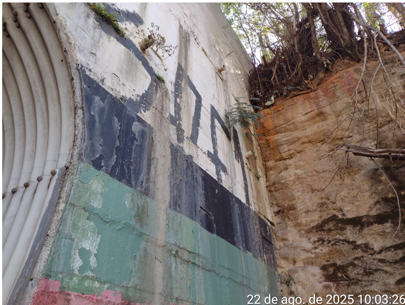
Figura 8: desgaste por ação de intempéries, pintura e infiltração na parede do viaduto
