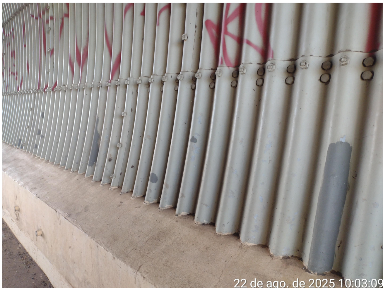
Figura 12: pontos de oxidação do tubo Armco, com sinais de intervenções
