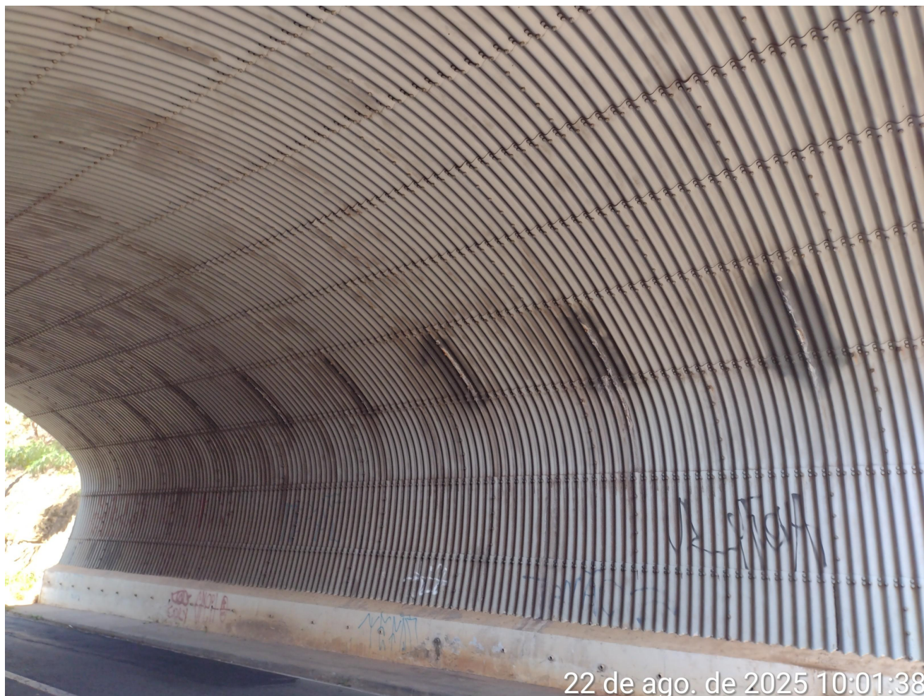
Figura 13: pontos de oxidação do tubo Armco, com sinais de intervenções
