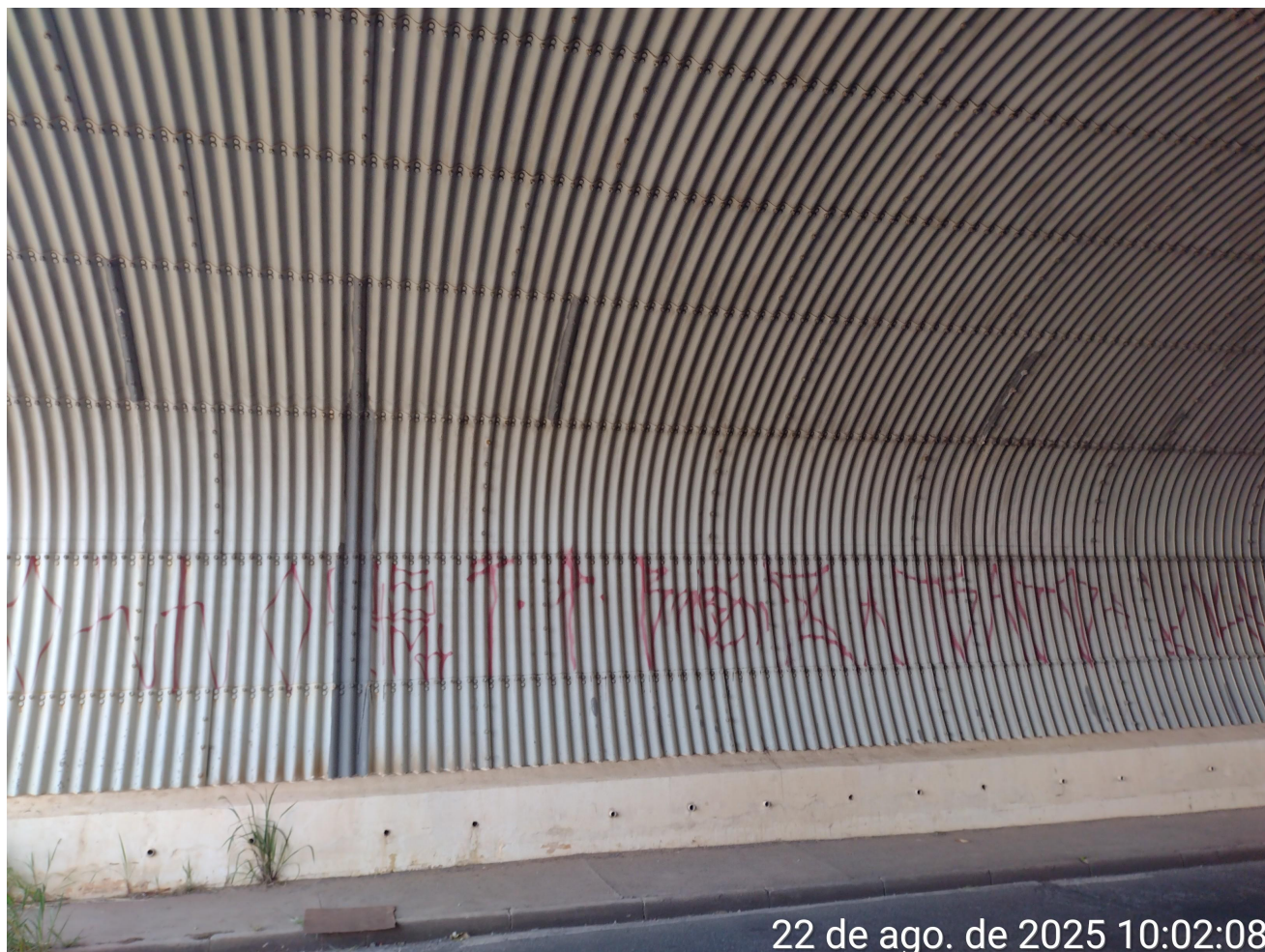
Figura 15: pontos de oxidação do tubo Armco, com sinais de intervenções
