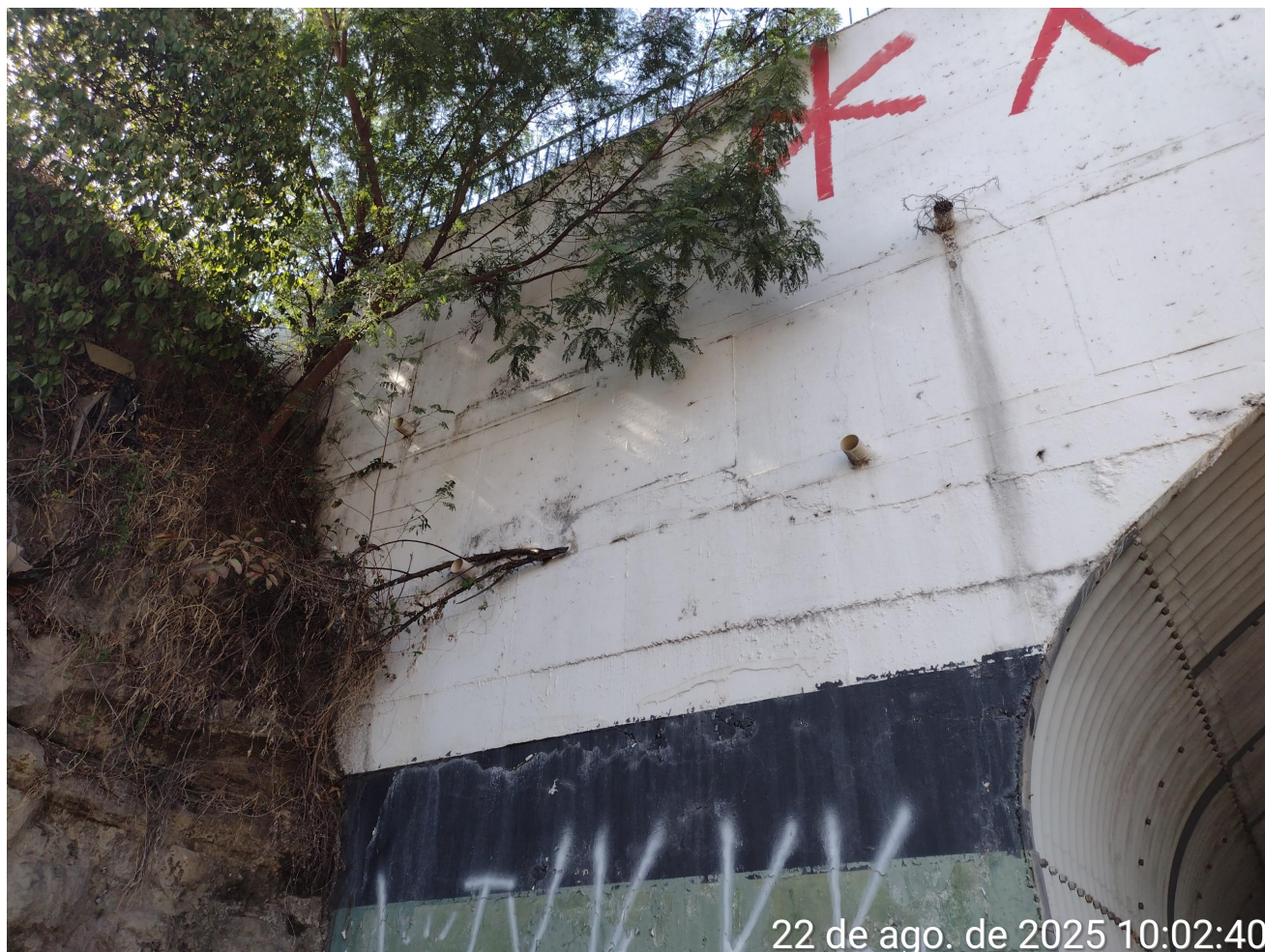
Figura 7: Vegetação crescendo entre maciço rochoso e estrutura do viaduto
