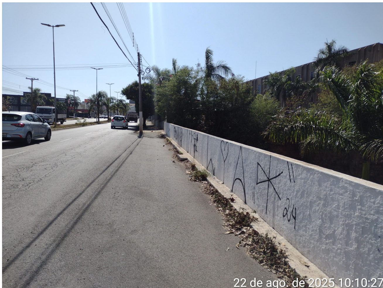
Figura 5: Ausência de sarjeta de concreto
