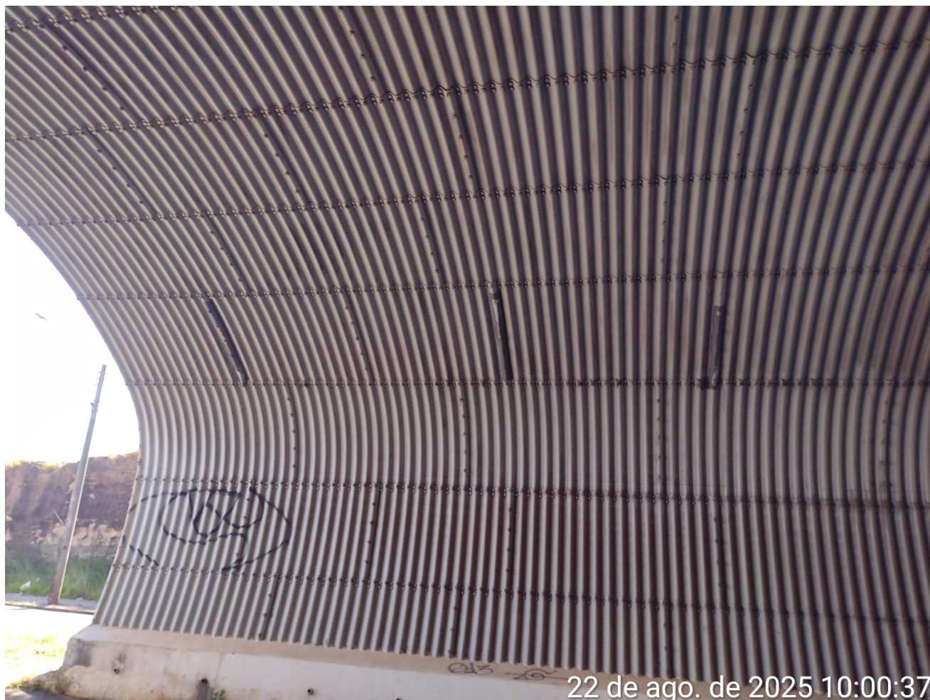
Figura 14: pontos de oxidação do tubo Armco, com sinais de intervenções
