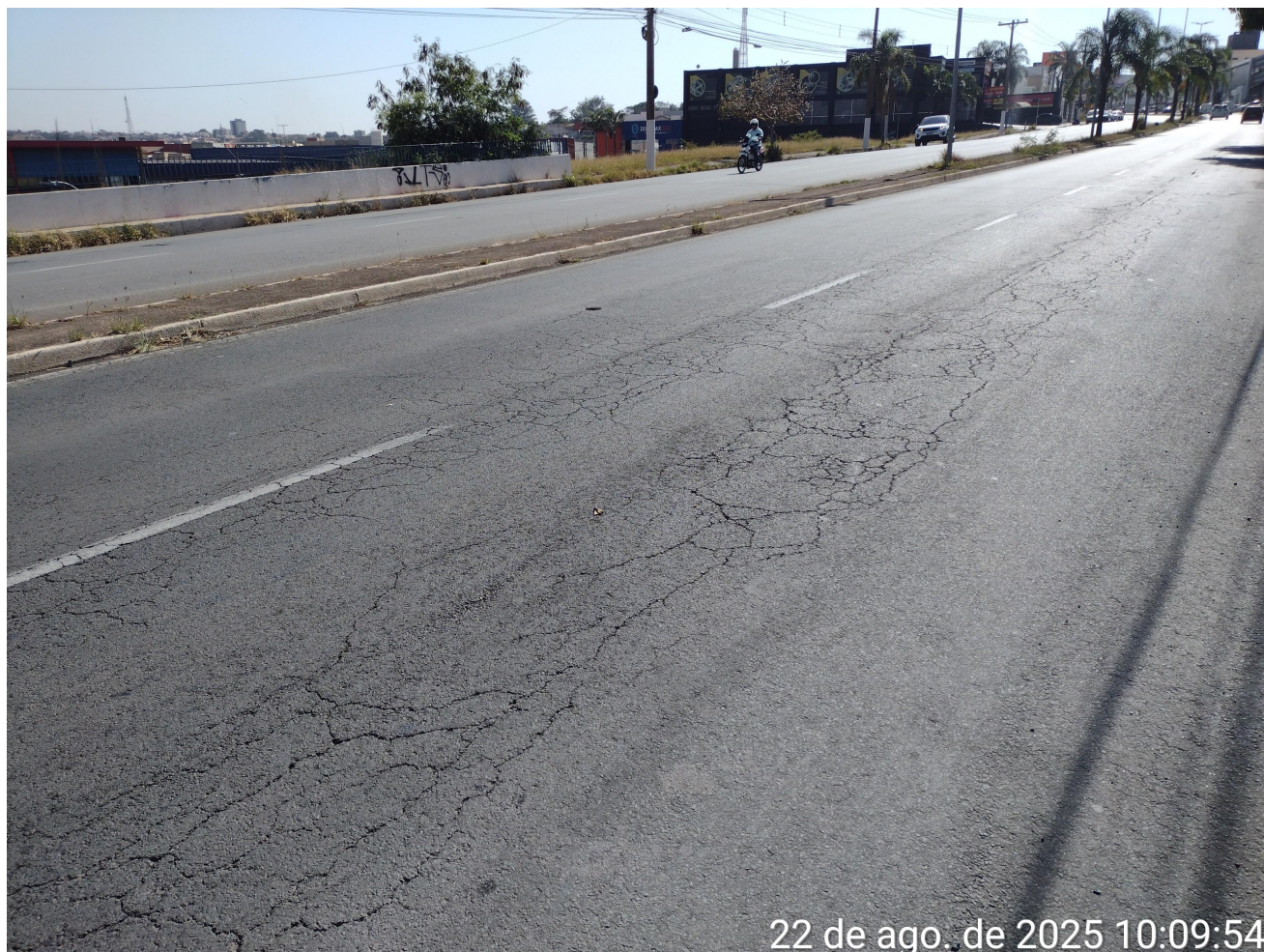
Figura 16: trincas em malha "couro de jacaré" e afundamento de trilha de roda no pavimento
