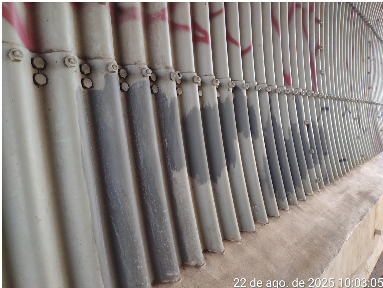
Figura 11: pontos de oxidação do tubo Armco, com sinais de intervenções
