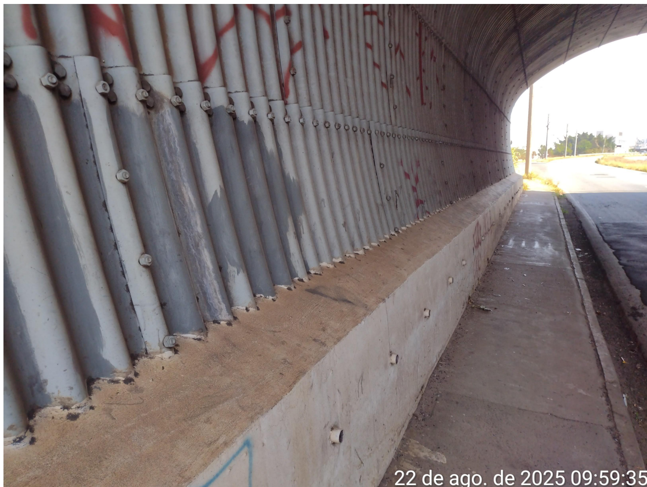
Figura 10: pontos de oxidação do tubo Armco, com sinais de intervenções
