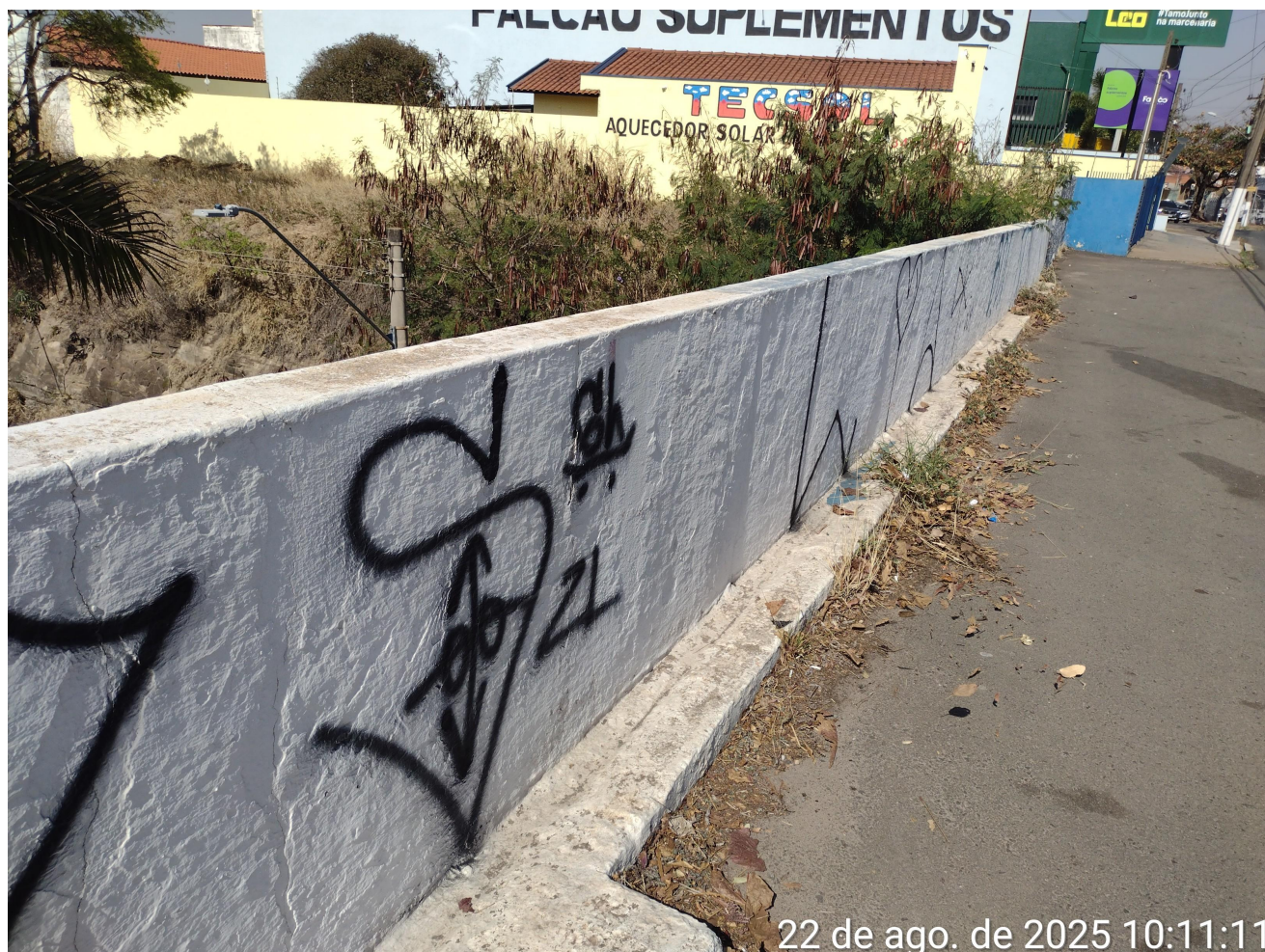
Figura 6: Ausência de sarjeta de concreto
