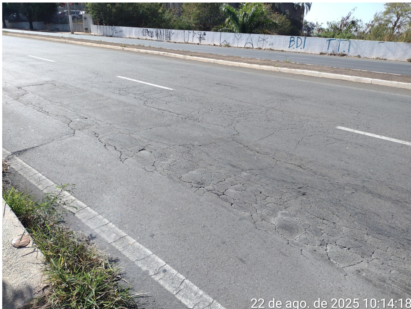
Figura 19: Ausência de juntas de dilatação no pavimento e nos encontros das aproximações
