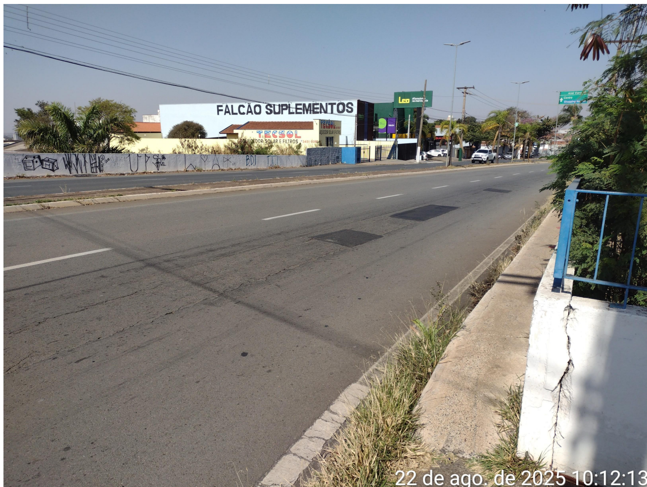
Figura 18: intervenções recentes de "tapa buraco" por surgimento de "panelas"
