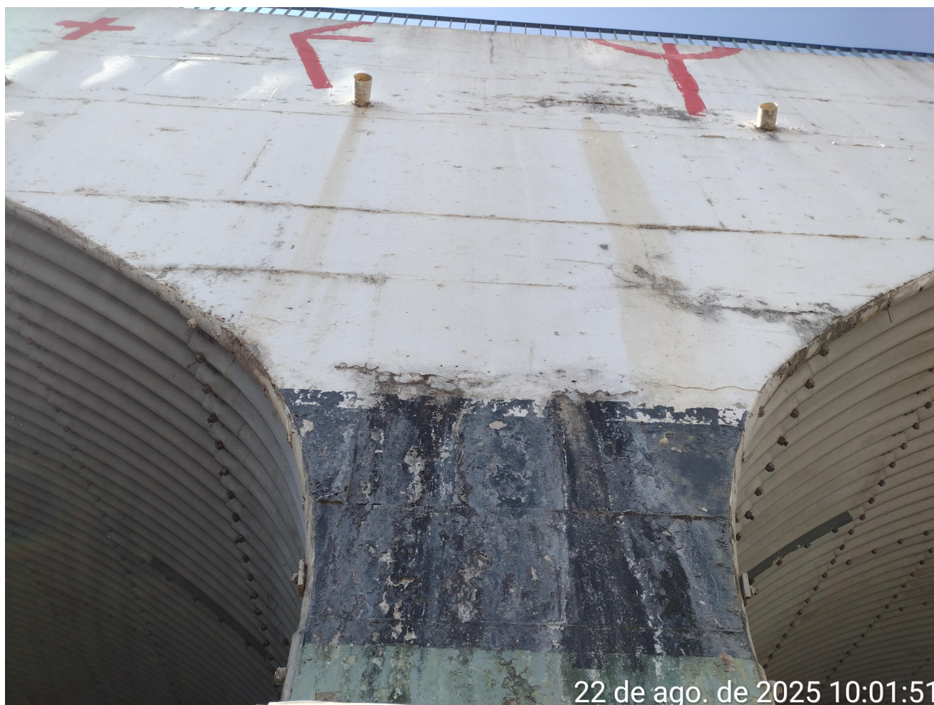
Figura 9: ponto de infiltração
