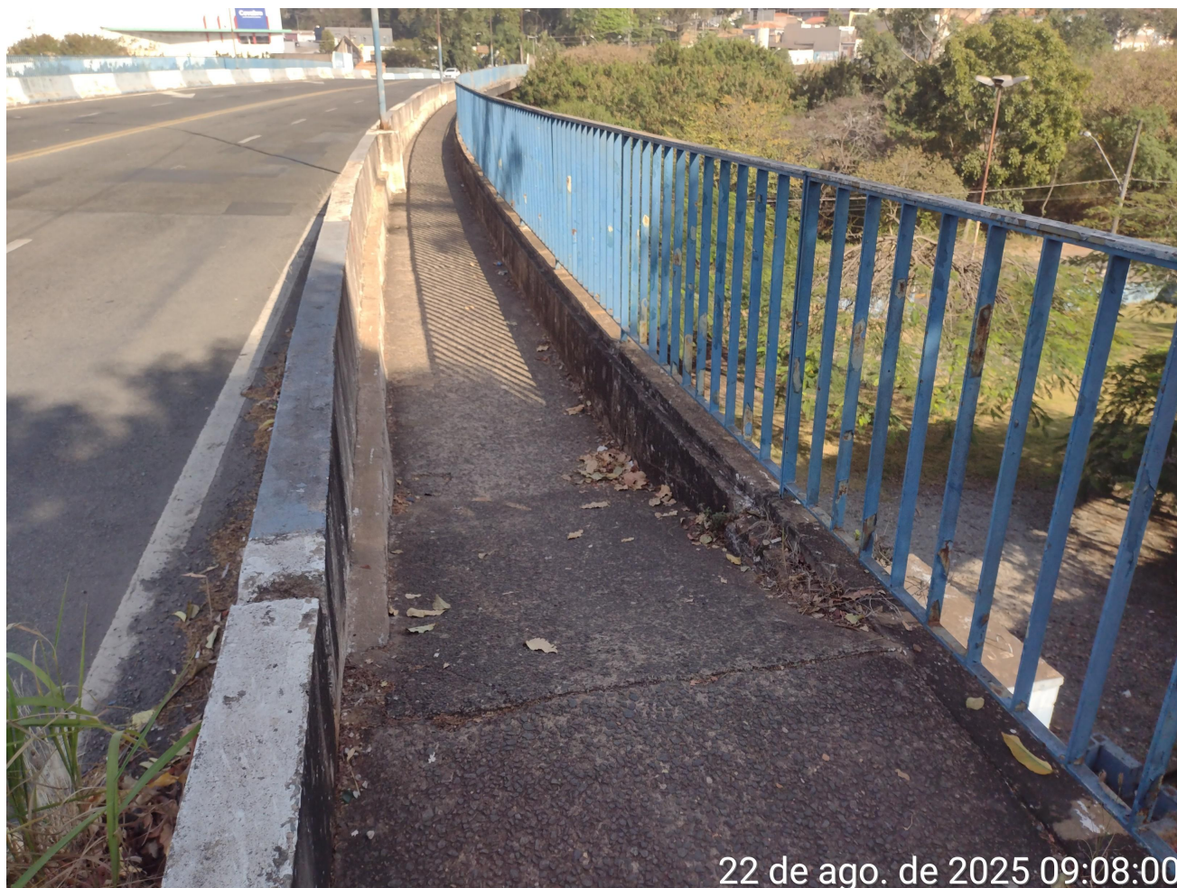
Figura 8 Acessibilidade comprometida (tubulação com cobertura)
