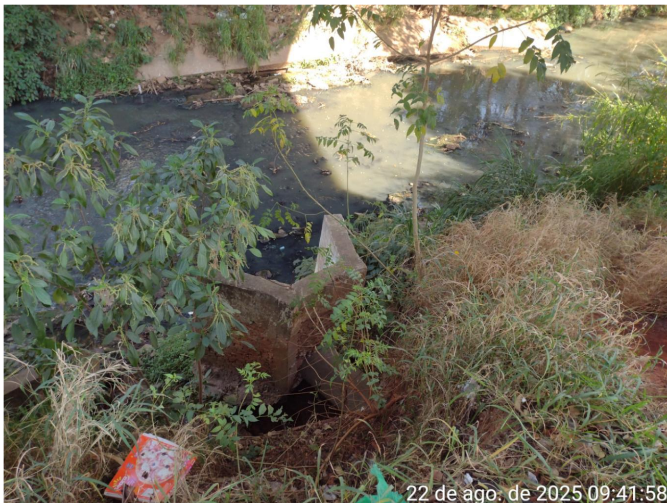
Figura 21 Muro de ala de galeria no Ribeirão Tatu avariada ao lado de um dos pilares.
