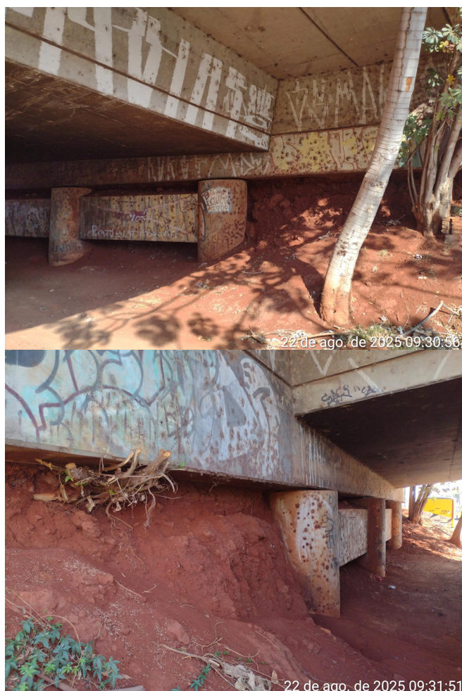
Figura 17: Ausência de contenção na cabeceira do viaduto, ocasionando fuga de material, podendo ocasionar afundamentos do pavimento. Sinais de vegetação crescendo no maciço.
