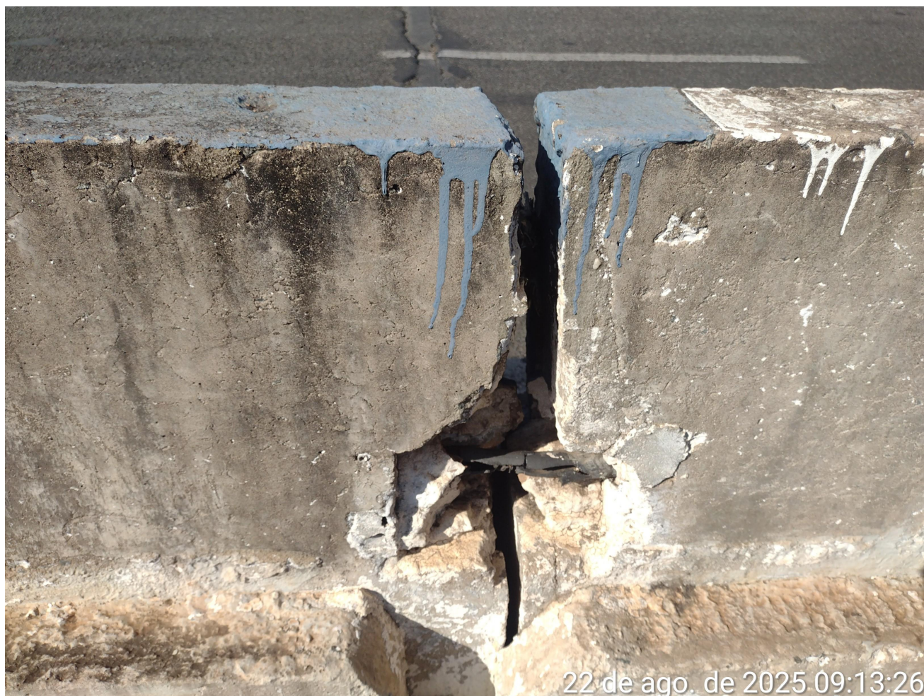
Figura 10 - conduítes e New Jersey danificados
