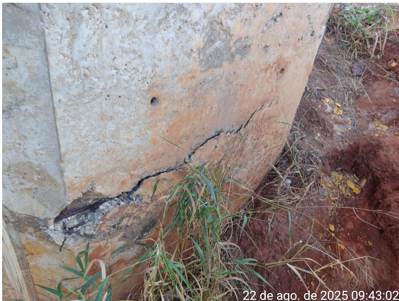
Figura 22 Armadura exposta no pé do pilar às margens do Ribeirão Tatu
