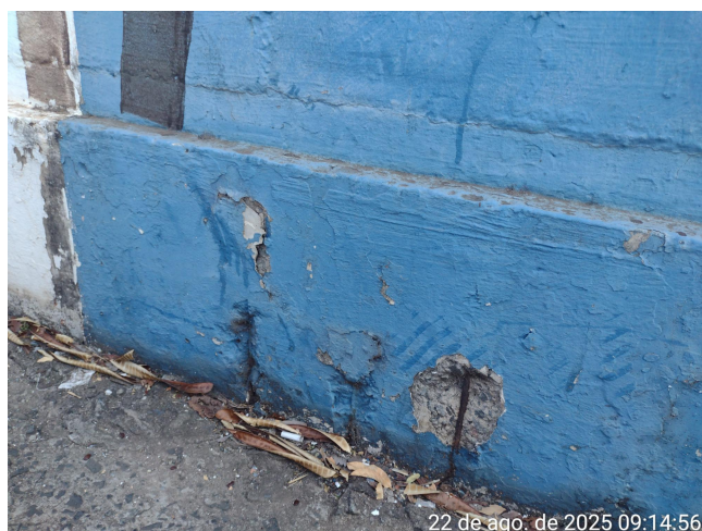
Figura 7 Armaduras expostas nos dispositivos de proteção
