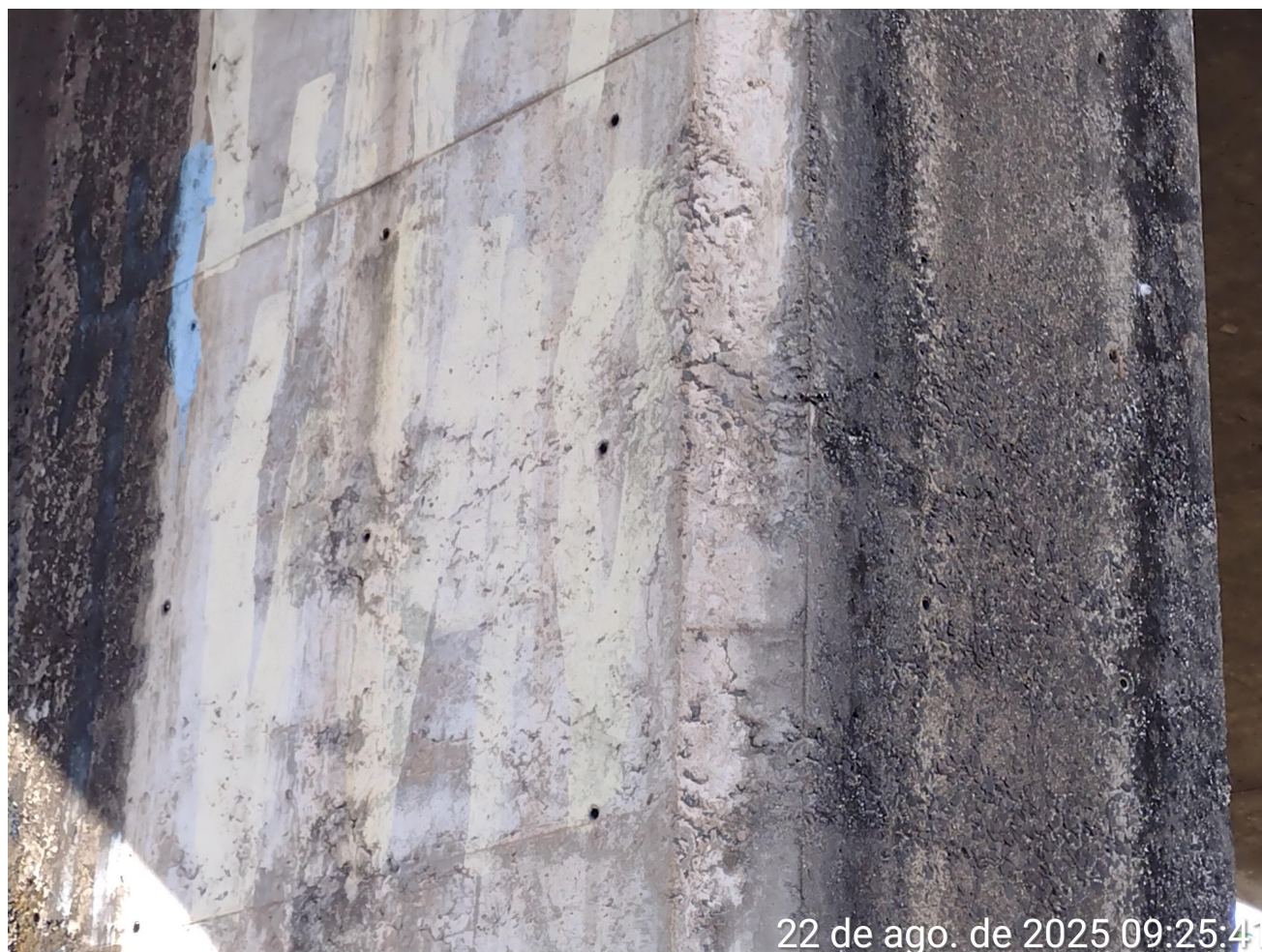
Figura 14 umidade e superfície porosa no pilar do viaduto
