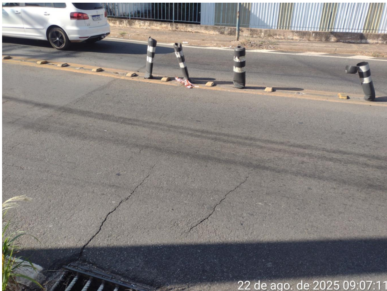
Figura 2 tachões e balizadores danificados, sinalização horizontal desgastada, fissuras em torno dos dispositivos de drenagem.
