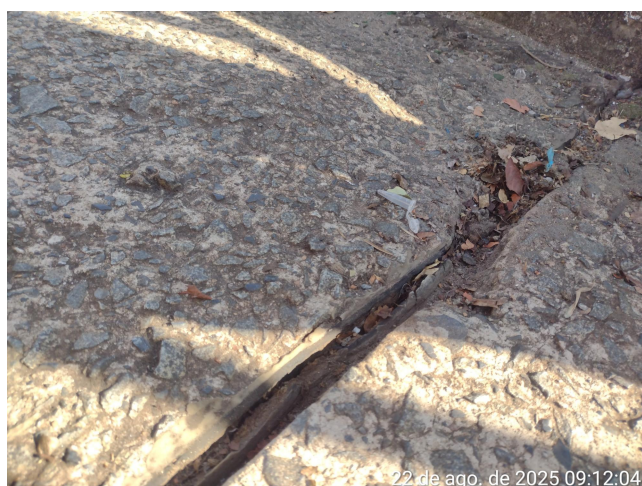
Figura 3 Juntas de dilatação danificadas pelas intempéries
