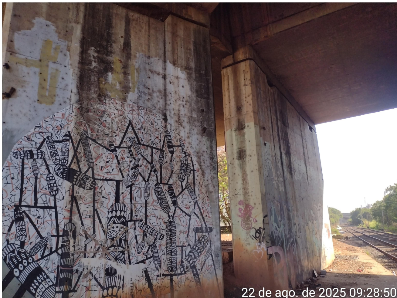
Figura 16: Marcas de umidade nos pilares através das juntas de dilatação
