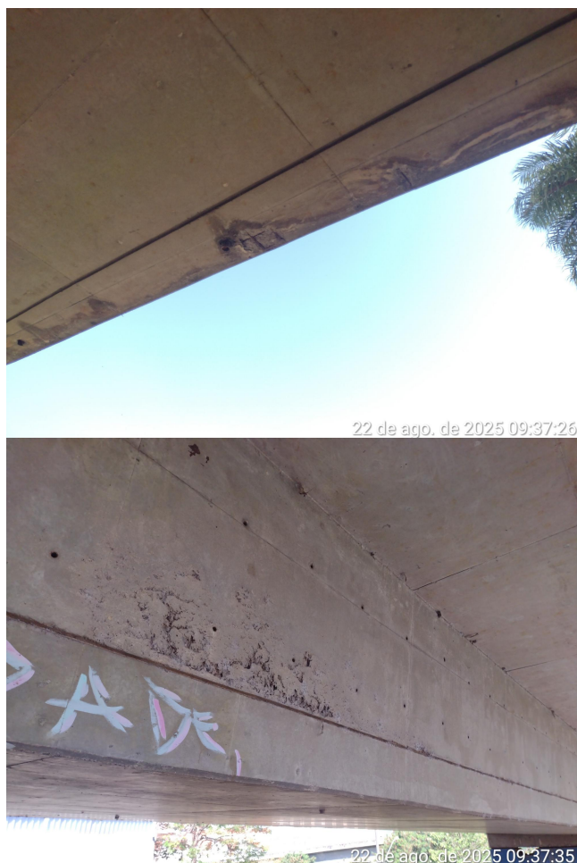
Figura 19 Pontos de armadura exposta e bicheiras
