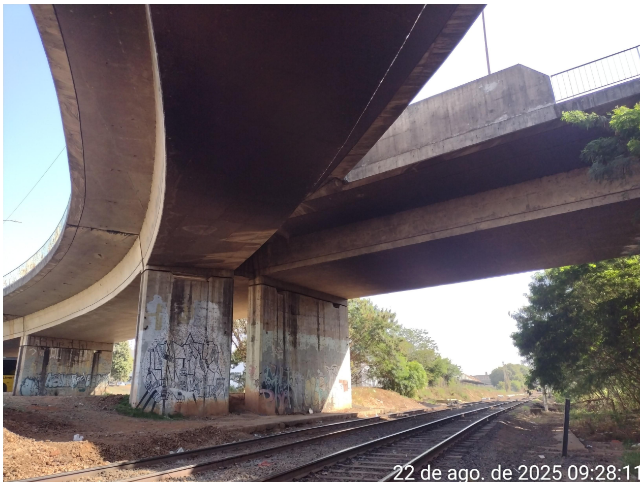
Figura 15: Marcas de fuligem no caixão perdido sobre a ferrovia e vandalismo nos pilares
