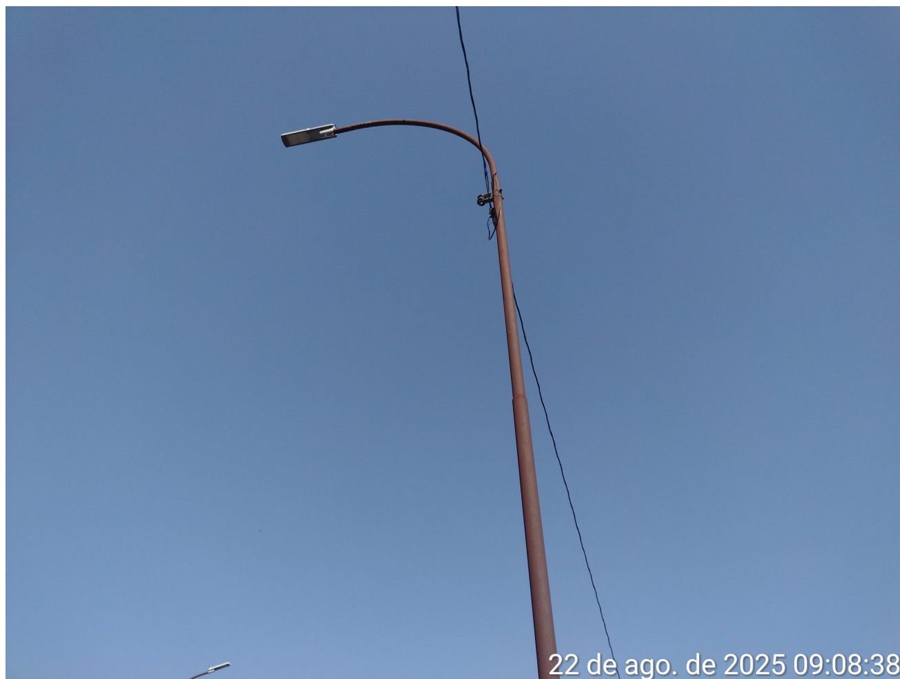
Figura 9 luminária danificada pela ação da intempérie
