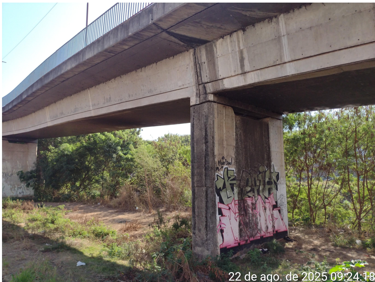
Figura 13 marcas de umidade nos pilares e vandalismo
