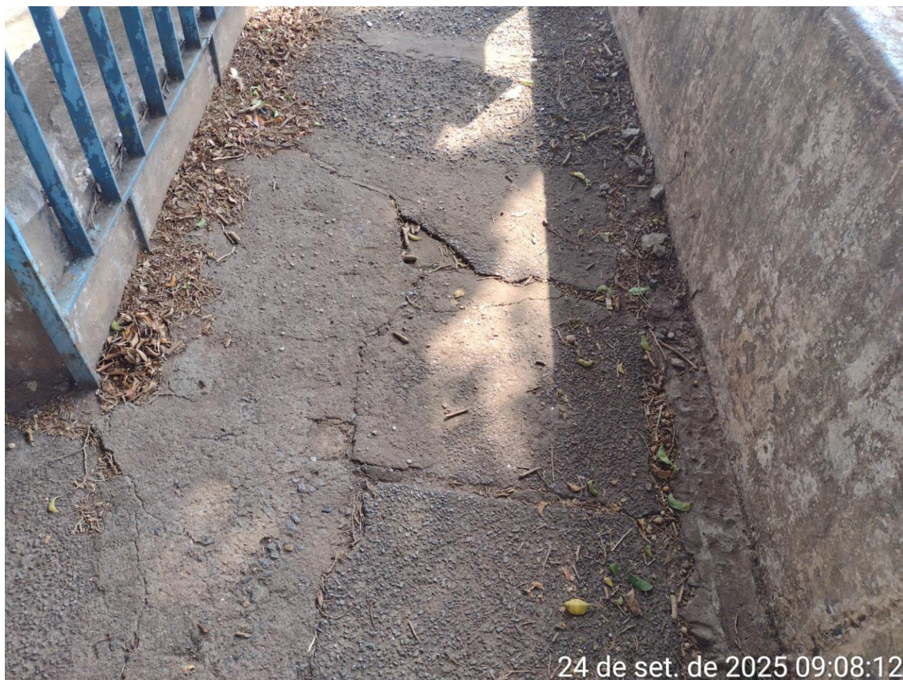
Figura 8 - Fissuras no concreto da calçada
