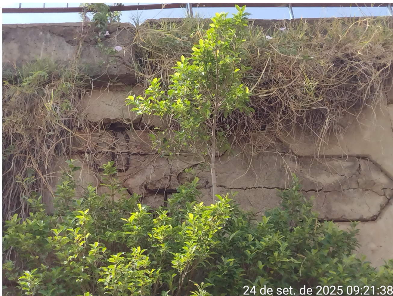
Figura 15 - Exposição de armadura na contenção de talude e crescimento de vegetação
