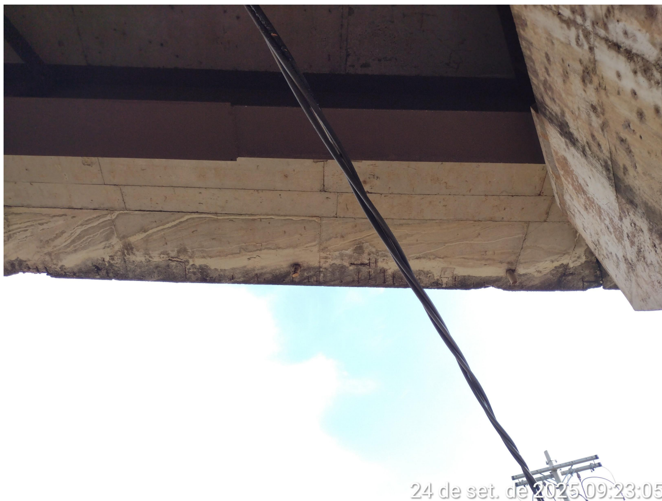
Figura 22 - Armadura exposta ao longo da borda do tabuleiro
