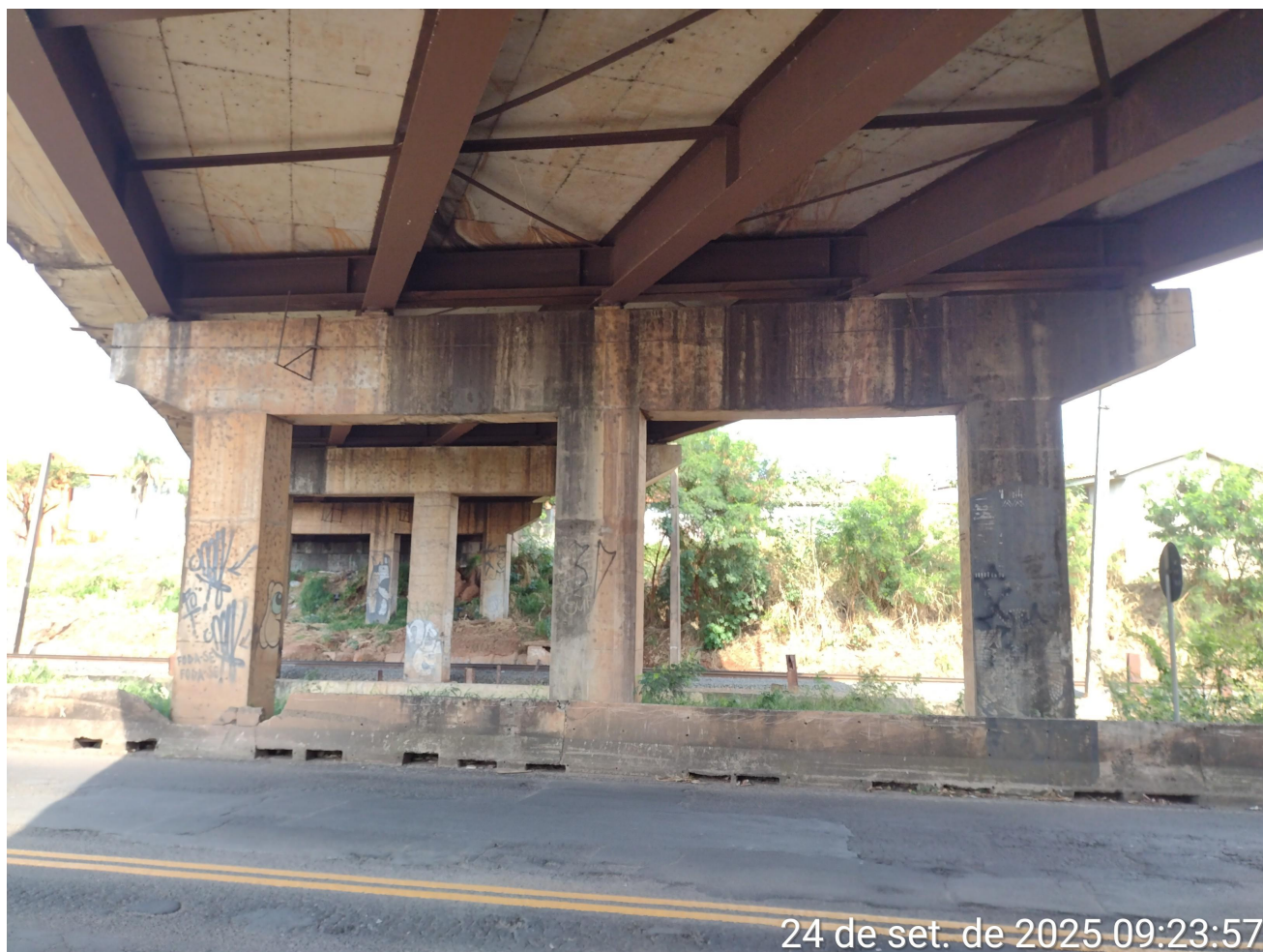
Figura 21 - Pontos de umidade ao longo da estrutura
