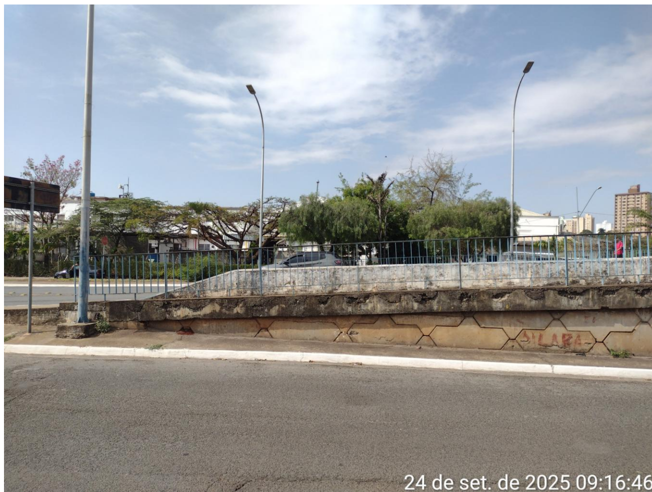
Figura 12 - Exposição de armaduras ao longo de toda mureta de fixação dos gradis
