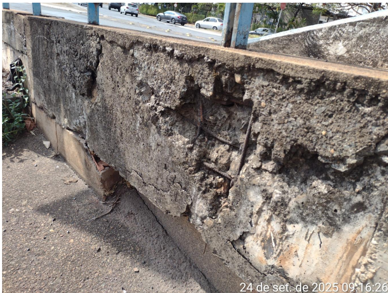
Figura 11 - Mureta de fixação dos gradis com exposição de armaduras
