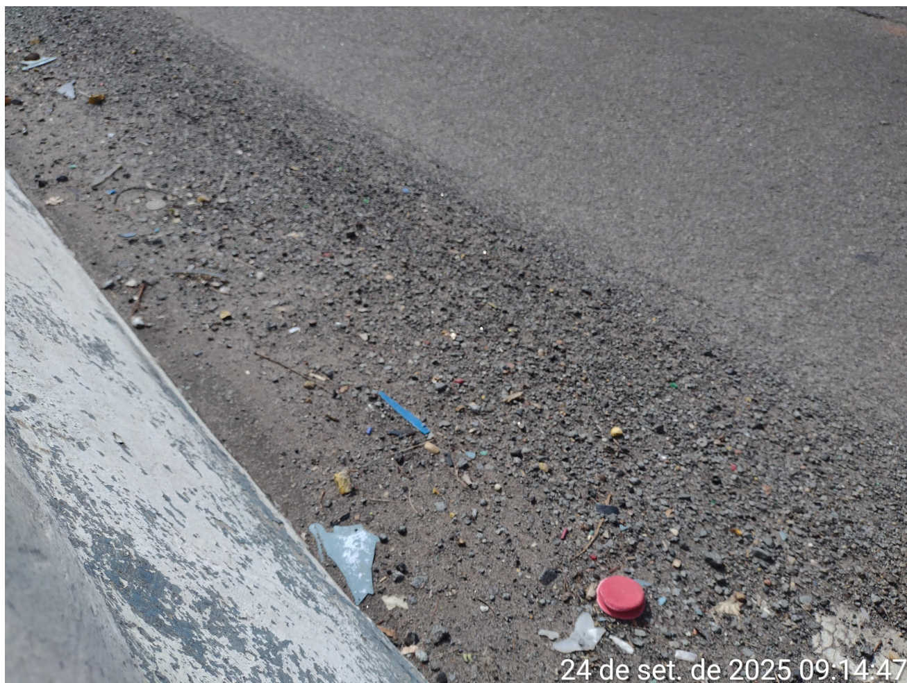
Figura 5 - Pavimento apresentando desagregação
