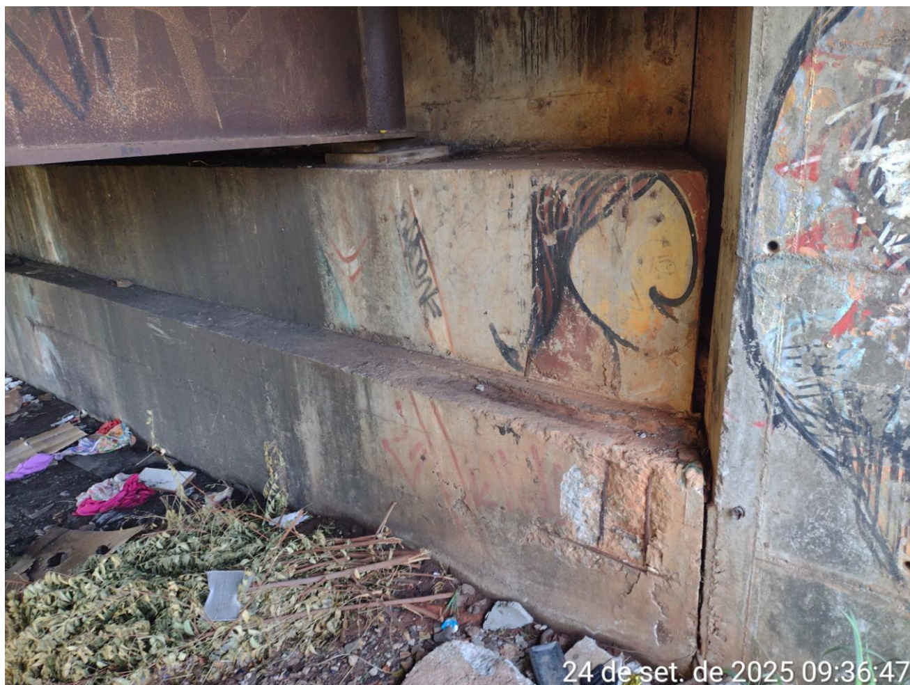
Figura 26 - Pontos na cabeceira com armadura exposta e ações por fogo
