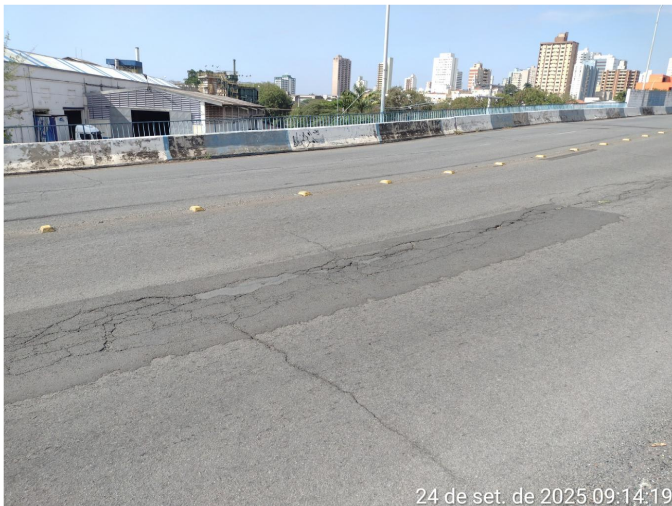
Figura 3 - Pavimento apresentando fissuras tipo couro de jacaré
