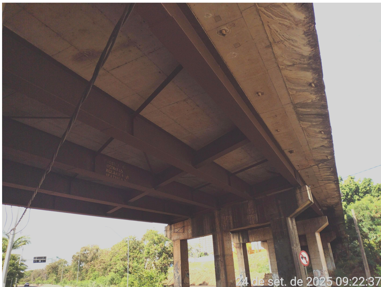
Figura 19 - Pontos de umidade na borda do tabuleiro
