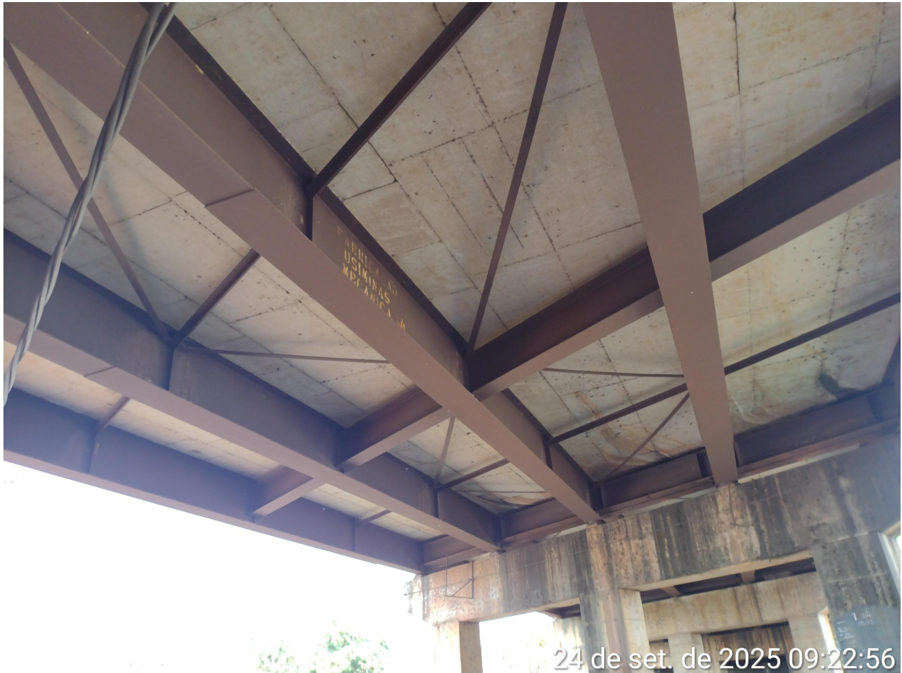
Figura 27 - Estrutura metálica com ações de intempéries
