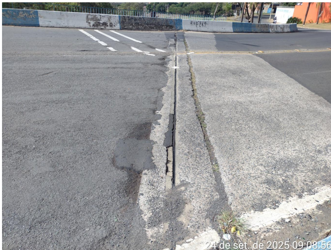
Figura 6 - Juntas de dilatação com sinais de desgaste
