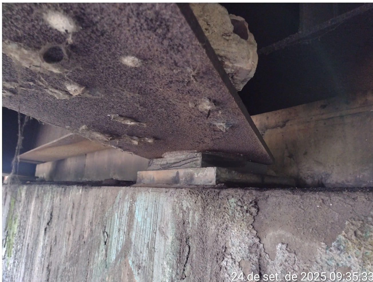
Figura 24 - Aparelhos de apoio com sinais de desgaste
