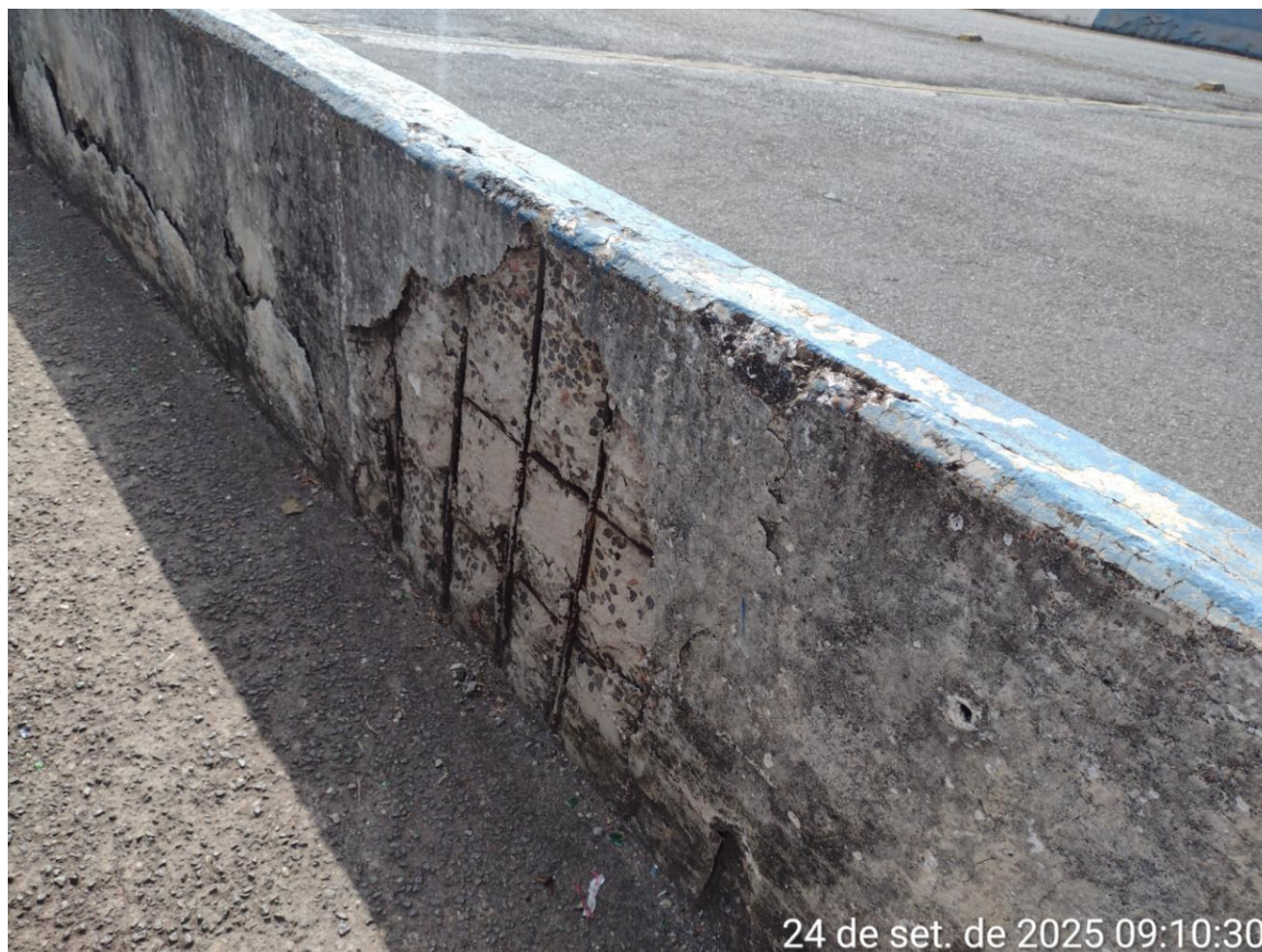
Figura 9 - Exposição de armadura na mureta de proteção de concreto
