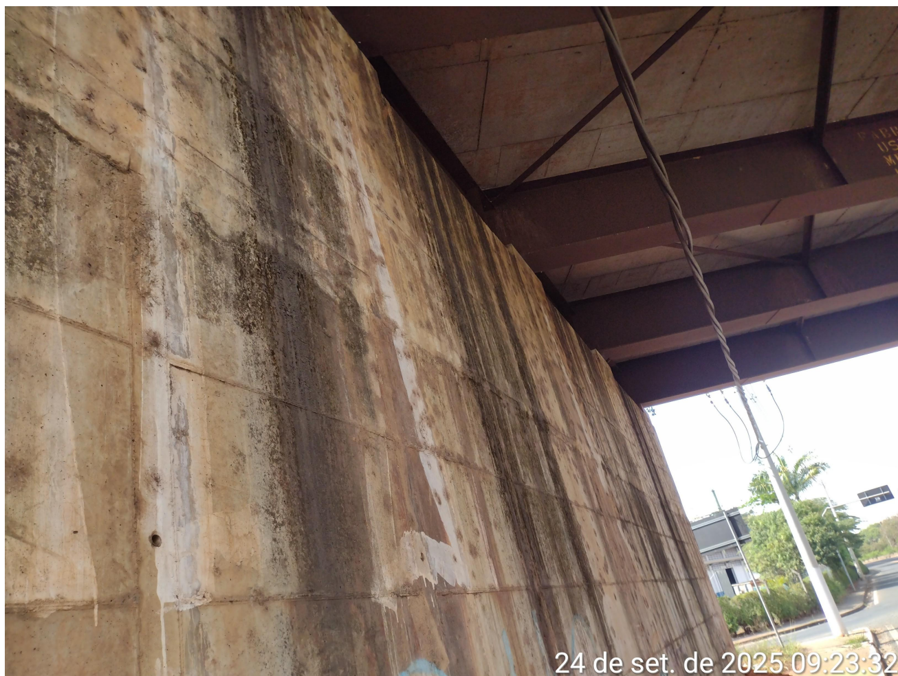
Figura 20 - Pontos de umidade causados infiltração nas juntas de dilatação
