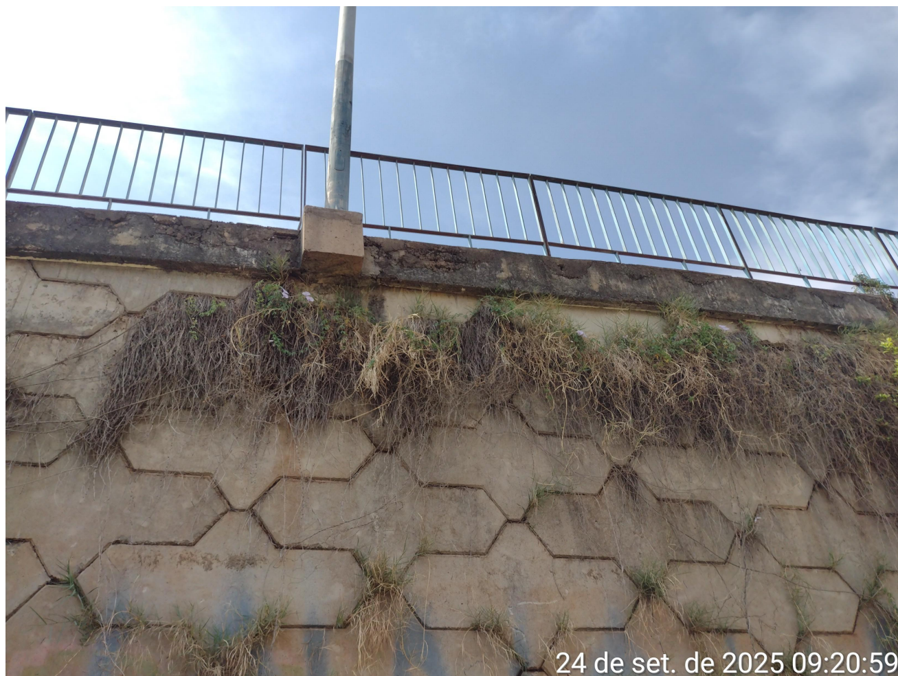
Figura 16 - Crescimento de vegetação ao longo da contenção de talude
