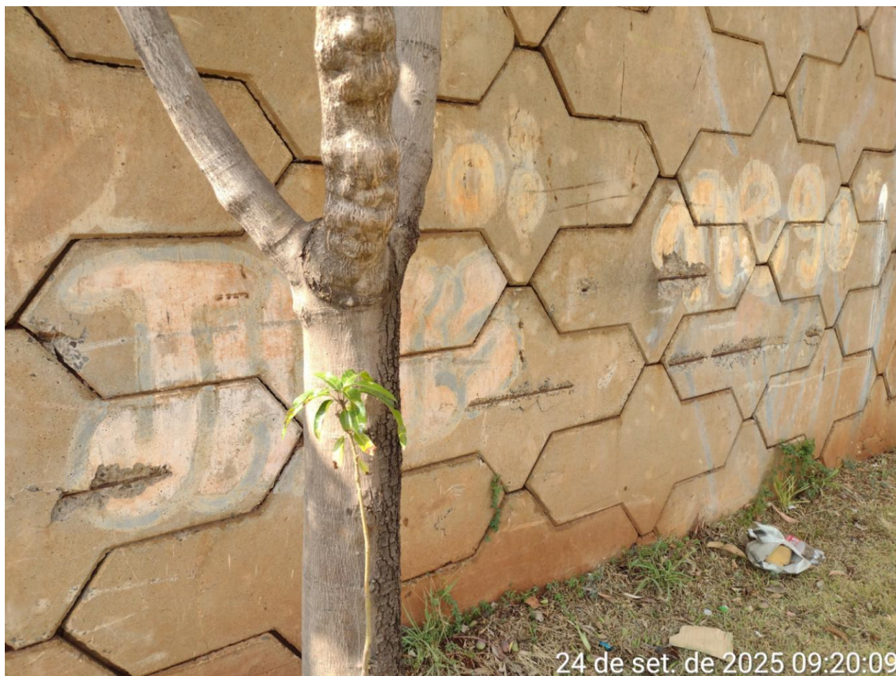
Figura 14 - Exposições de armaduras ao longo da contenção do talude
