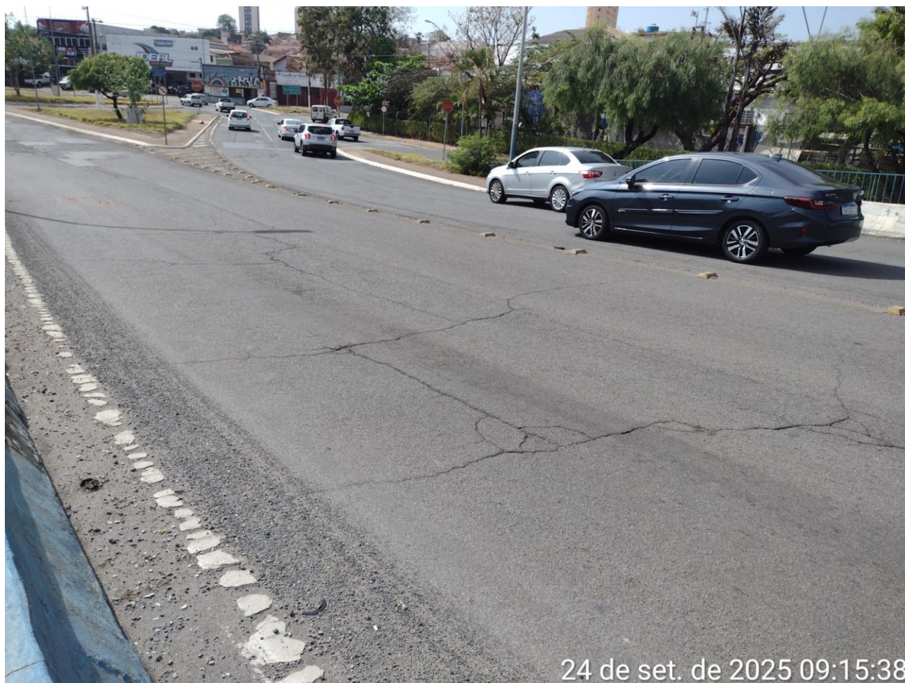
Figura 4 - Pavimentos com marcas de fissuração
