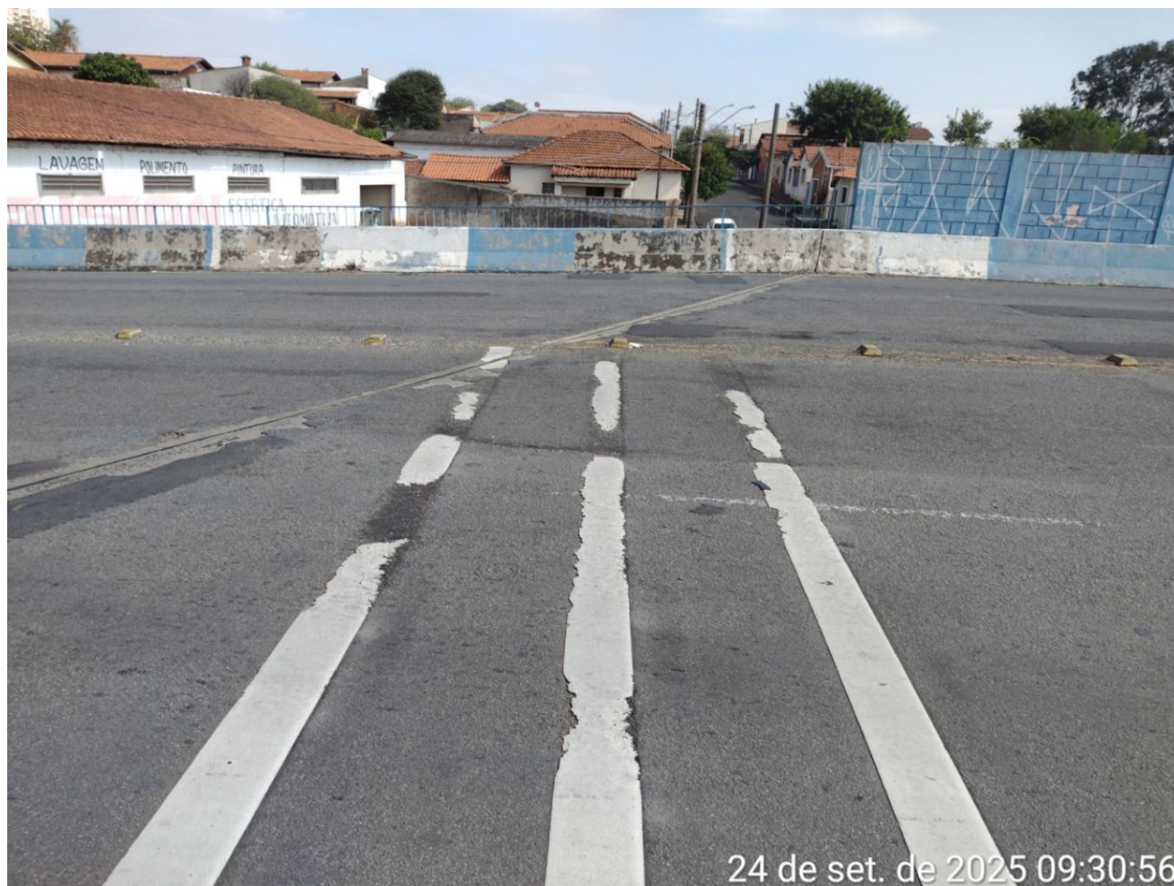
Figura 7 - Desgaste da sinalização viária
