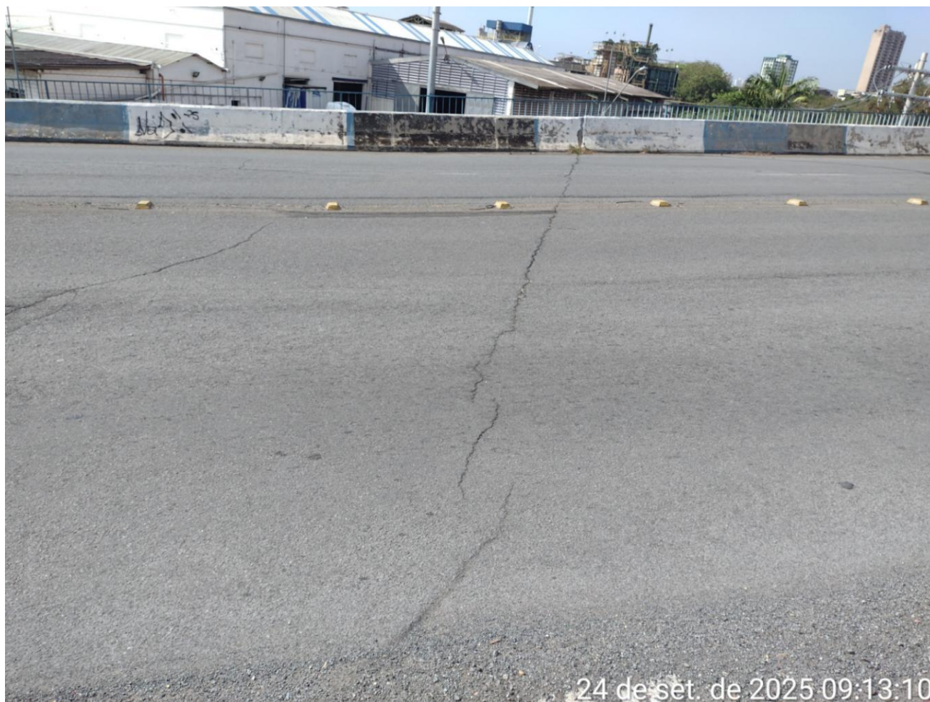
Figura 2 - Fissuração do pavimento
