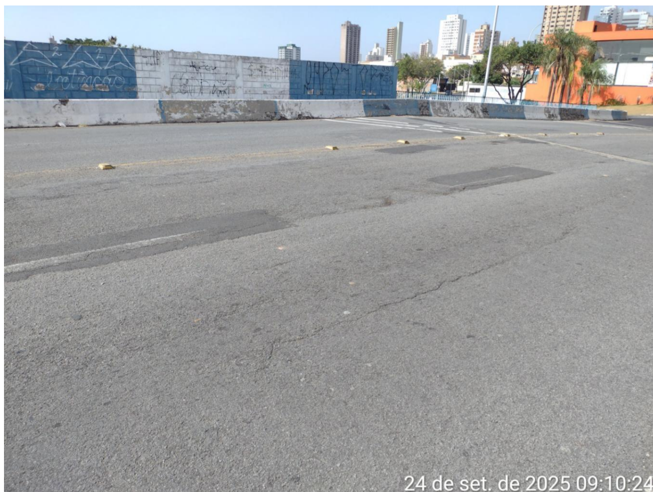
Figura 1 - ações de tapa buraco e fissurações longitudinais ao longo do pavimento
