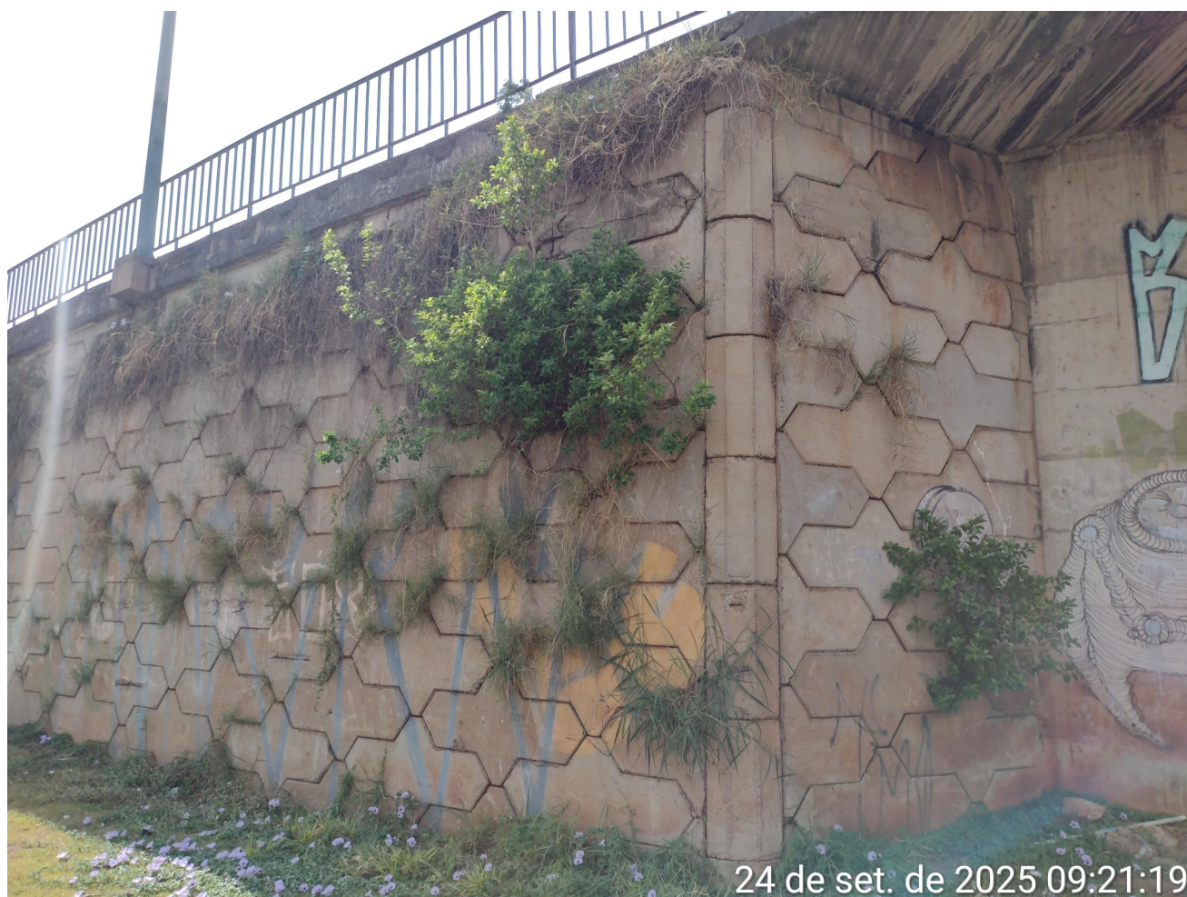
Figura 17 - Crescimento de vegetação ao longo da contenção de talude
