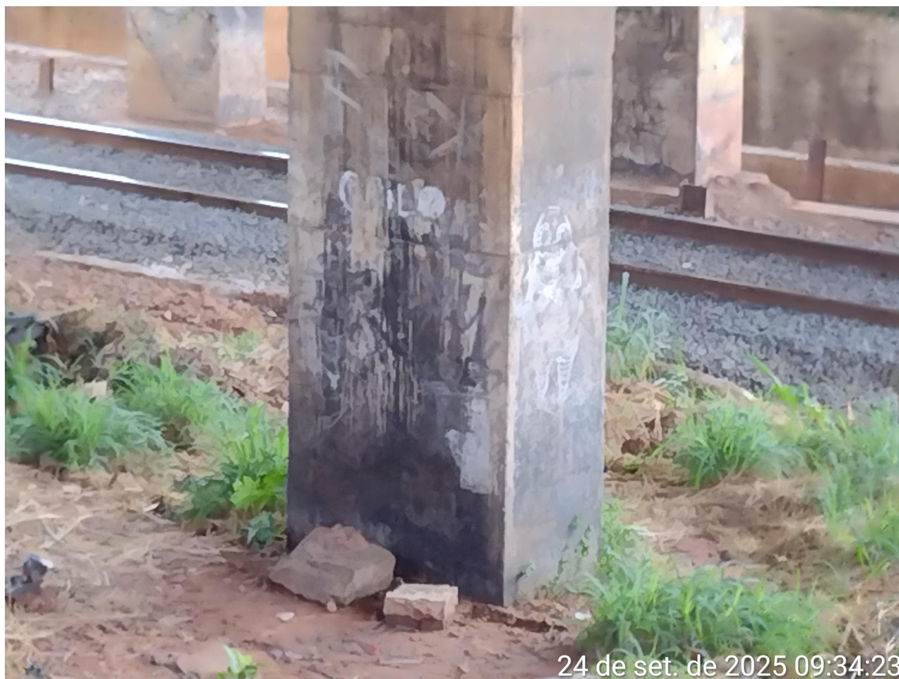
Figura 25 - Pilar com marcas de ações por fogo
