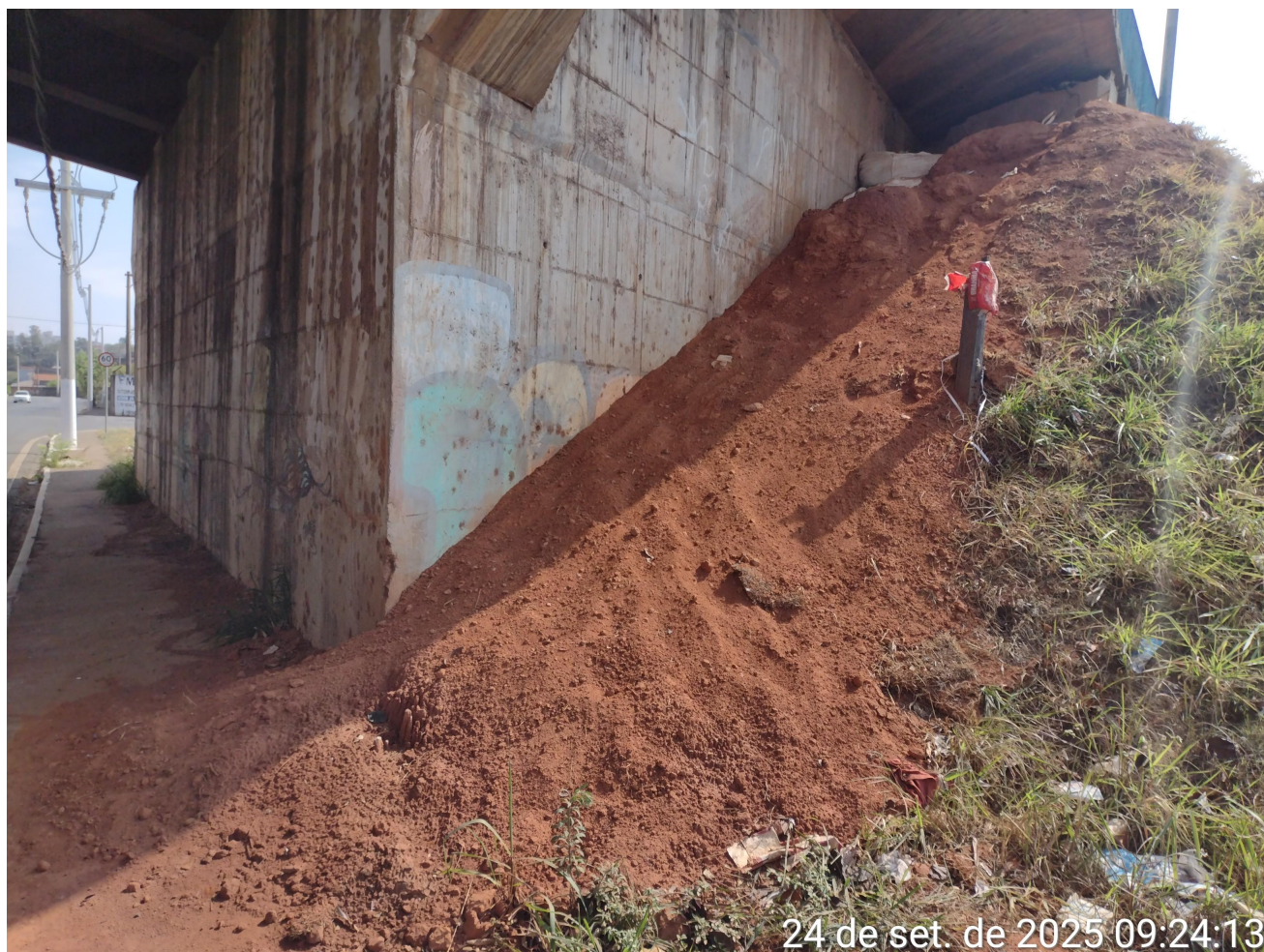
Figura 18 - Escorregamento do solo na contenção
