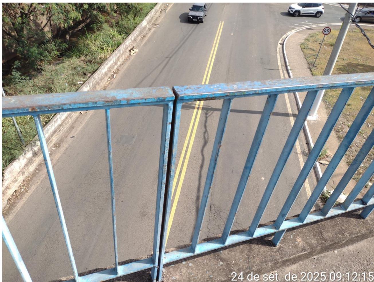
Figura 10 - Gradis com sinais de intempéries
