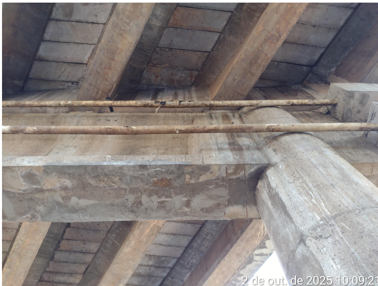
Figura 14 - Bainhas de protensão danificadas
