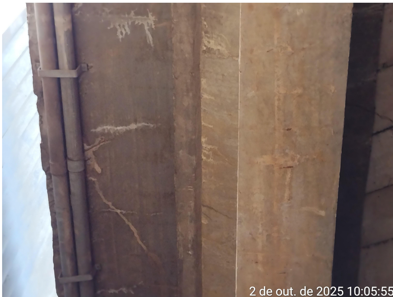
Figura 12 - Estrutura com cobrimento insuficiente
