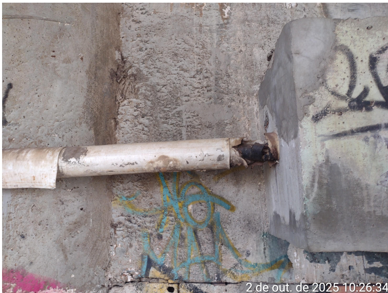
Figura 17 - Bainha danificada com exposição das cordoalhas
