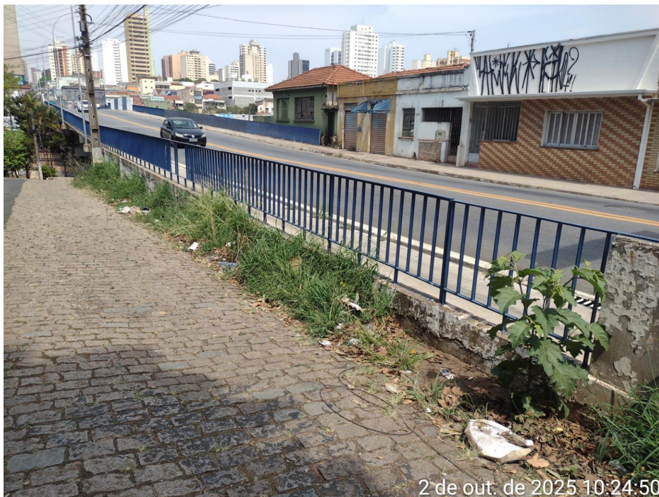
Figura 10 - Vegetação crescendo ao longo da estrutura de contenção
