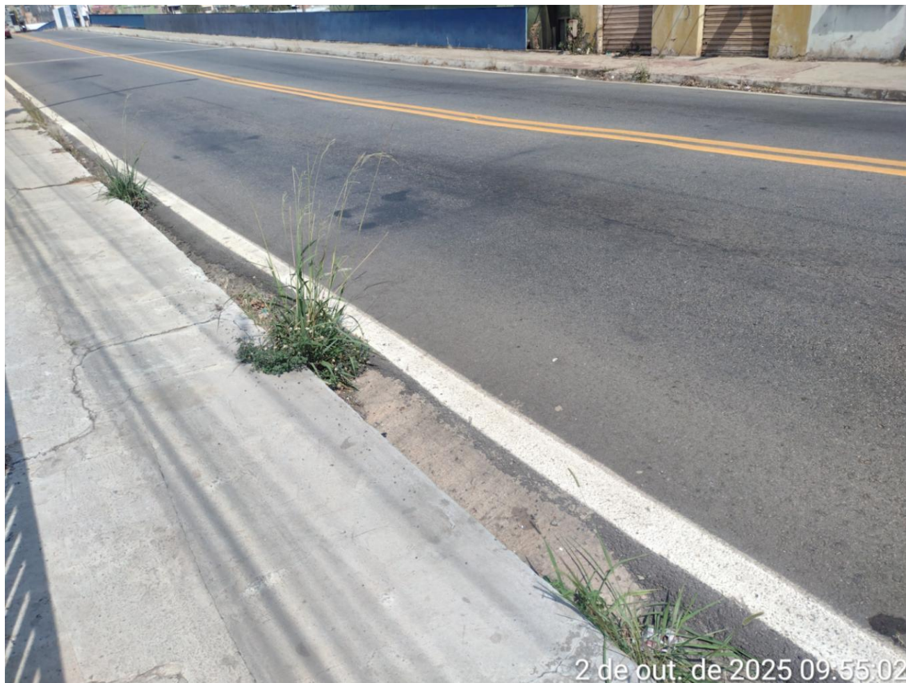
Figura 3 - Vegetação crescendo ao longo da guia e sarjeta, podendo comprometer a longo prazo a vida útil do pavimento
