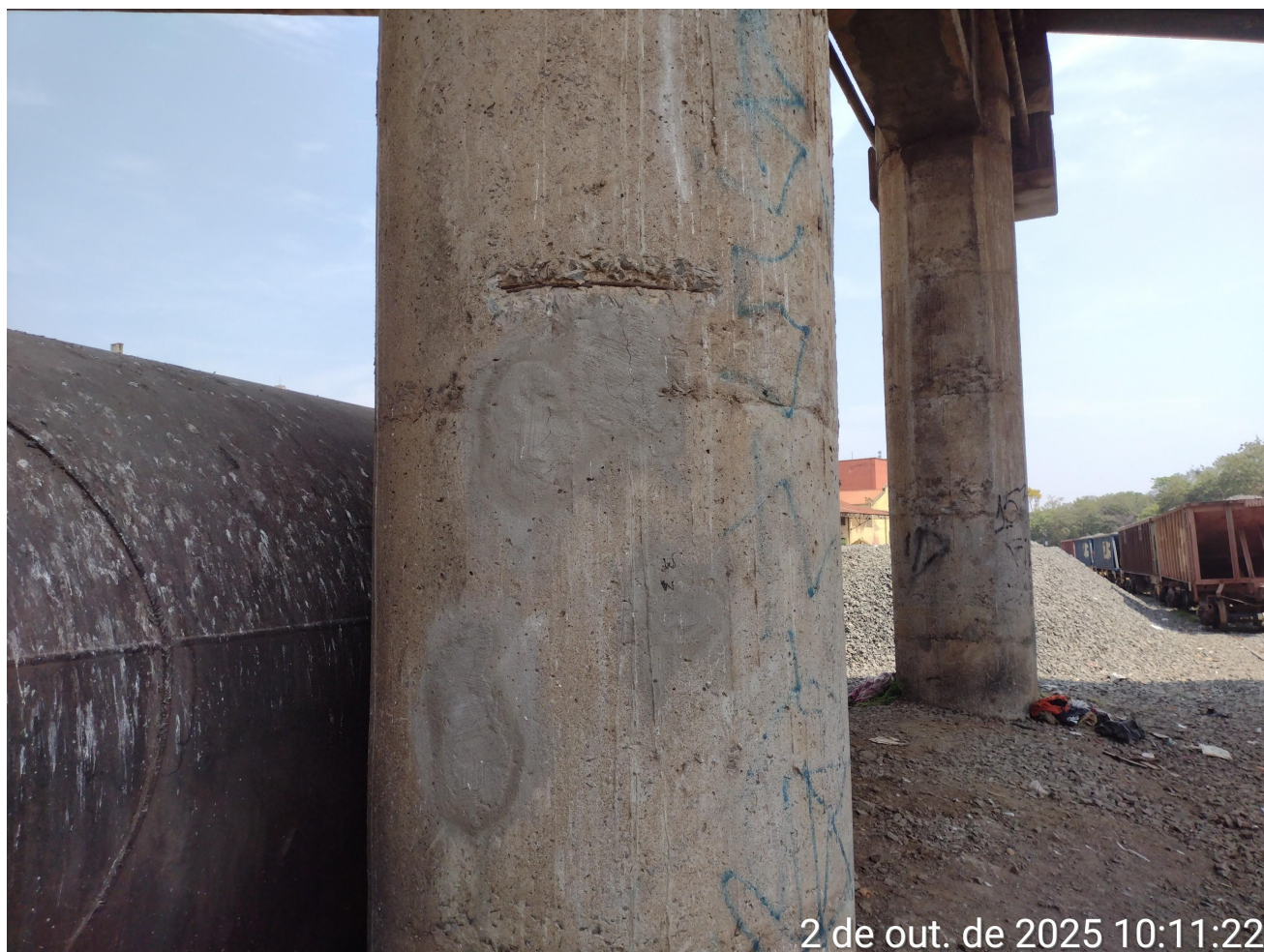
Figura 18 - Pilar com armadura exposta
