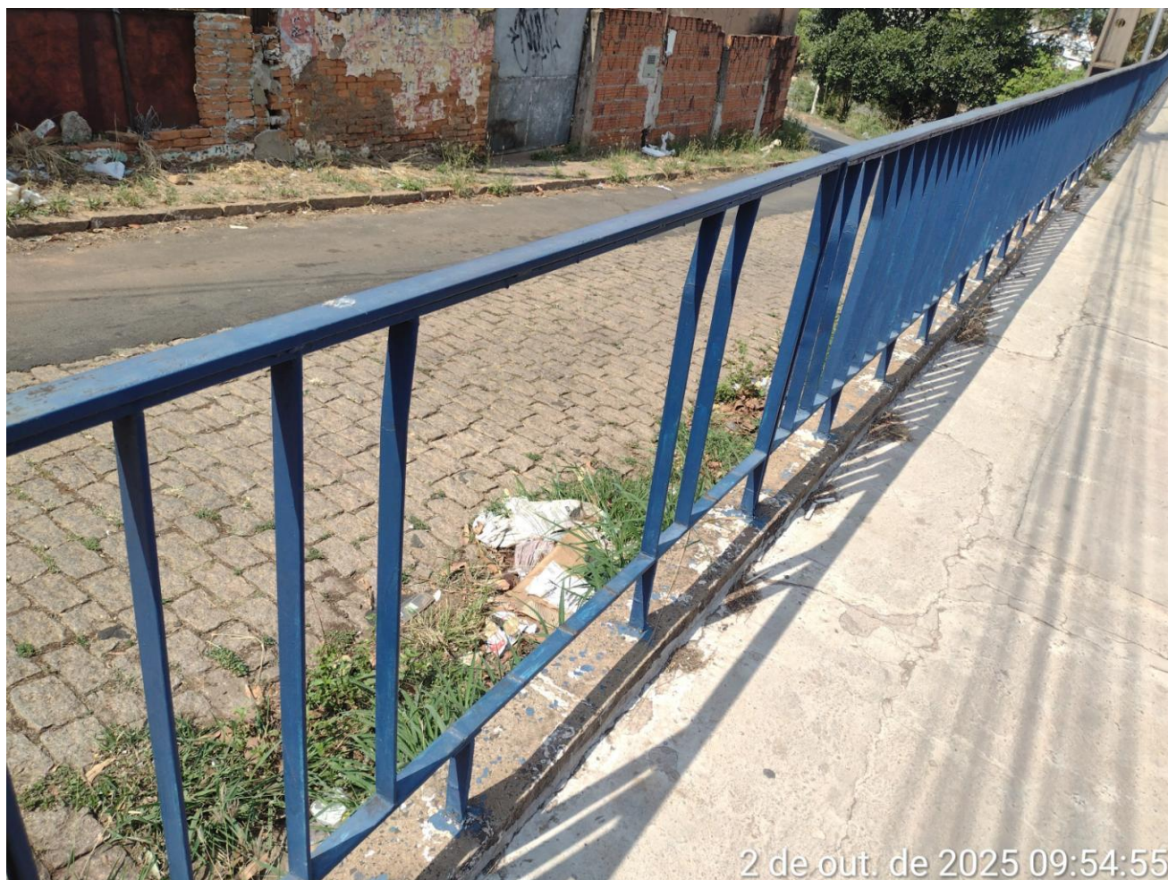
Figura 4 - Gradis com pontos de avarias
