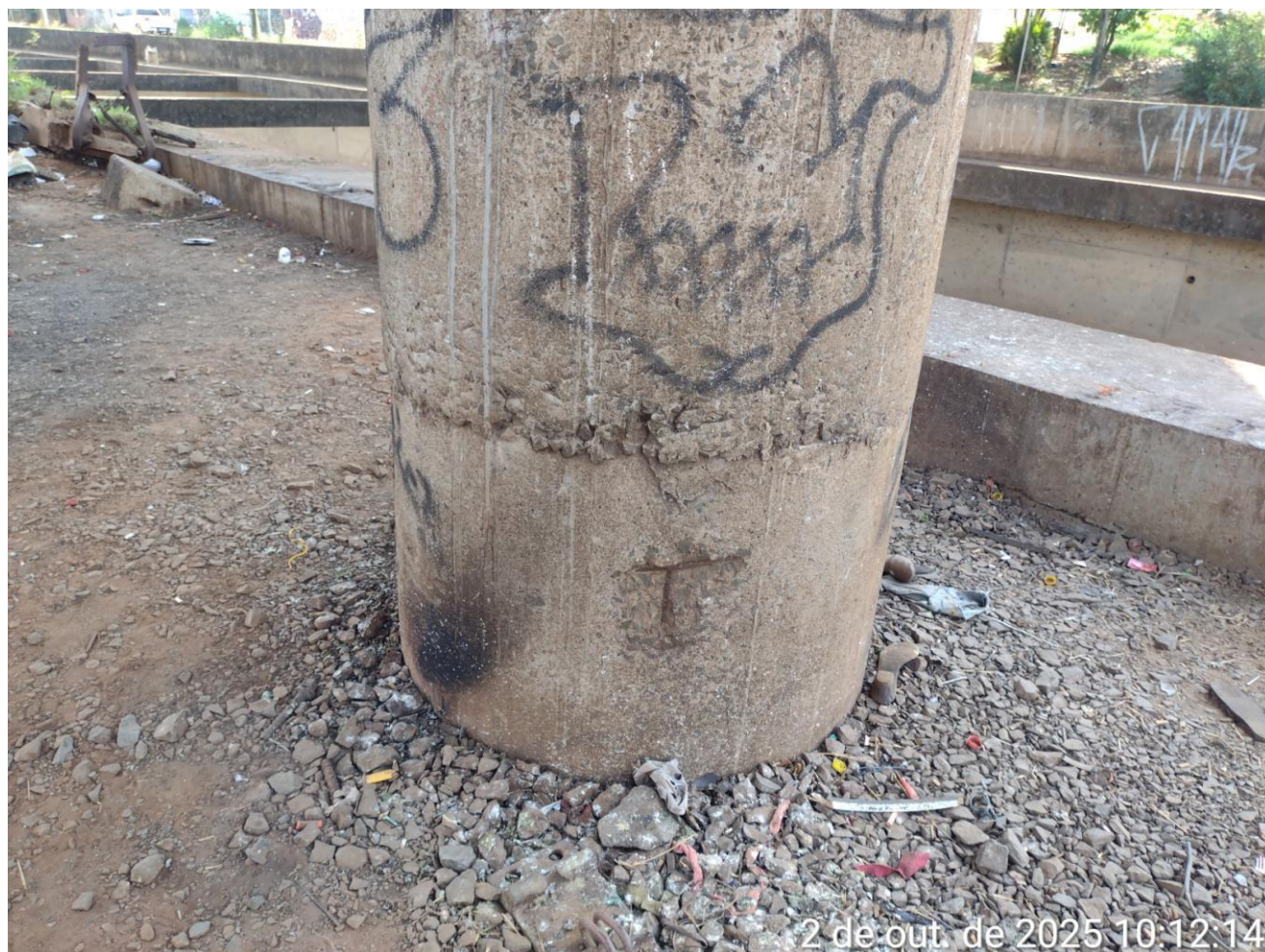
Figura 22 - Pilar com sinais de fogo, armadura exposta e “bicheira”
