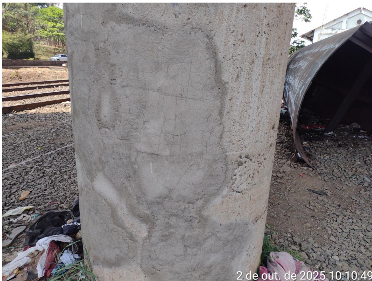
Figura 19 - Pilar com sinais de intervenções recentes, porém com fissurações que comprometem a eficiência da mesma
