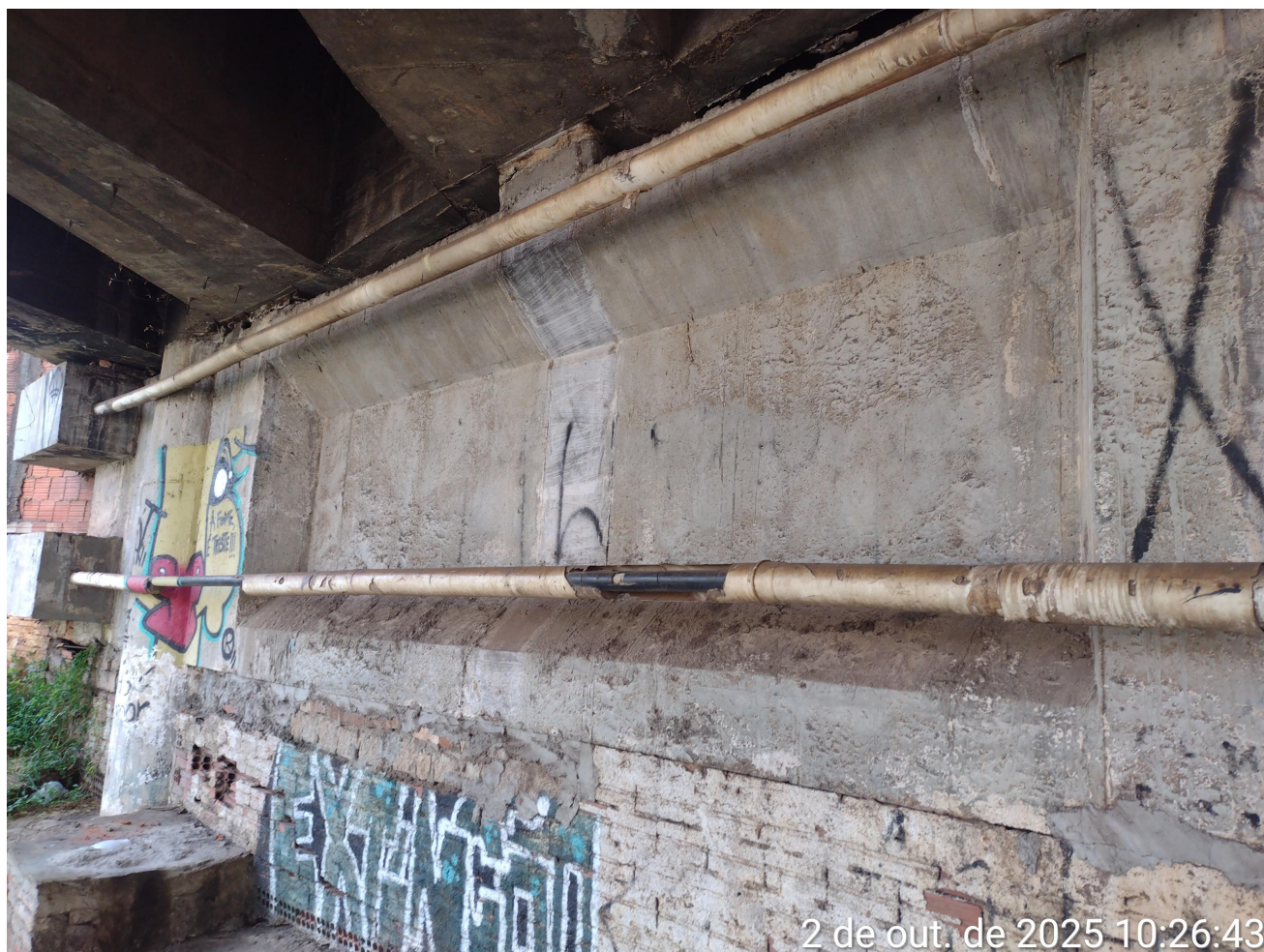
Figura 16 - Bainha de protensão danificadas
