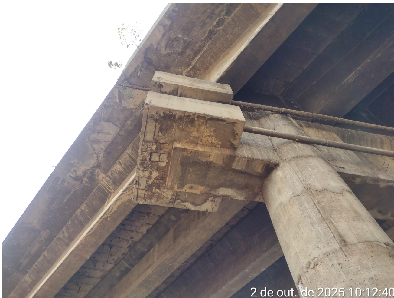
Figura 15 - Elemento de ancoragem com armadura exposta
