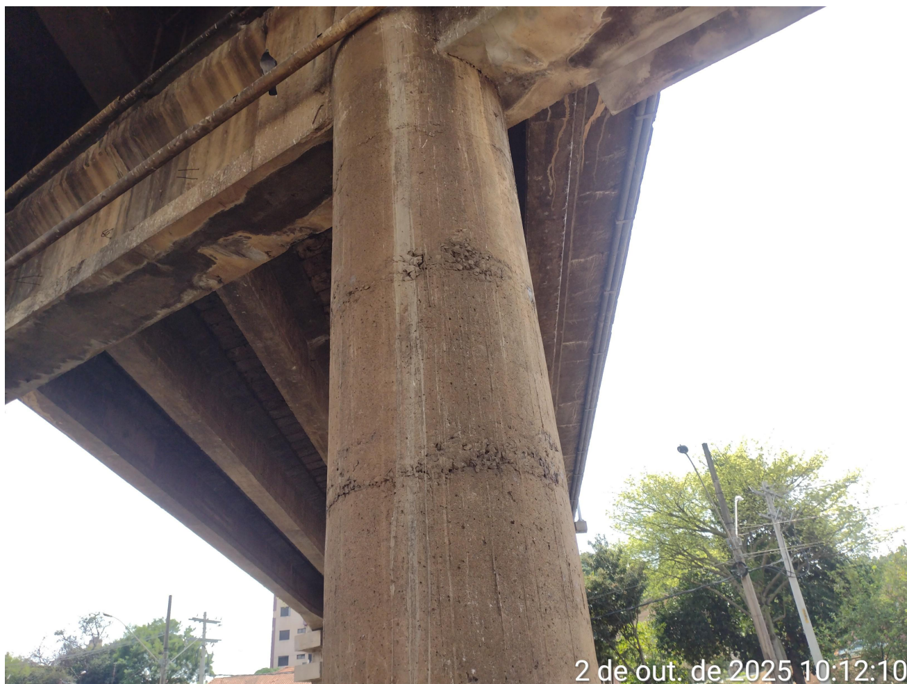
Figura 20 - Pilares com sinais de "bicheiras"
