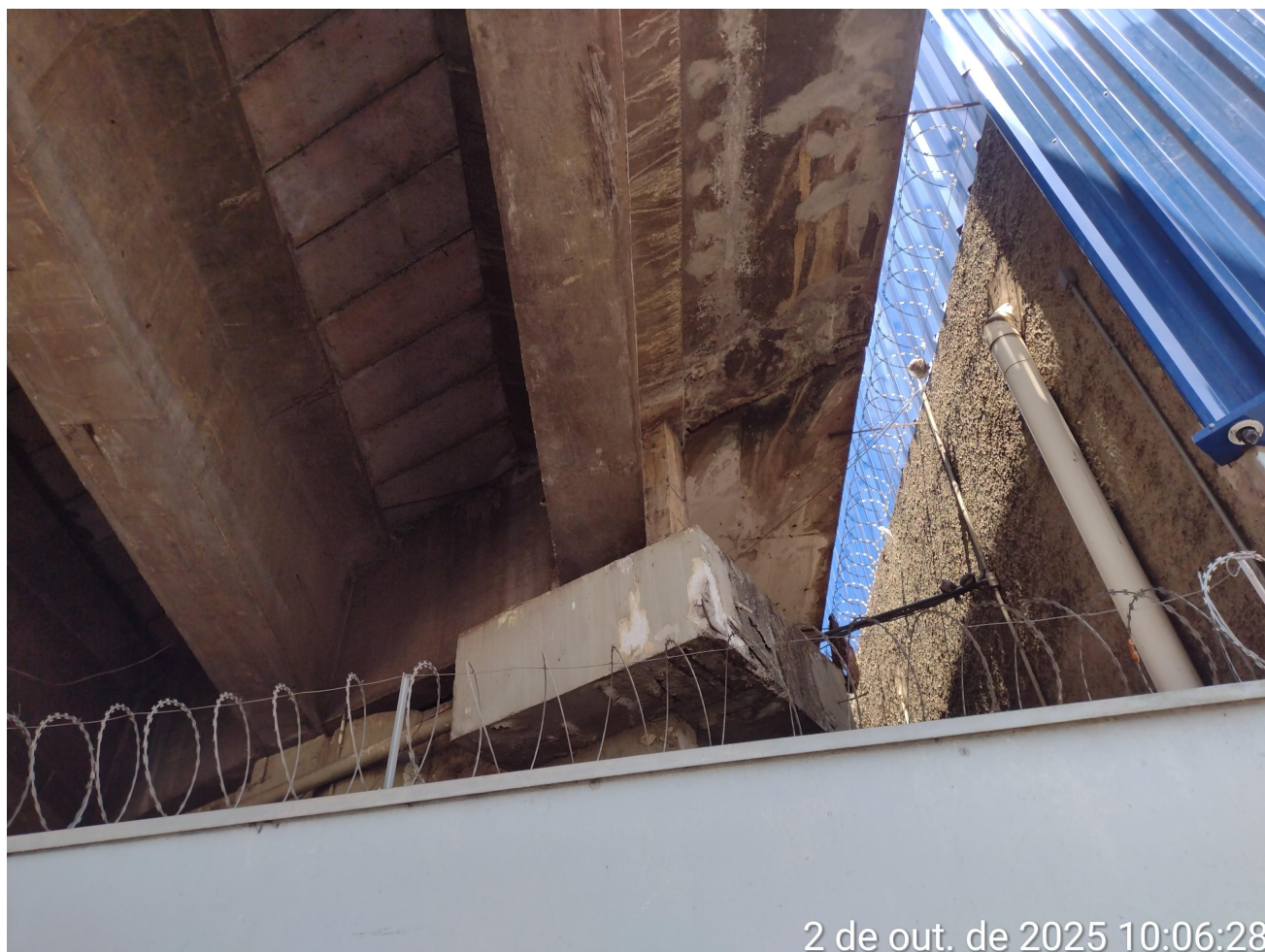
Figura 13 - Pontos de umidade ao longo da estrutura e armadura exposta no elemento de ancoragem das bainhas de protensão.
