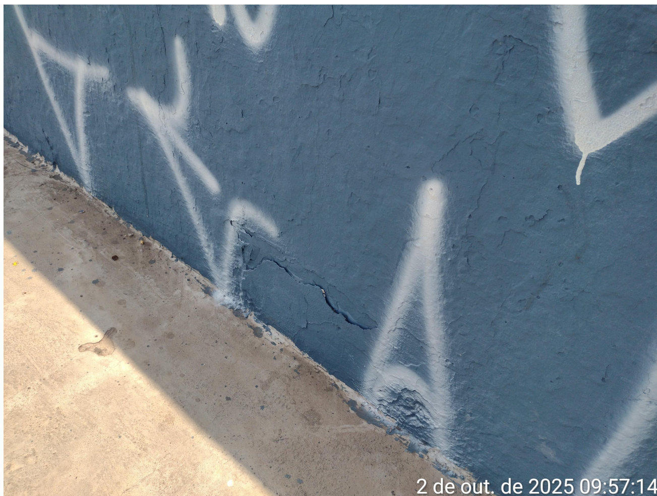
Figura 8 - Muro de proteção com sinais de vandalismo e deslocamento de reboco
