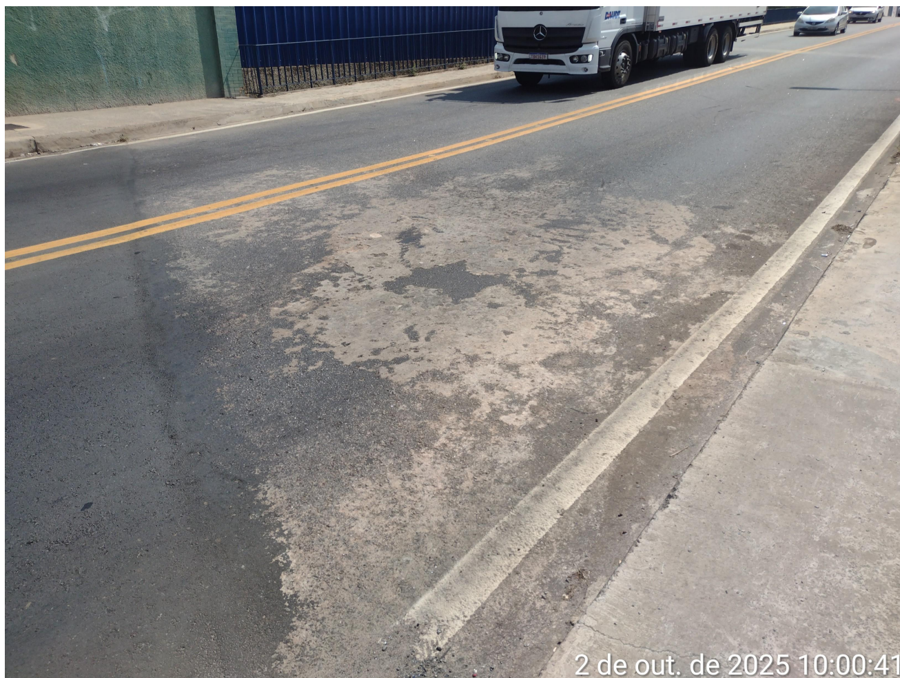
Figura 9 - Pavimento com sinais de intervenções das redes locais
