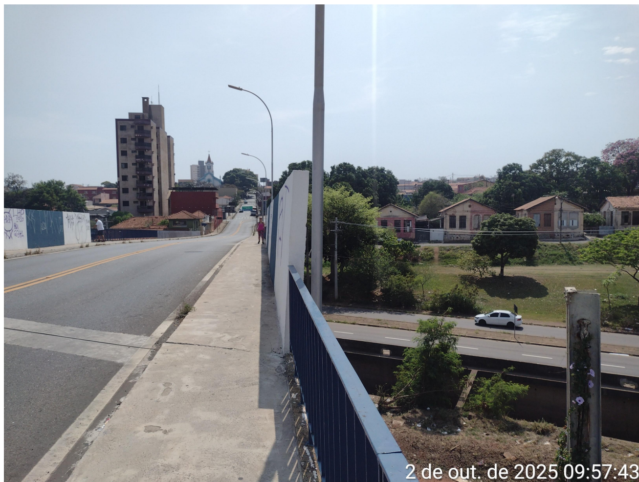
Figura 6 - Muro de proteção em desaprumo, requerendo atenção periódica
