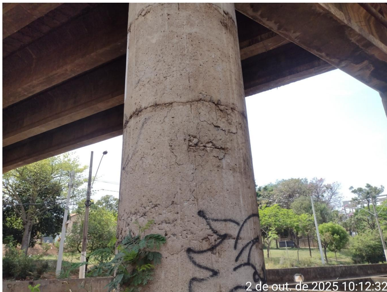
Figura 21 - Pilar com "bicheiras" e armadura exposta, além de deslocamento de concreto
