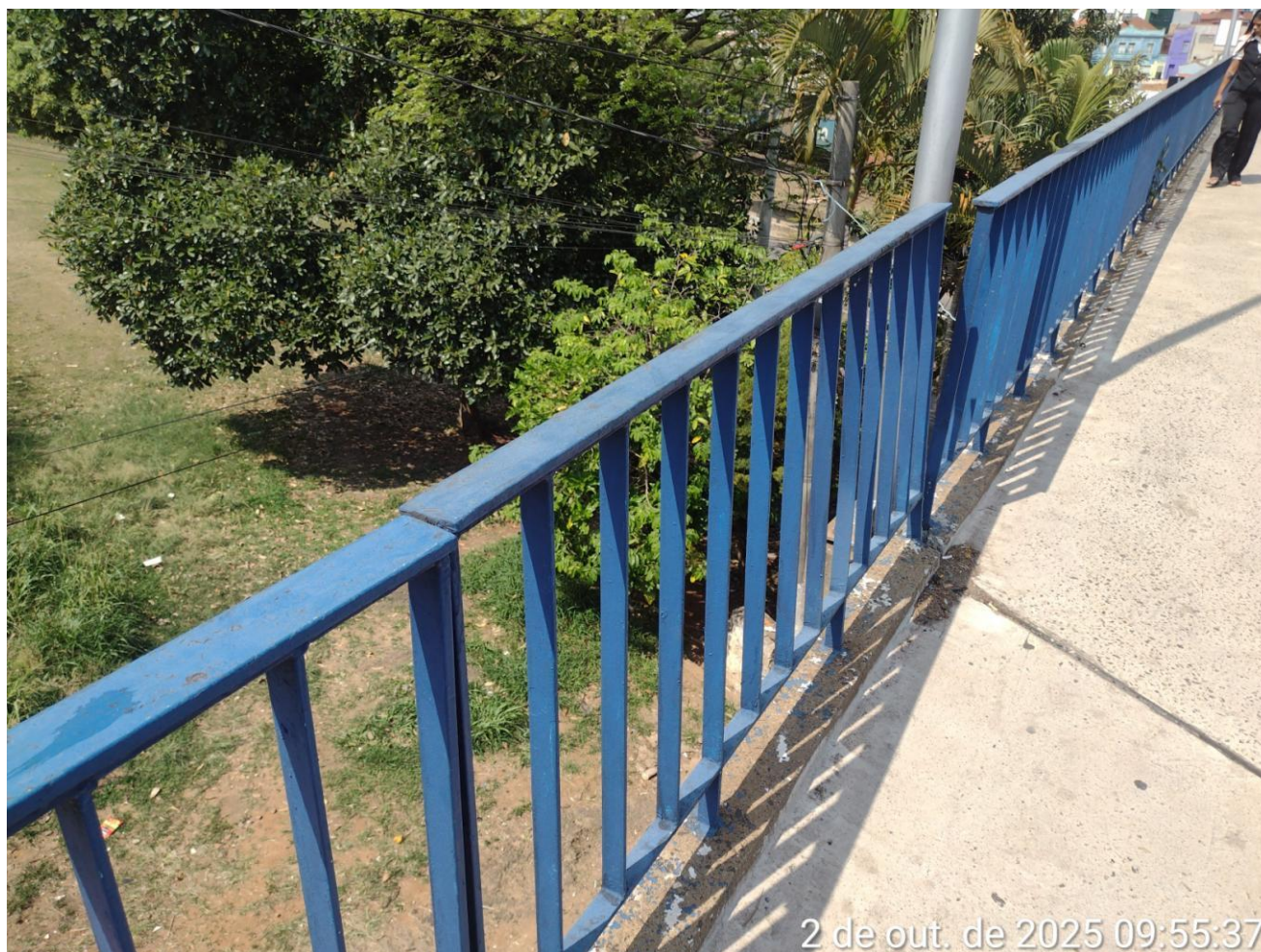
Figura 5 - Gradis com pontos de avarias
