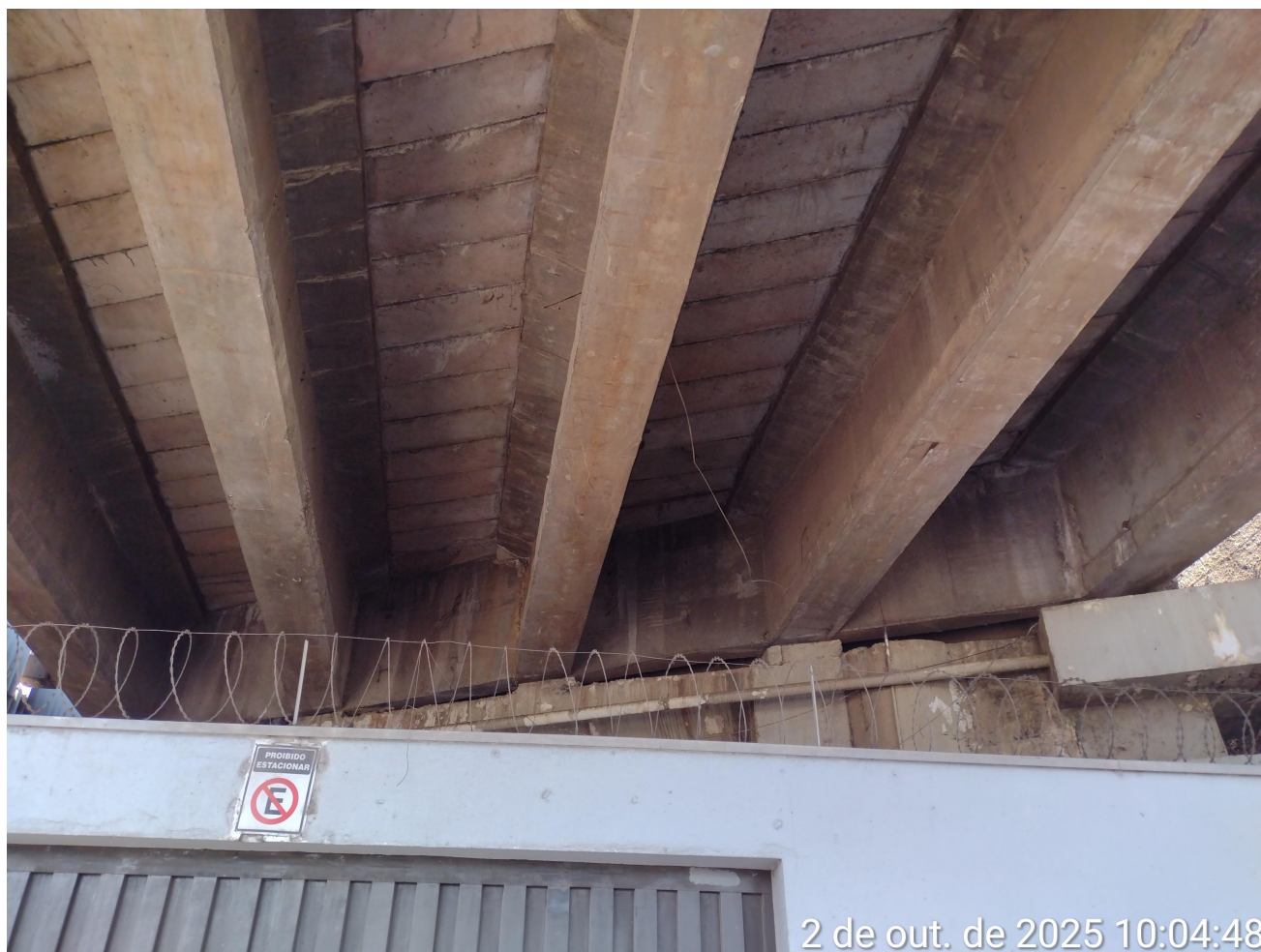
Figura 11 - Estrutura com cobrimento insuficiente
