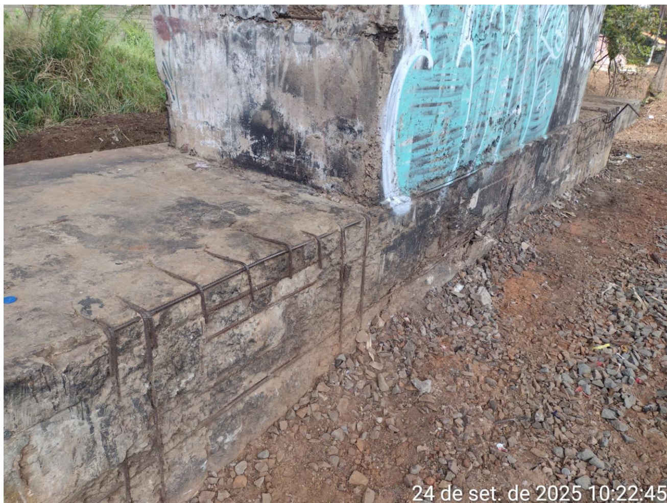
Figura 33 - Blocos de fundação com armaduras expostas
