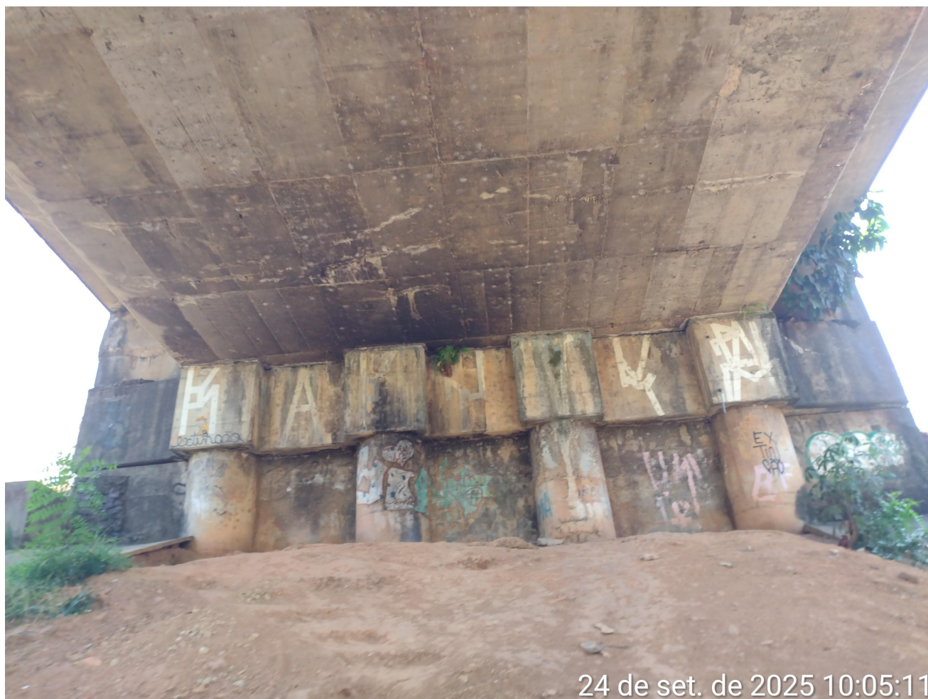
Figura 25 - Marcas de fogo na face inferior do caixão perdido
