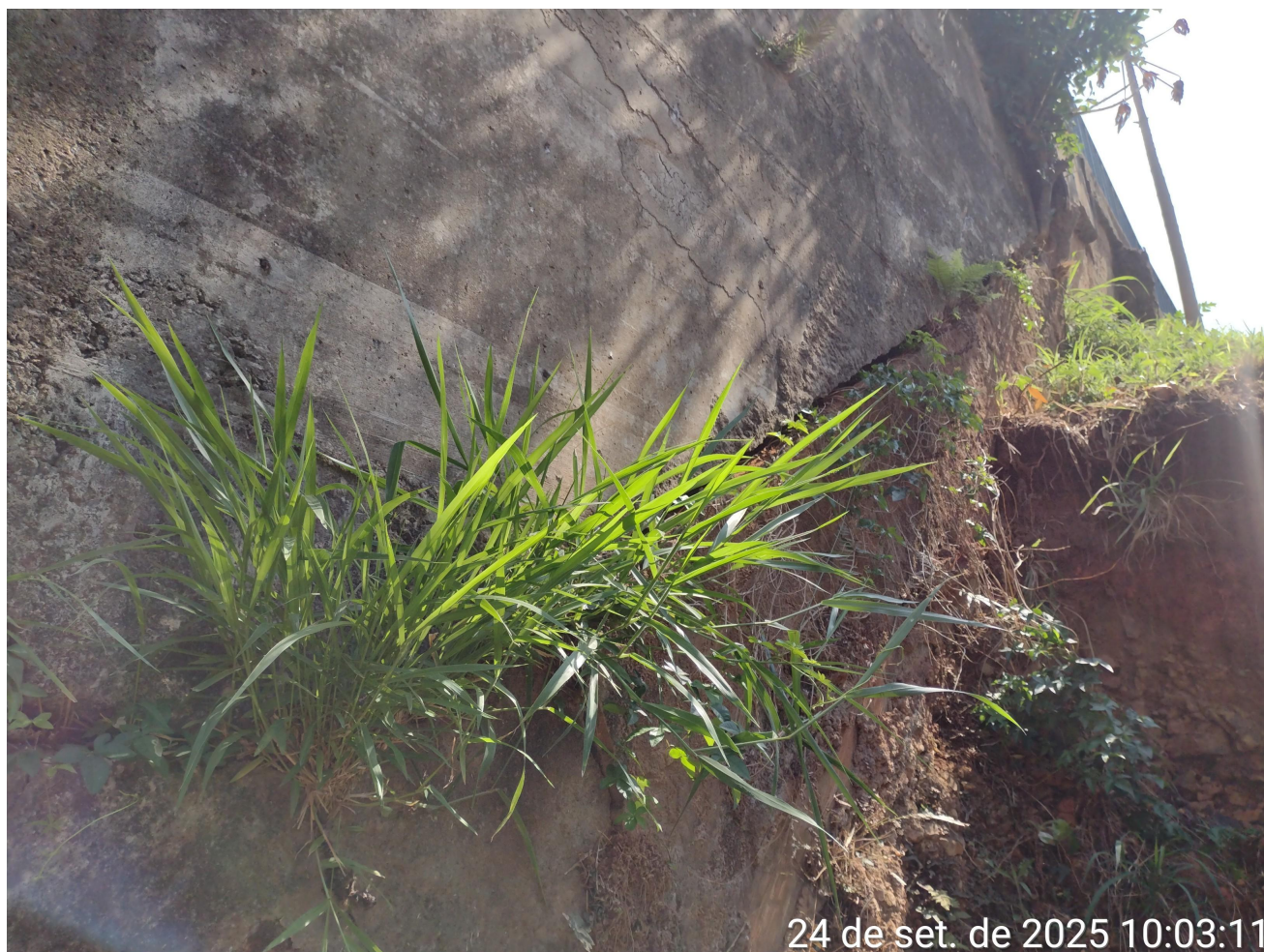
Figura 20 - Ausência de contenção lateral, apresentando erosão do talude
