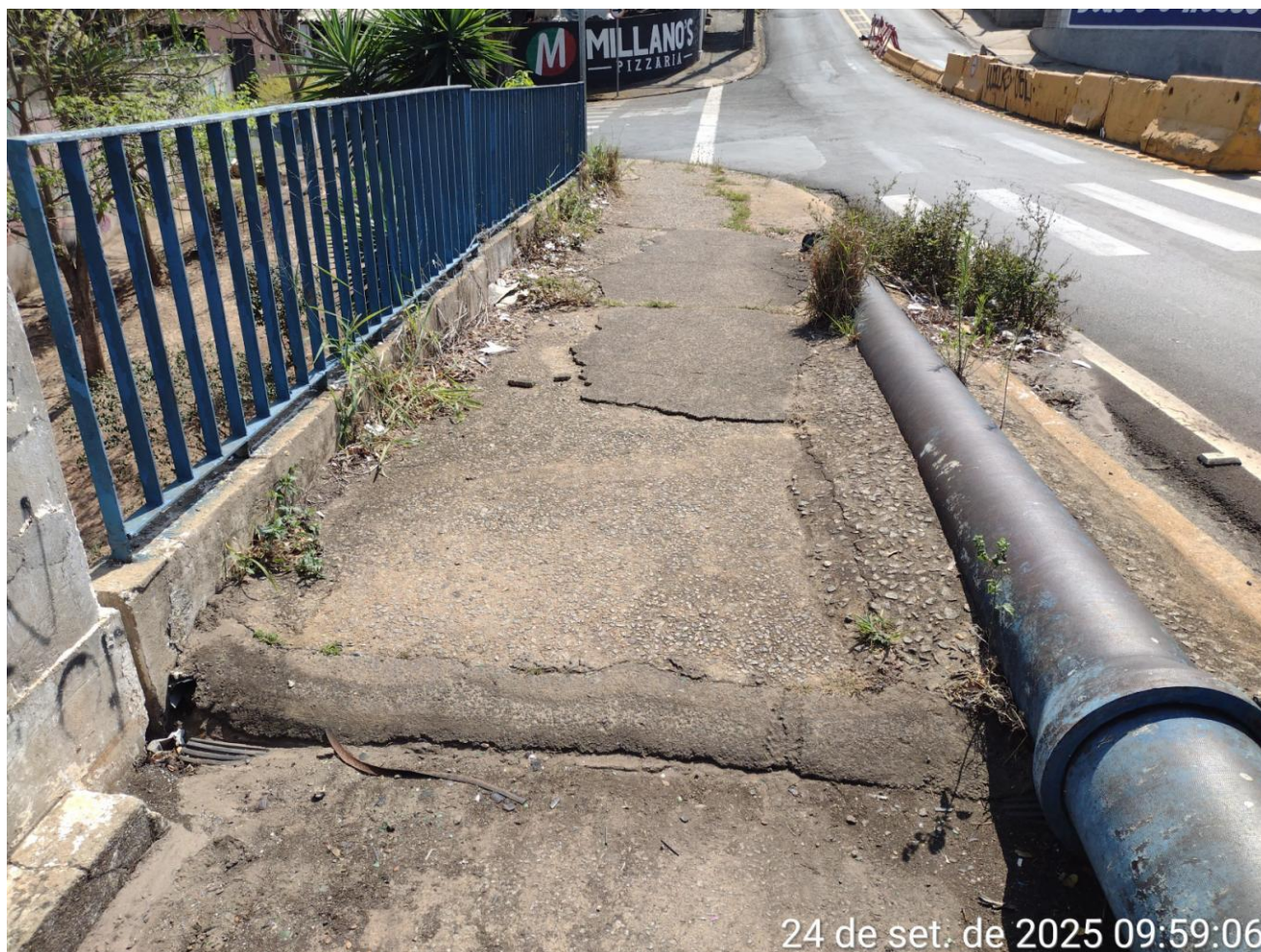
Figura 9 - Necessidade de adequação para acessibilidade
