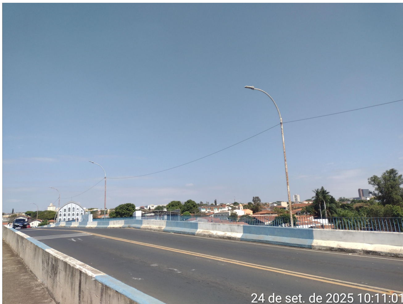
Figura 15 - New Jerseys com pinturas desgastadas e postes de iluminação com corrosão
