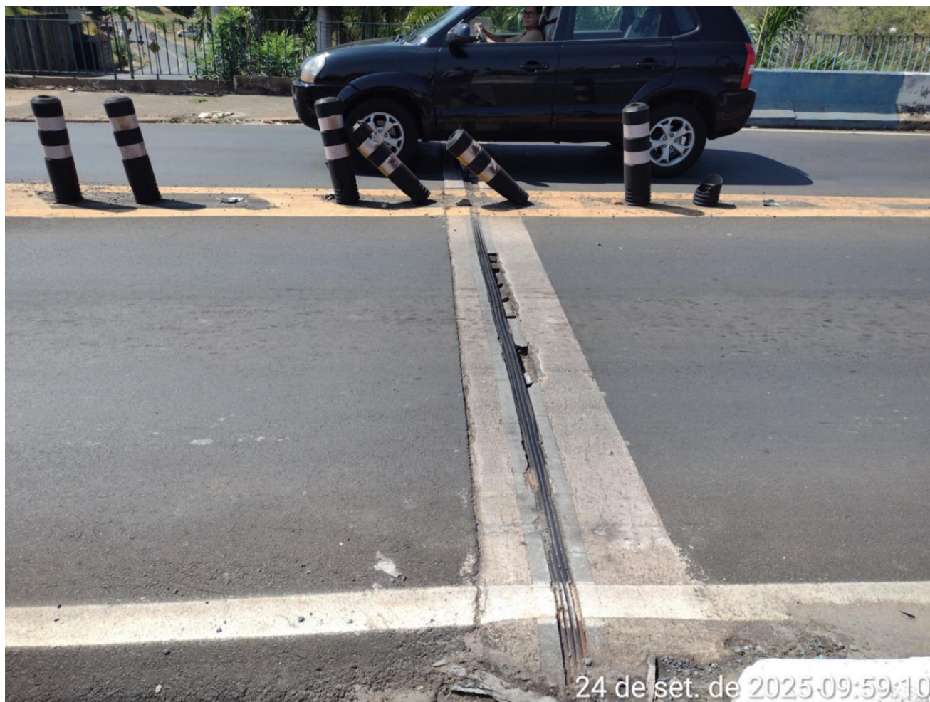
Figura 5 - Juntas de dilatação e balizadores, que necessitam de ações de reparo
