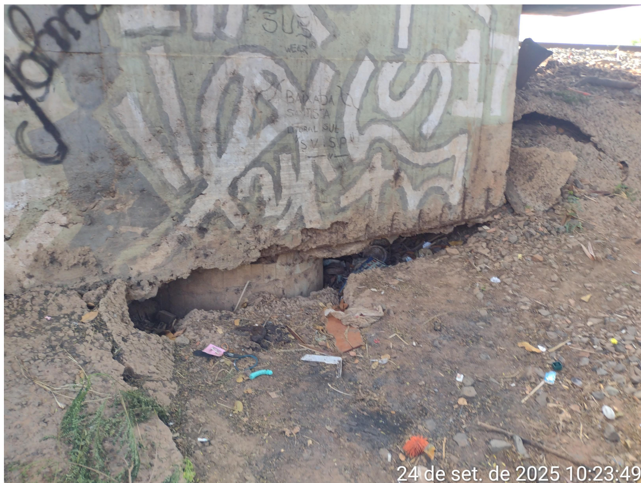
Figura 35 - Descalçamento do solo debaixo do bloco de fundação
