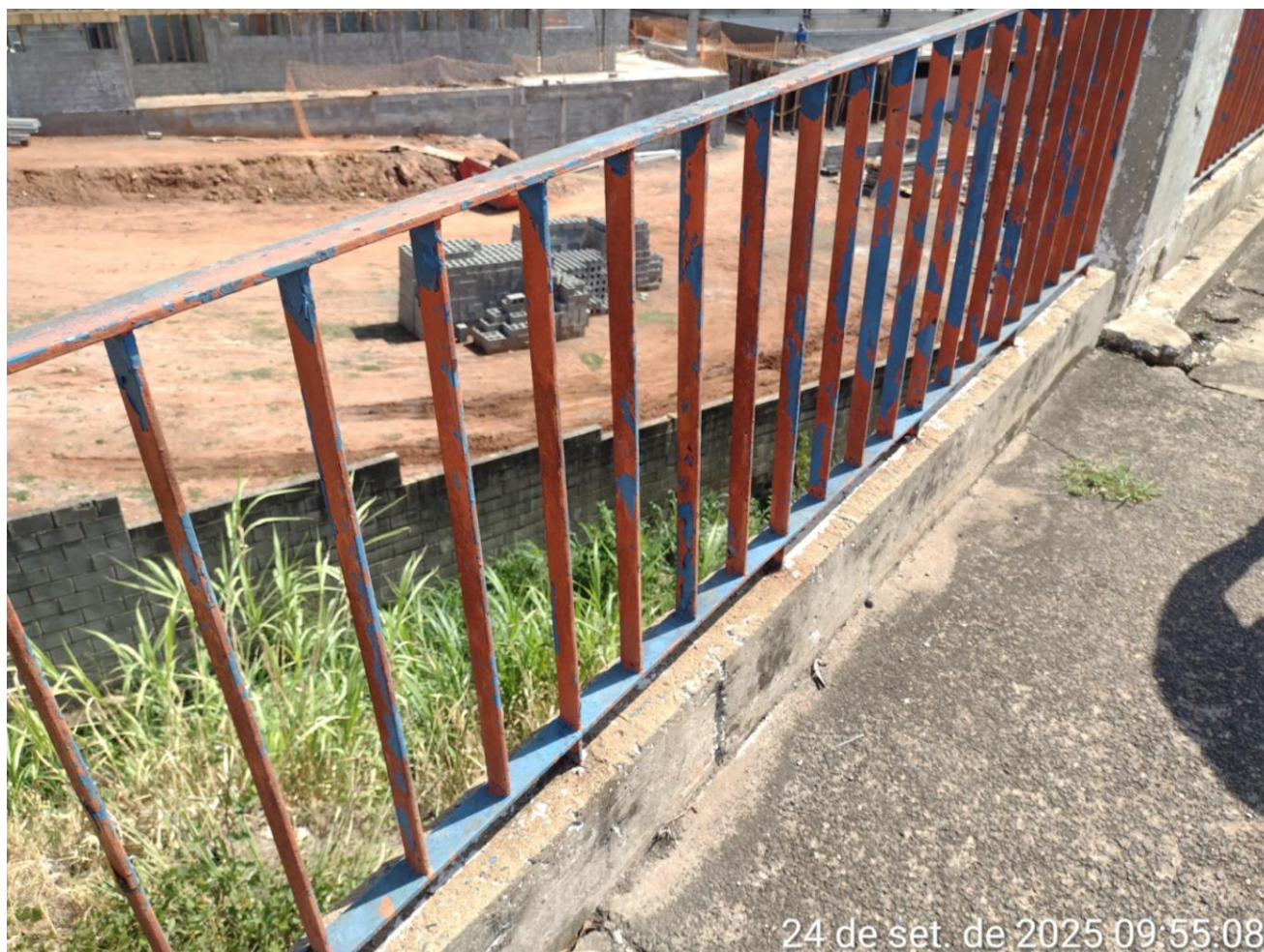
Figura 14 - Gradis desgastados pelas intempéries
