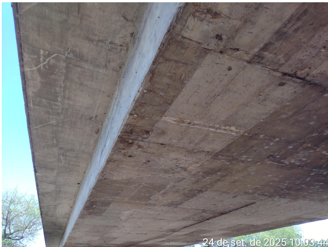
Figura 28 - Armadura exposta na face inferior do caixão perdido
