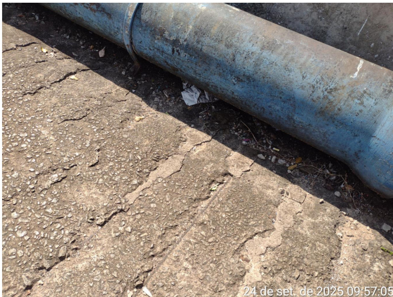
Figura 11 - Calçada com armadura exposta
