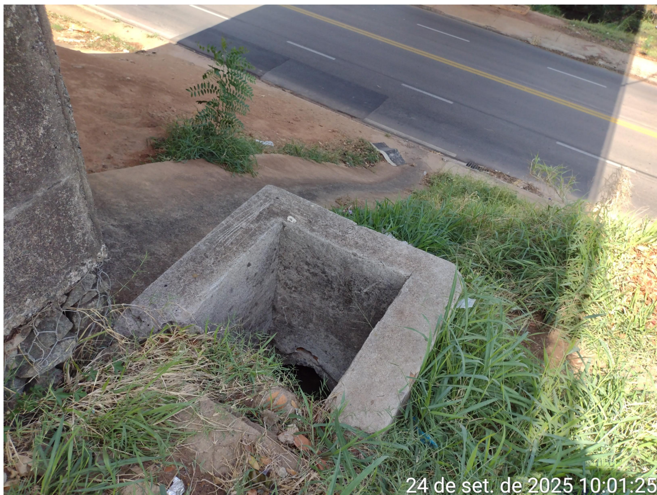
Figura 19 - Galeria sem tampa de proteção
