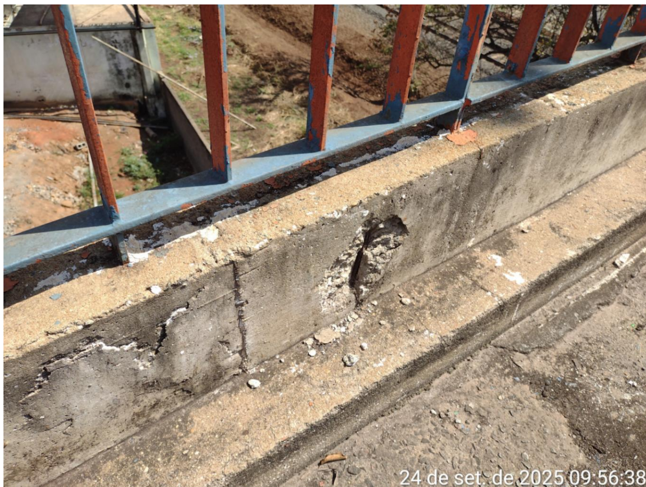
Figura 12 - Muretas com diversos pontos de armadura exposta
