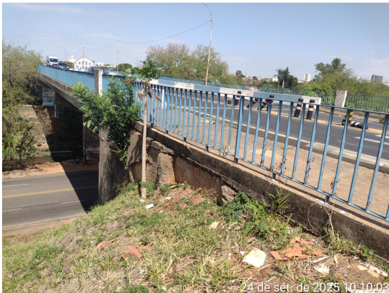
Figura 22 - Vegetação crescendo ao longo da estrutura
