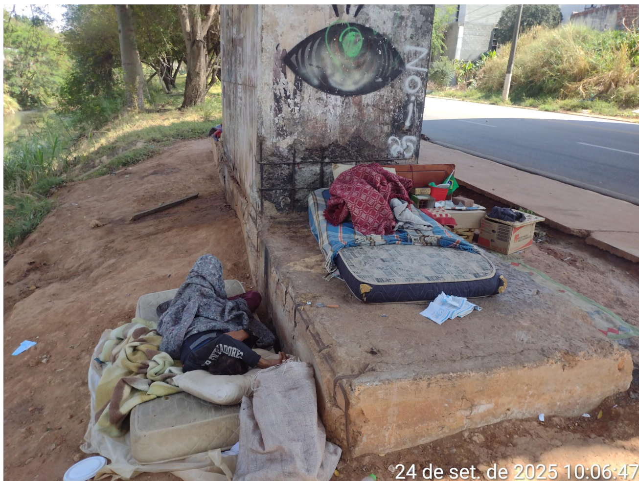
Figura 32 - Blocos de fundação e bases de pilares com armaduras expostas
