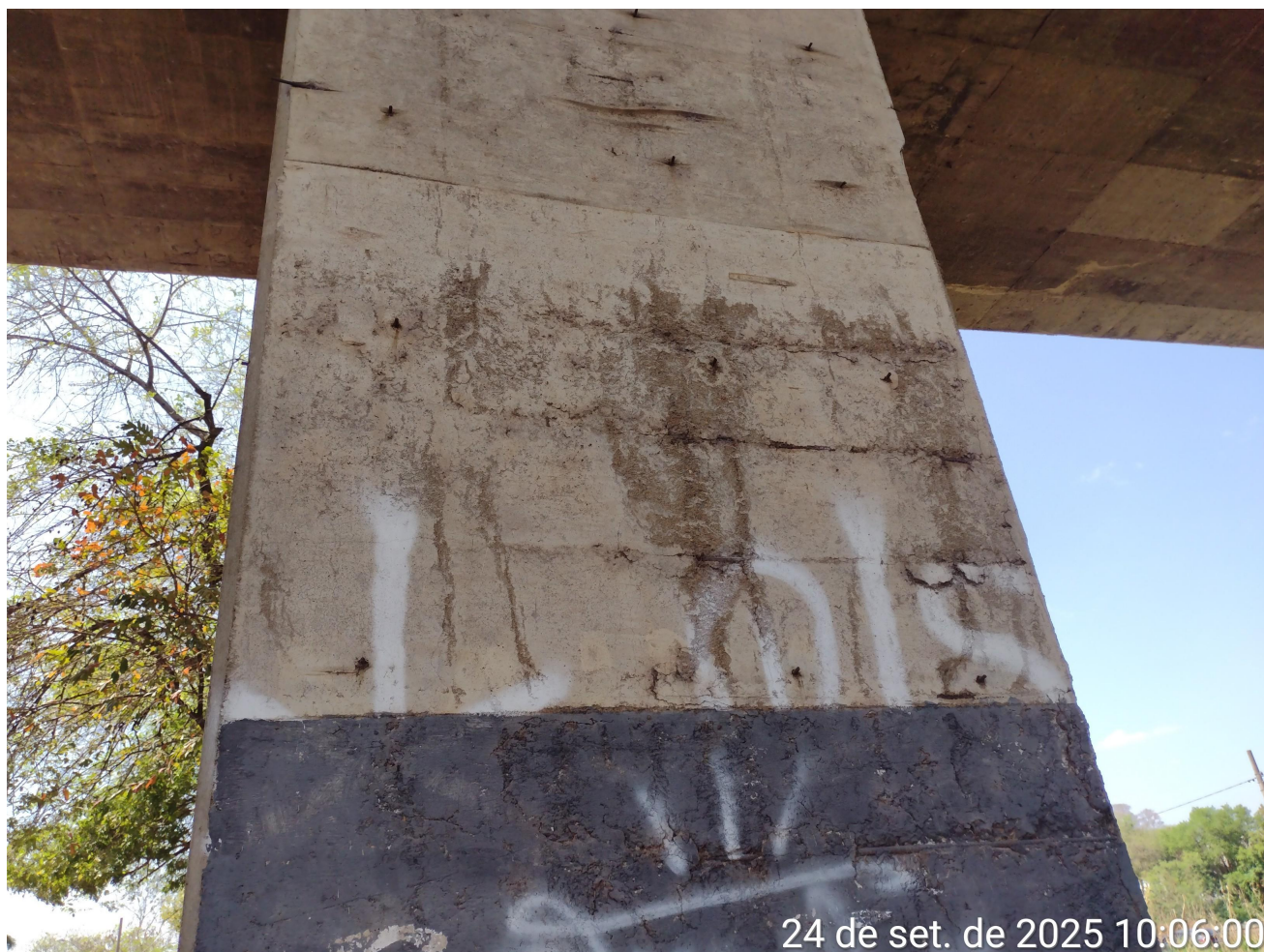
Figura 29 - Pilares com armadura exposta
