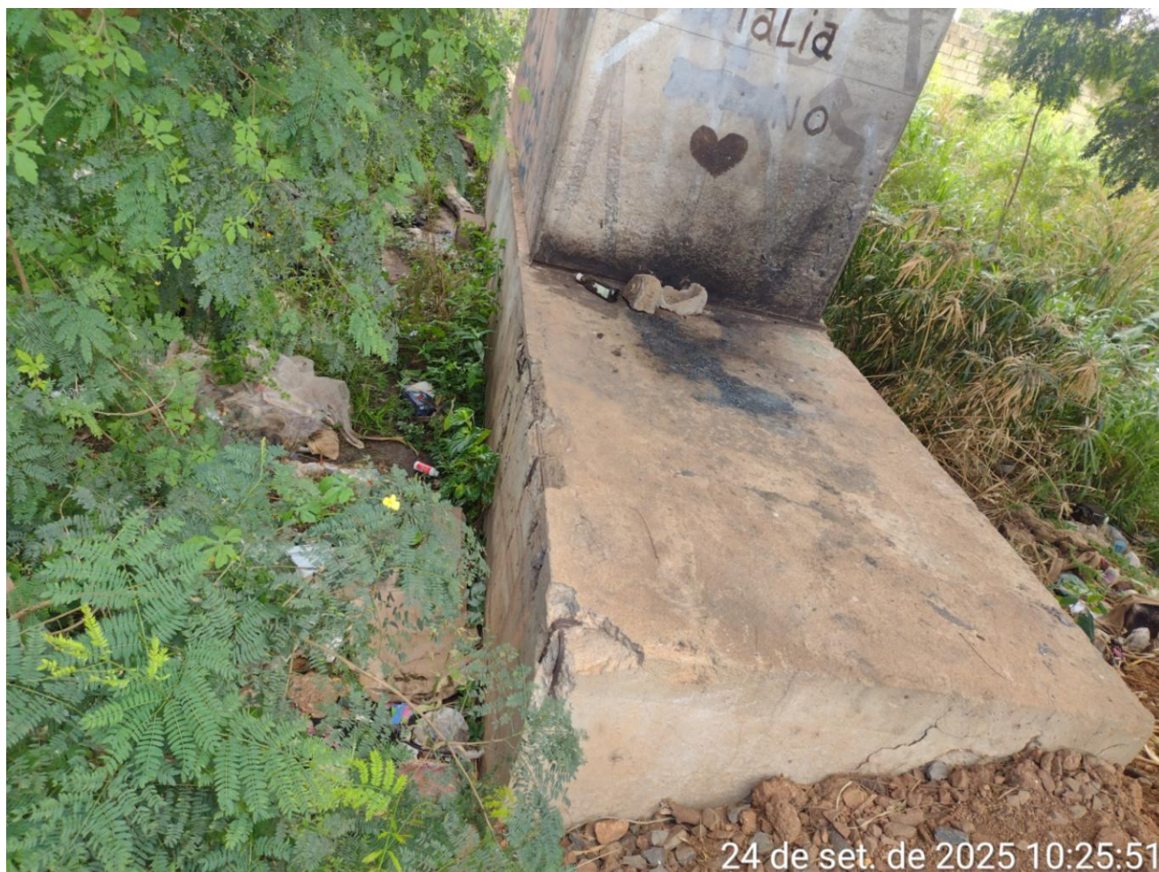
Figura 36 - Marcas de fogo na estrutura
