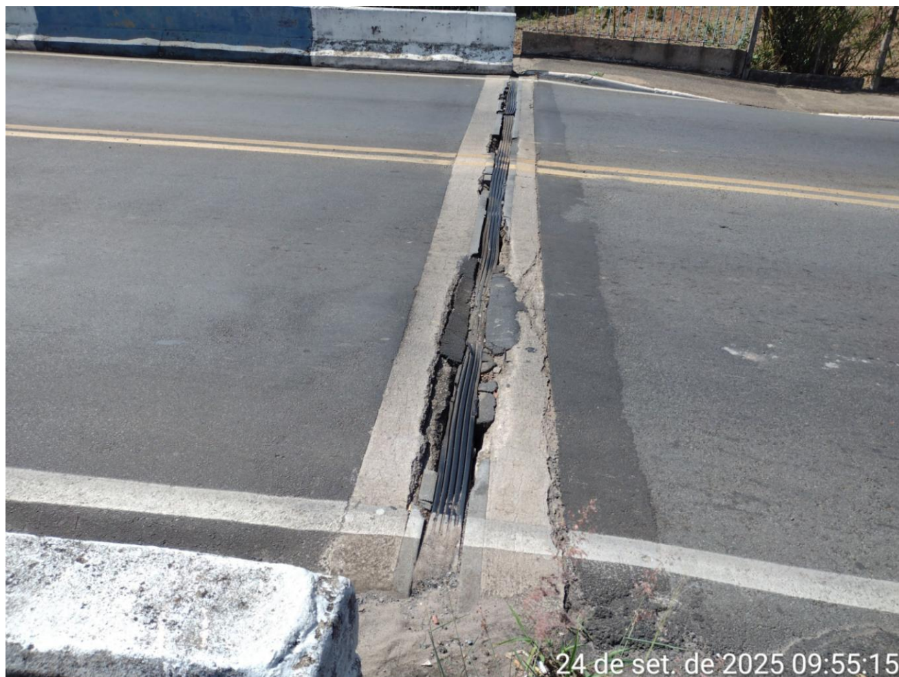
Figura 4 - Juntas de dilatação apresentam sinais de degradação
