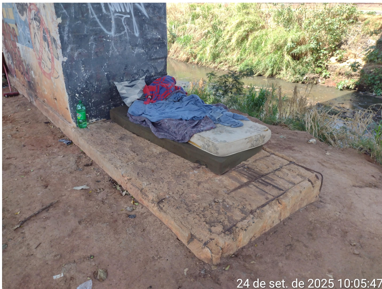
Figura 31 - Blocos de fundação com armadura exposta
