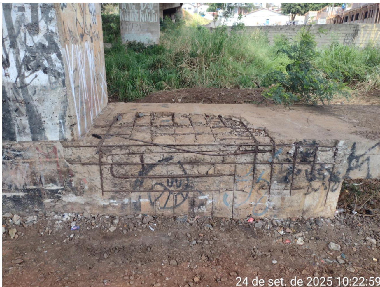
Figura 34 - Blocos de fundação com armaduras expostas
