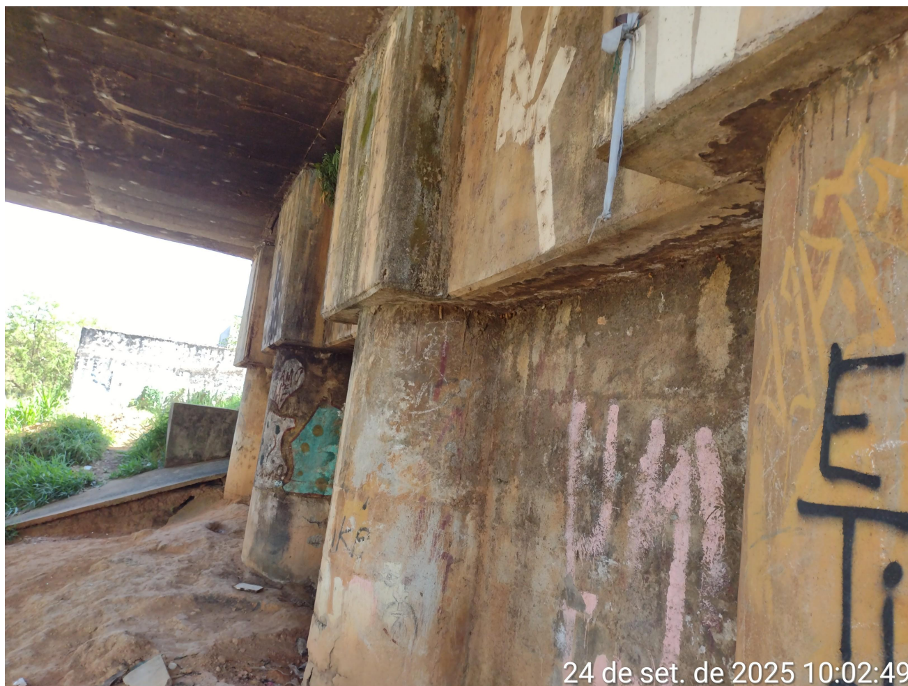
Figura 23 - Ausência de aparelhos de apoio
