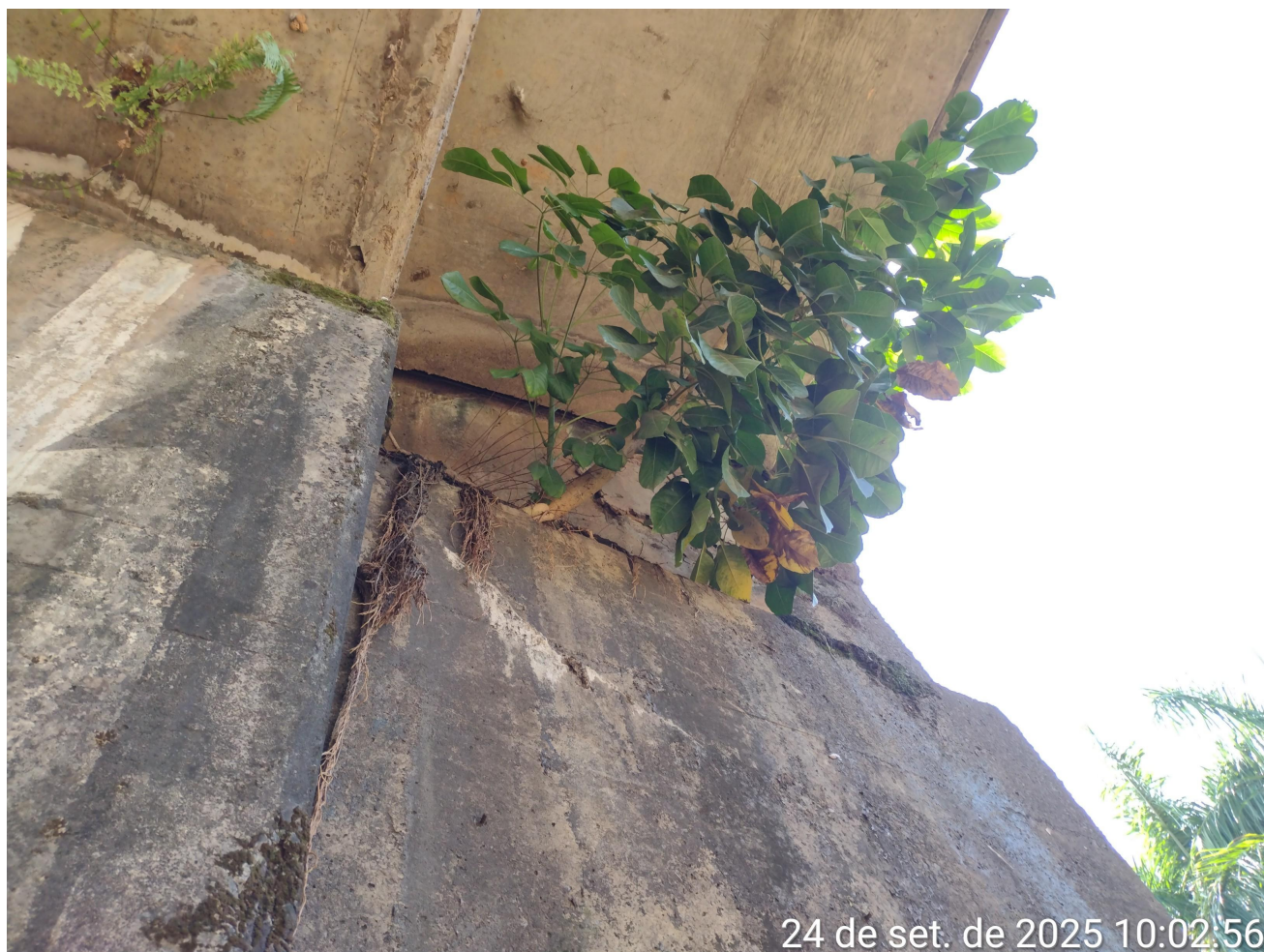
Figura 21 - Vegetação crescendo entre os elementos da estrutura
