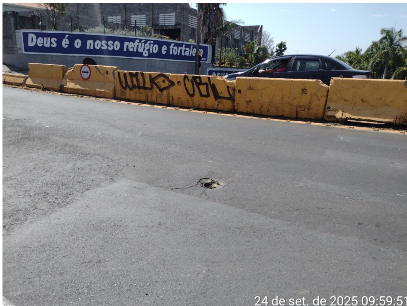
Figura 10 - Registro da concessionária exposto
