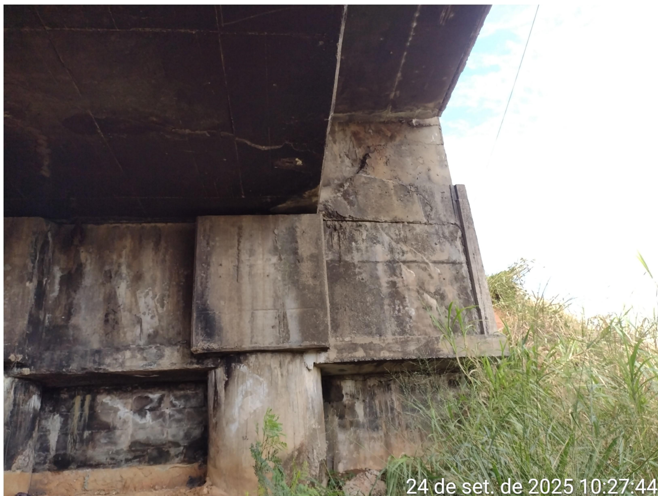
Figura 41 - Estrutura deteriorada por intempéries e ações humanas
