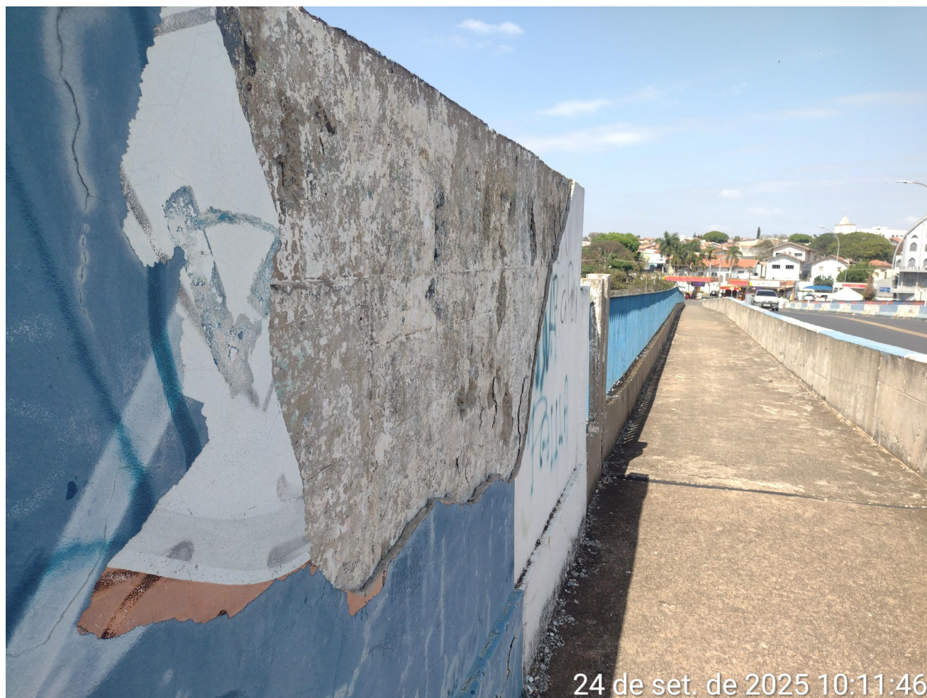
Figura 16 - Muretas com rebocos danificados, vandalizados e pinturas desgastadas
