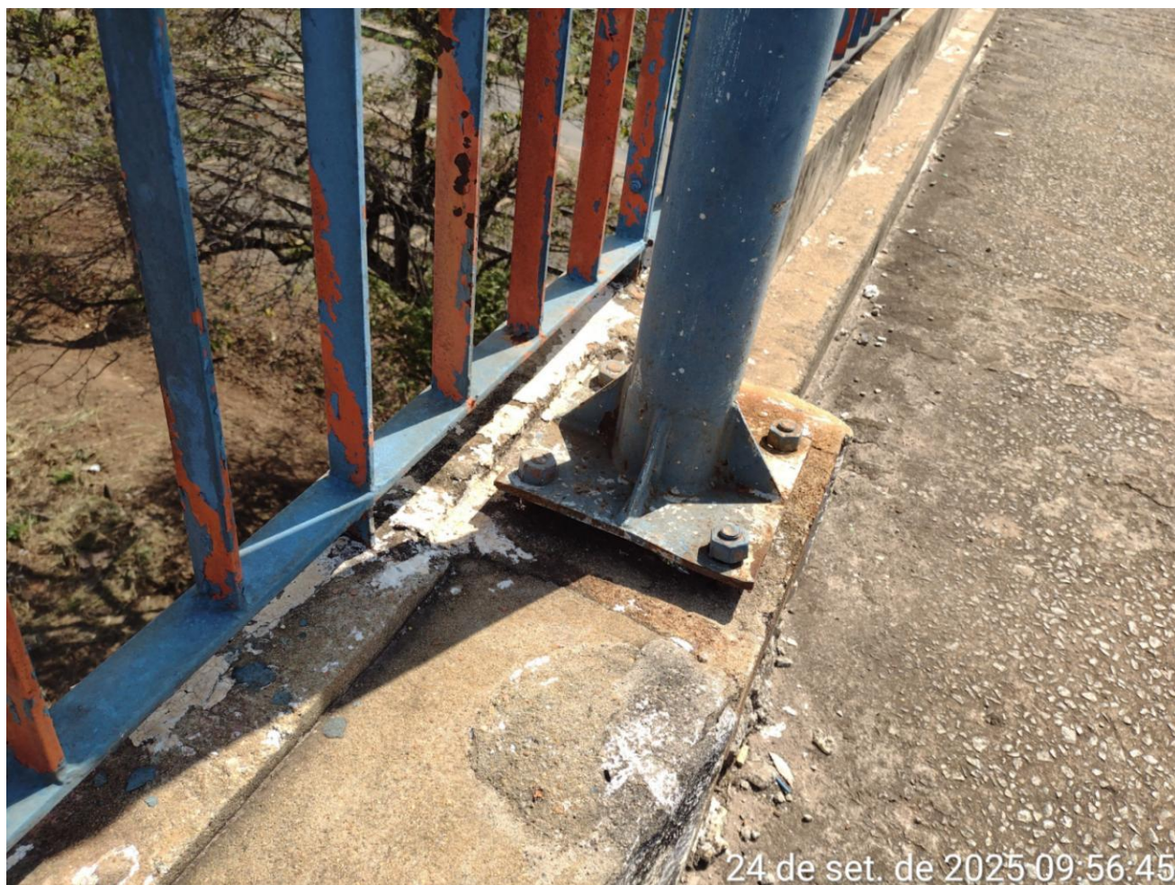
Figura 13 - Postes de iluminação com as bases vandalizadas
