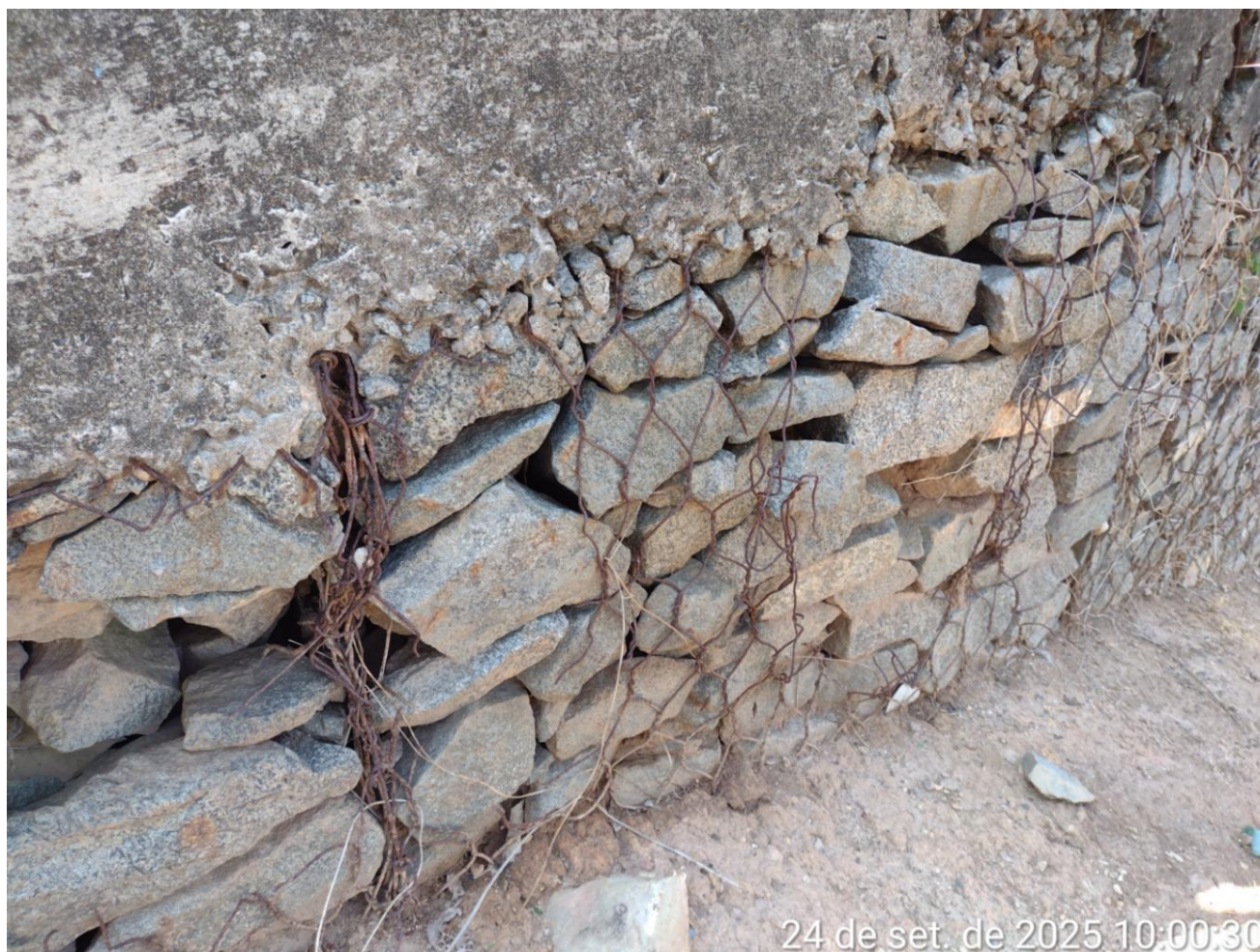
Figura 18 - Contenção lateral em gabião com as gaiolas deterioradas
