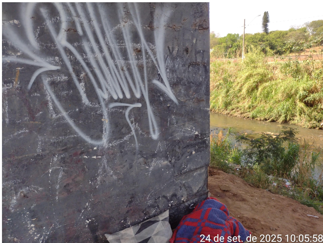
Figura 30 - Bases dos pilares com armadura exposta
