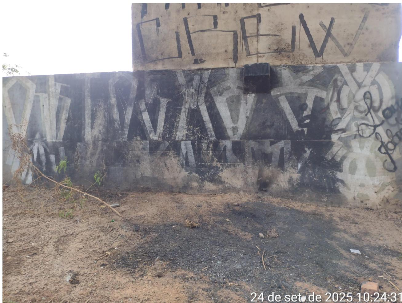
Figura 37 - Marcas de fogo na estrutura
