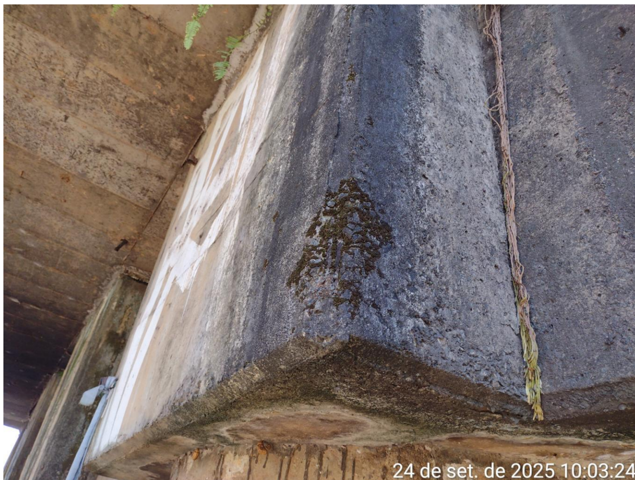
Figura 24 - Presença de umidade na estrutura
