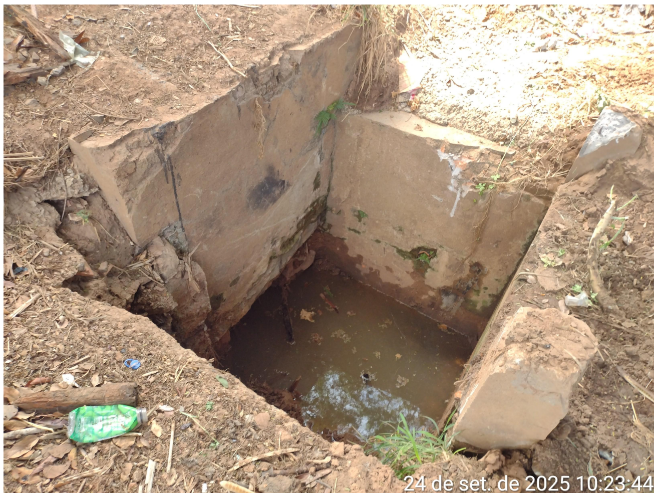
Figura 39 - Sedimentação e água parada dentro de galeria
