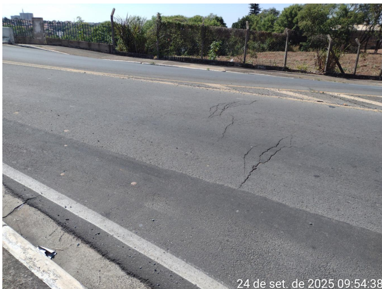
Figura 1 Fissura longitudinal na laje de aproximação do tabuleiro
