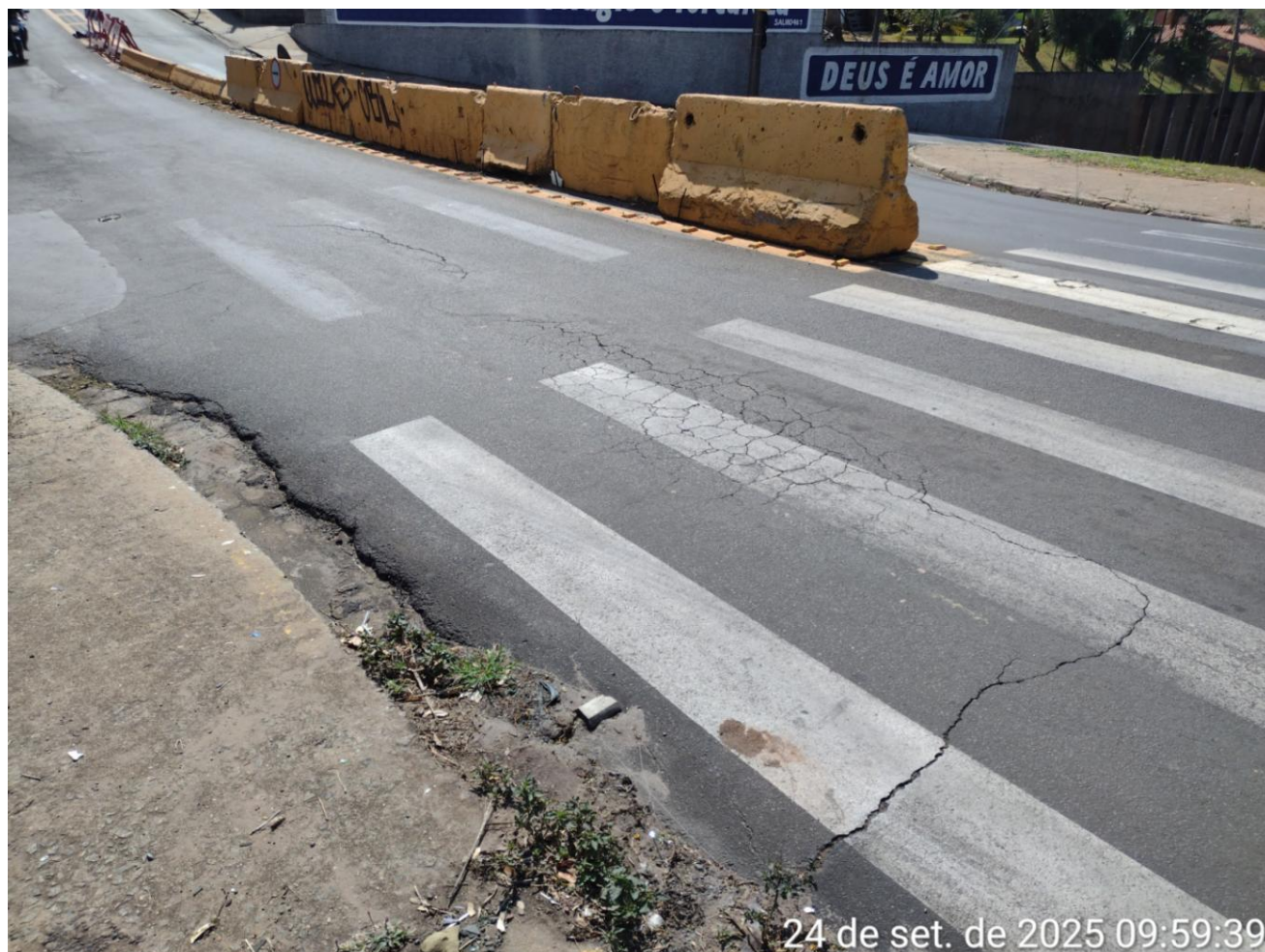
Figura 6 - sinais de couro de jacaré e fissuras no pavimento na laje de aproximação do tabuleiro
