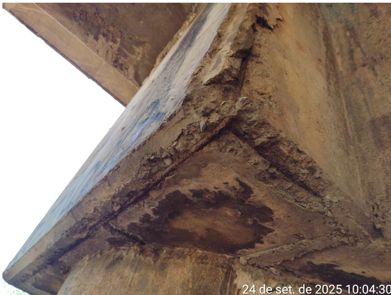
Figura 26 - Exposição de armadura
