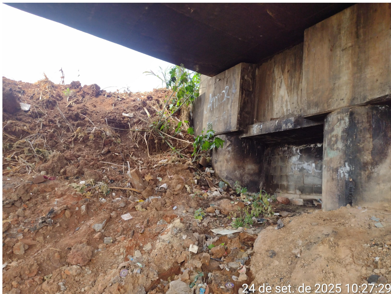
Figura 40 - Cabeceira sem contenção lateral do solo
