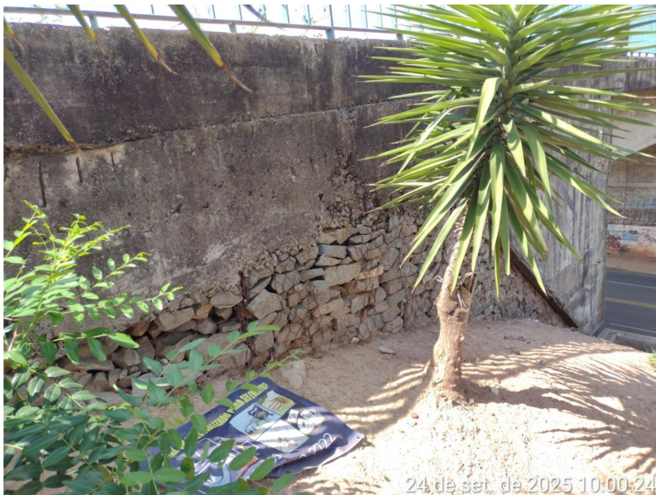
Figura 17 - Contenção lateral em gabião com as gaiolas deterioradas
