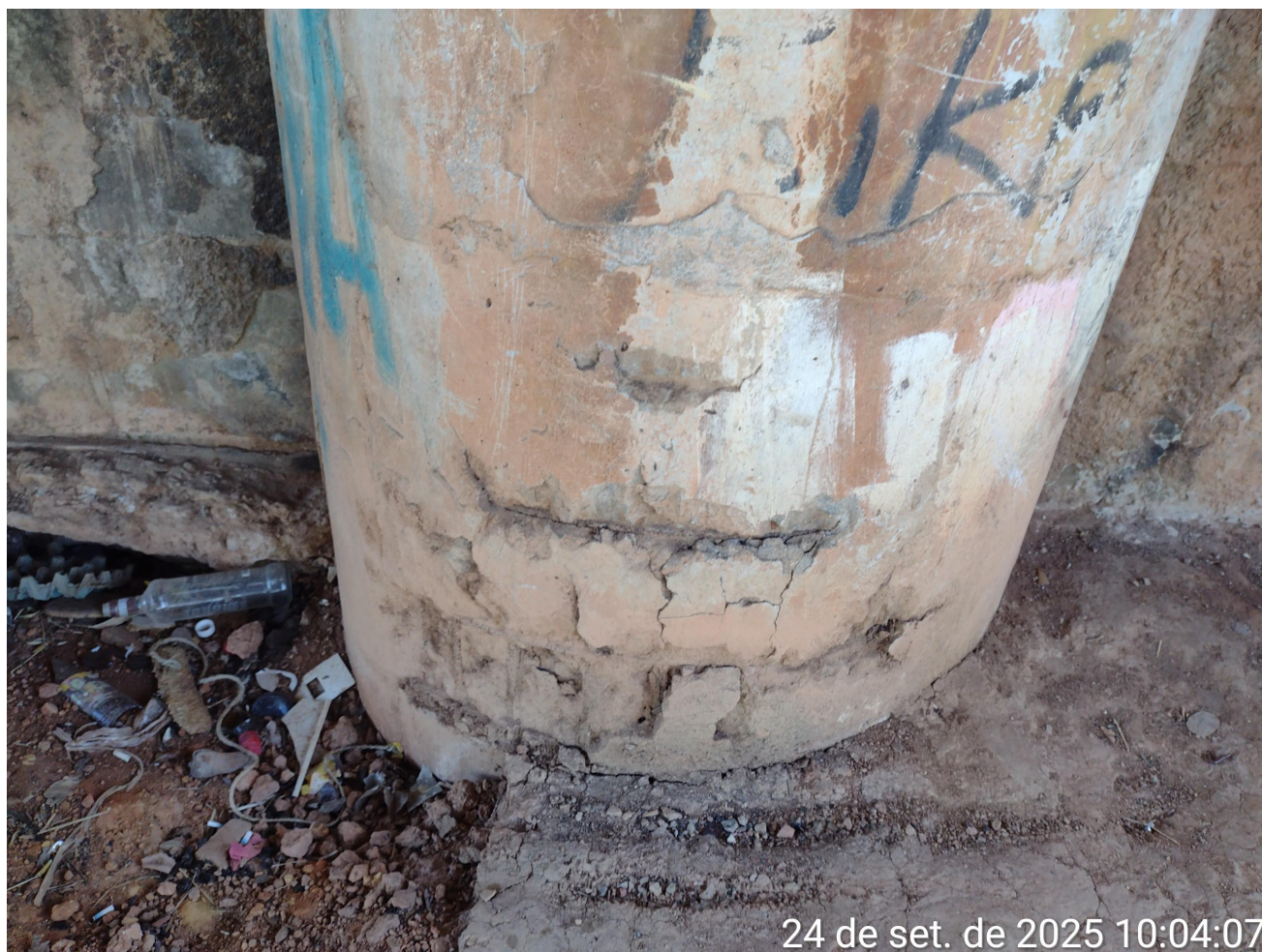
Figura 27 - Exposição de armadura
