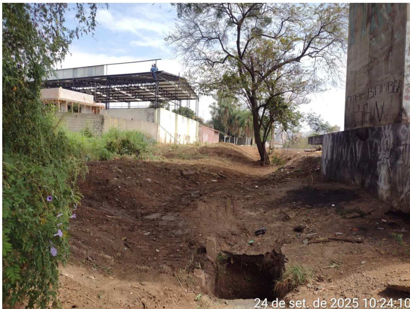
Figura 38 - Carreamento de solo para dentro da galeria
