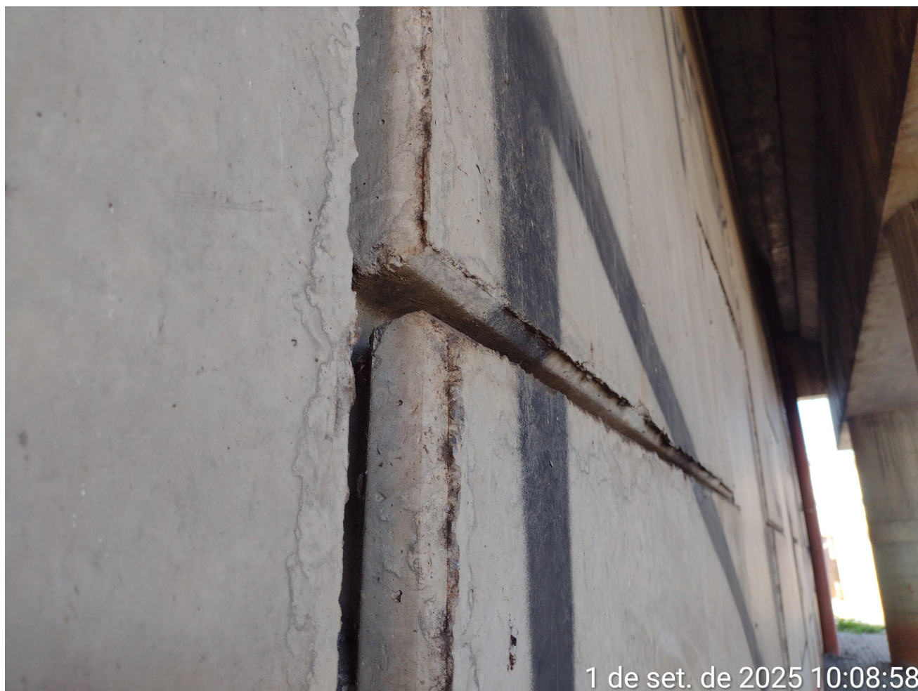
Figura 11 Desalinhamento das placas de contensão, de concreto, do talude
