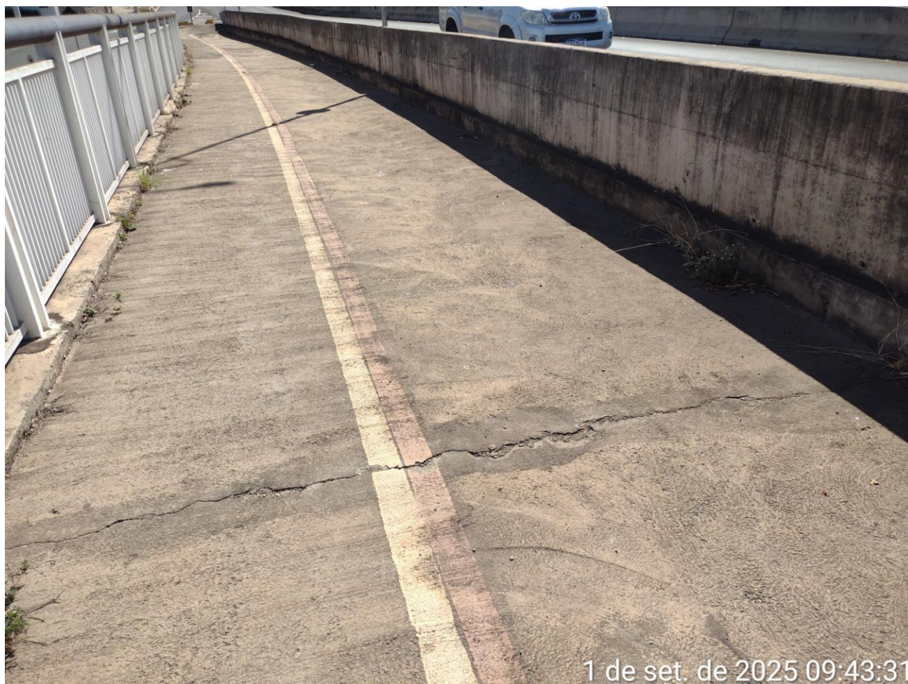
Figura 5 fissuras aparentes na passagem de pedestres e ciclistas
