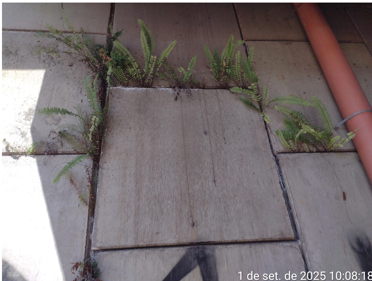
Figura 10 Vegetação crescendo entre as placas, de concreto, de contenção de talude e estrutura do viaduto
