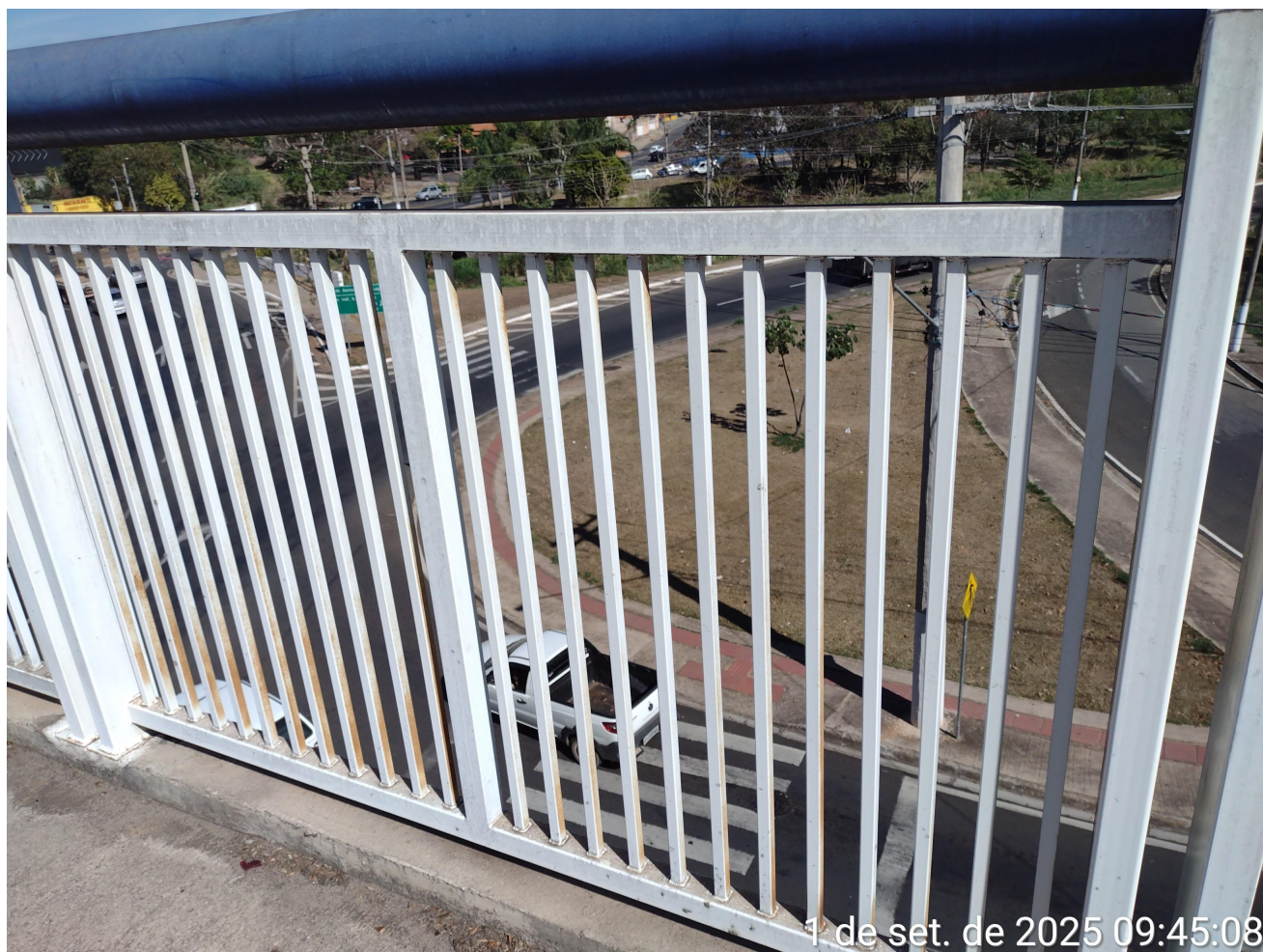
Figura 7 Gradis com sinais de desgaste por intempéries
