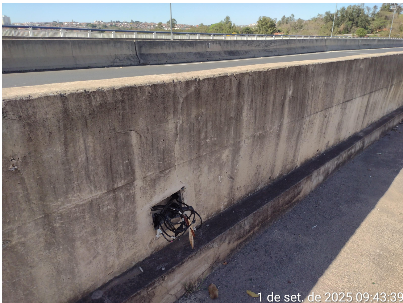
Figura 8 fiação aparente da iluminação
