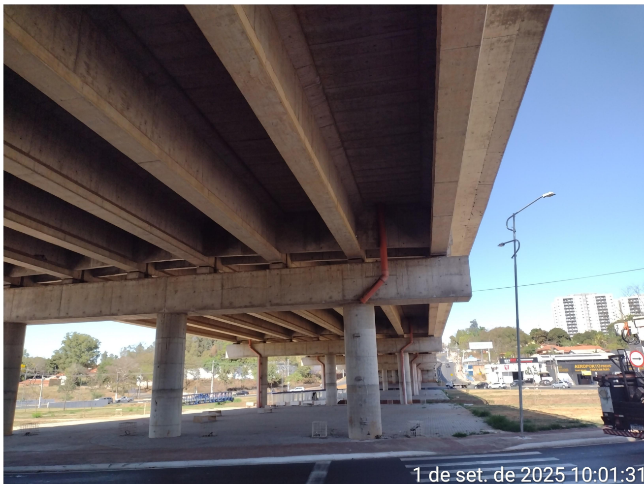
Figura 12 Tubulação de drenagem danificada devido a um acidente
