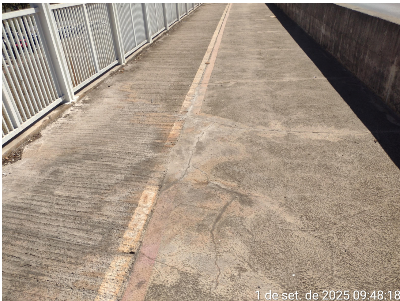
Figura 6 fissuras na passagem de pedestres e ciclistas em ambos os lados
