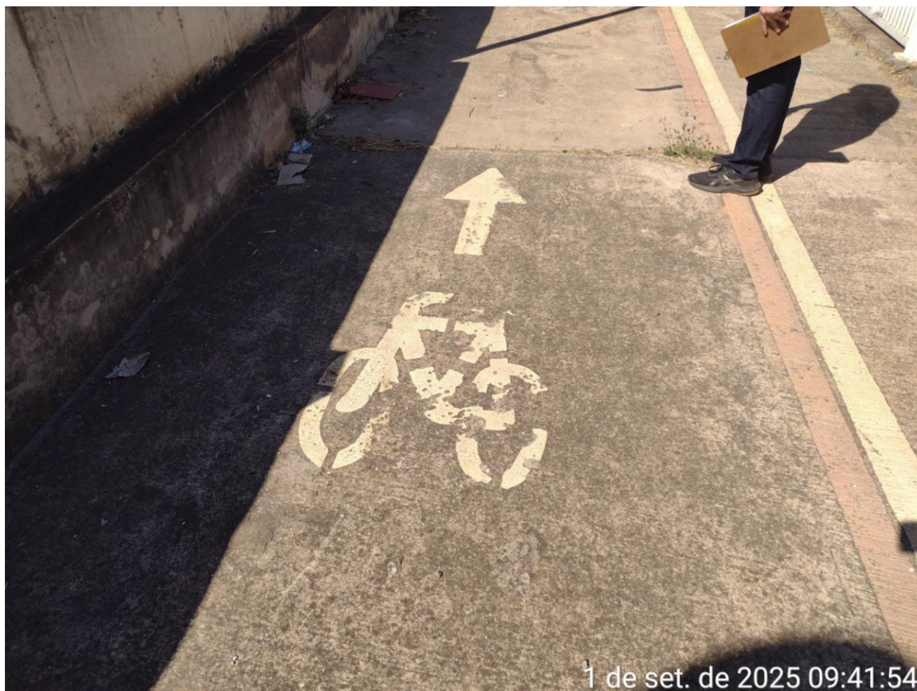
Figura 3 pintura da ciclovia com desgastes por intempéries
