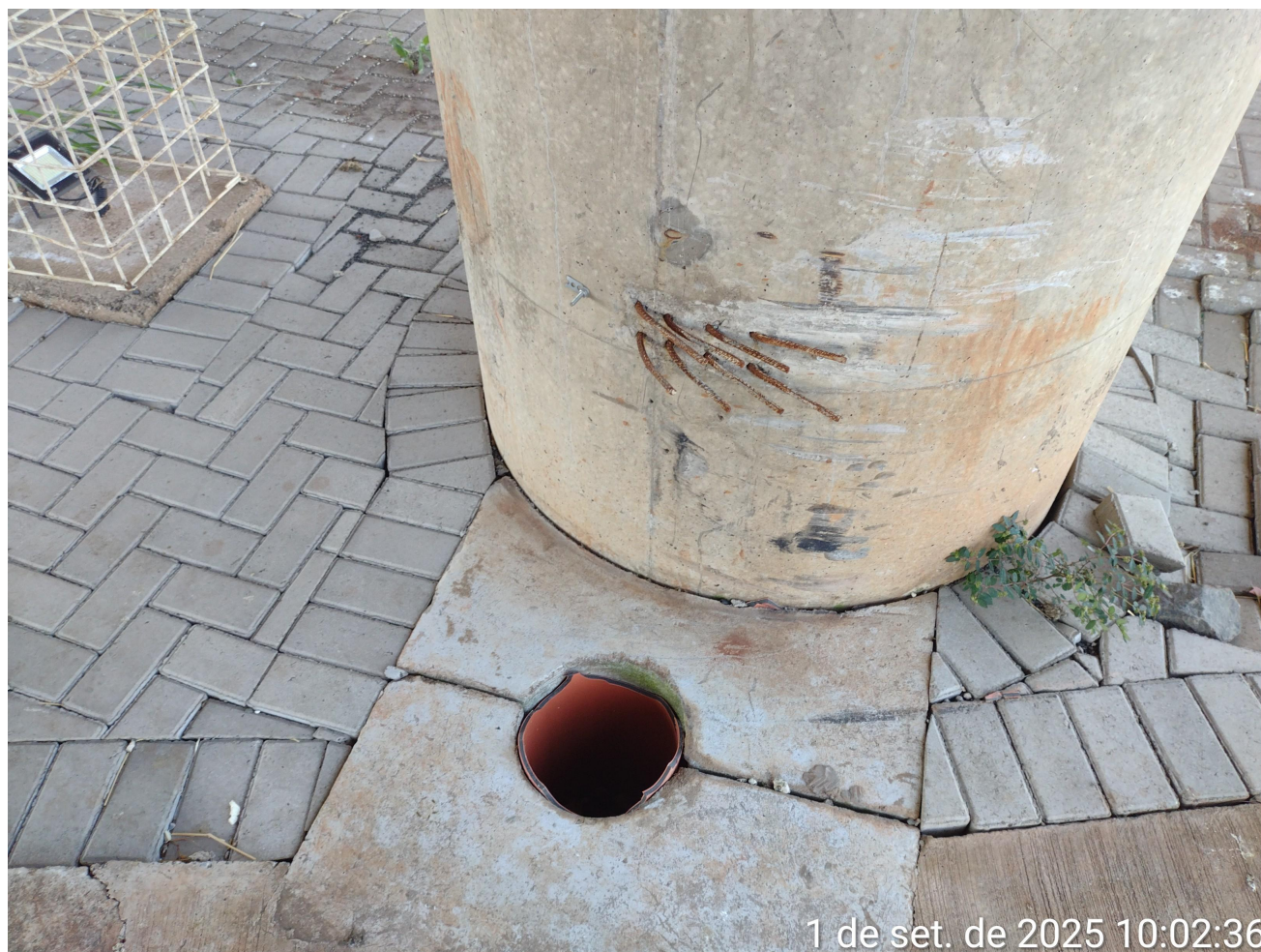
Figura 13 Tubulação de drenagem danificada devido a um acidente
