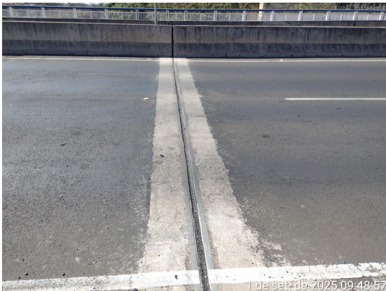
Figura 2 Juntas de dilatações, sem patologias
