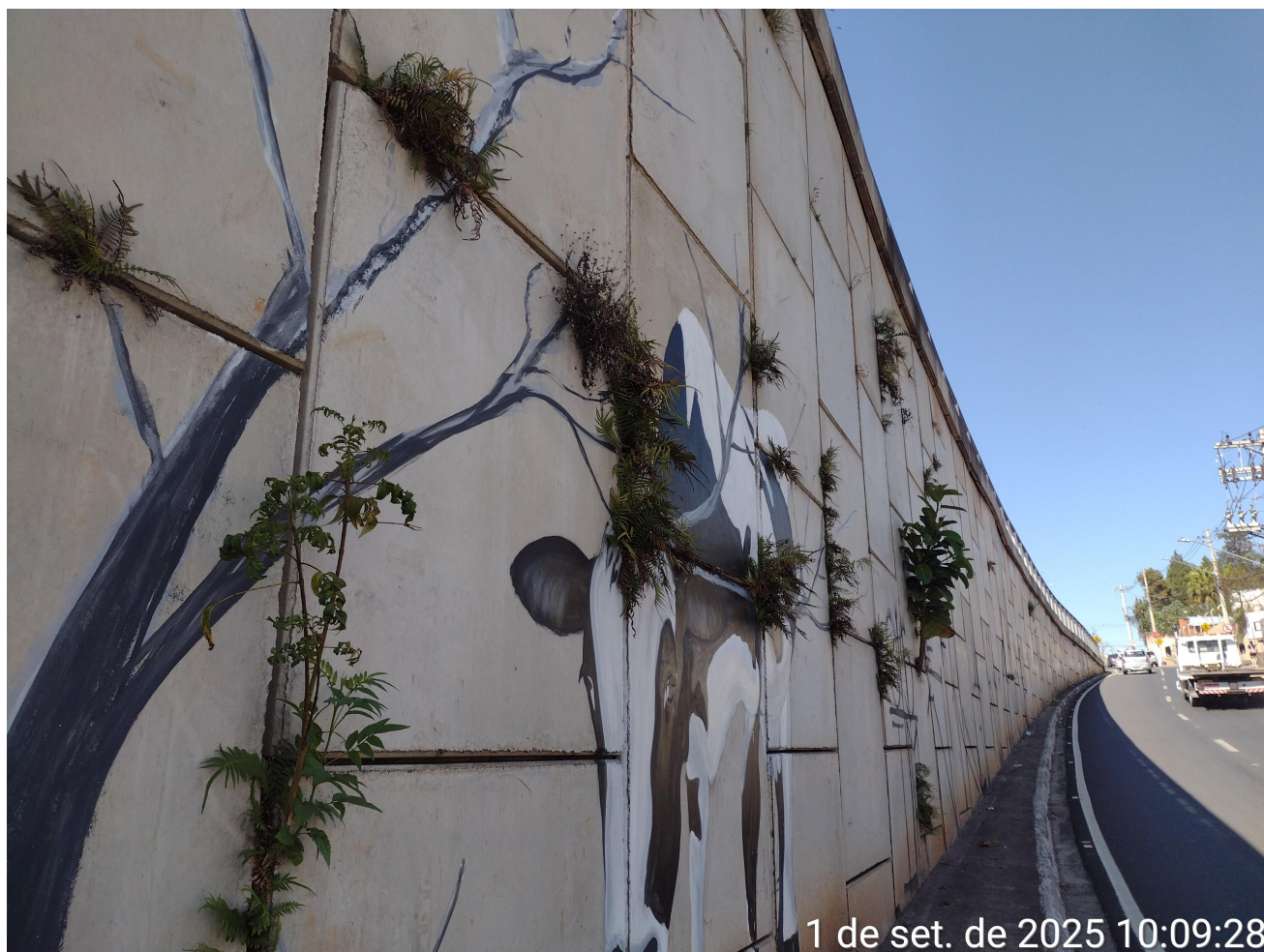
Figura 9 Vegetação crescendo entre as placas, de concreto, de contenção de talude e estrutura do viaduto
