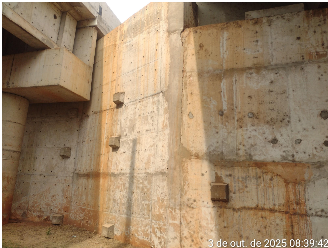
Figura 13 - Pontos de fissuração na contenção do aterro com sinais de intervenções
