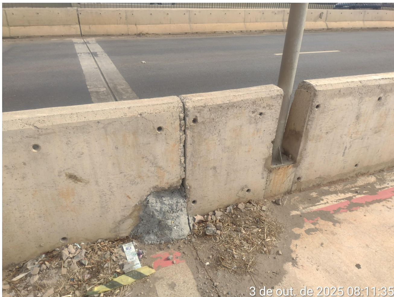
Figura 8 - Zeladoria insuficiente e danos nas barreiras de proteção de concreto
