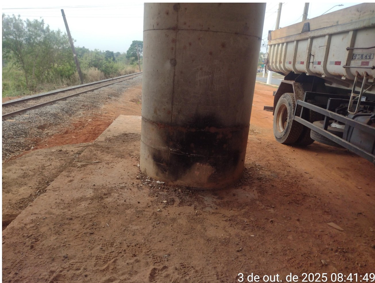
Figura 19 - Marcas de fogo no pé do pilar
