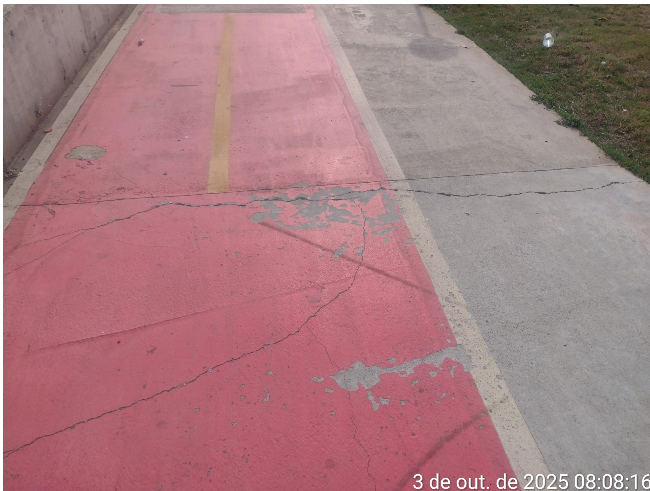
Figura 5 - Calçadas fissuradas, sem juntas de dilatação no intervalo esperado e pintura desgastada
