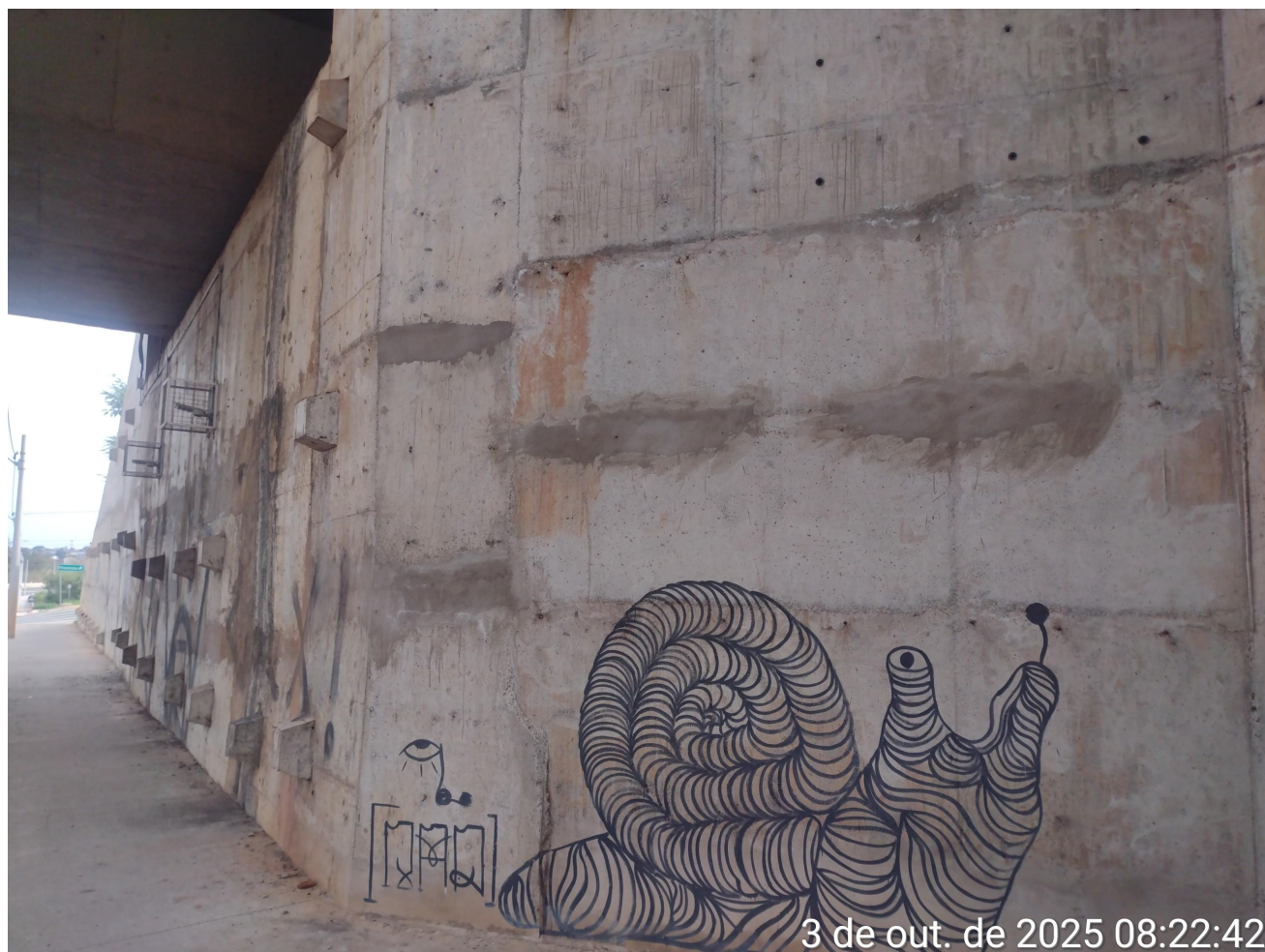
Figura 12 - Pontos de fissuração na contenção do aterro com sinais de intervenções
