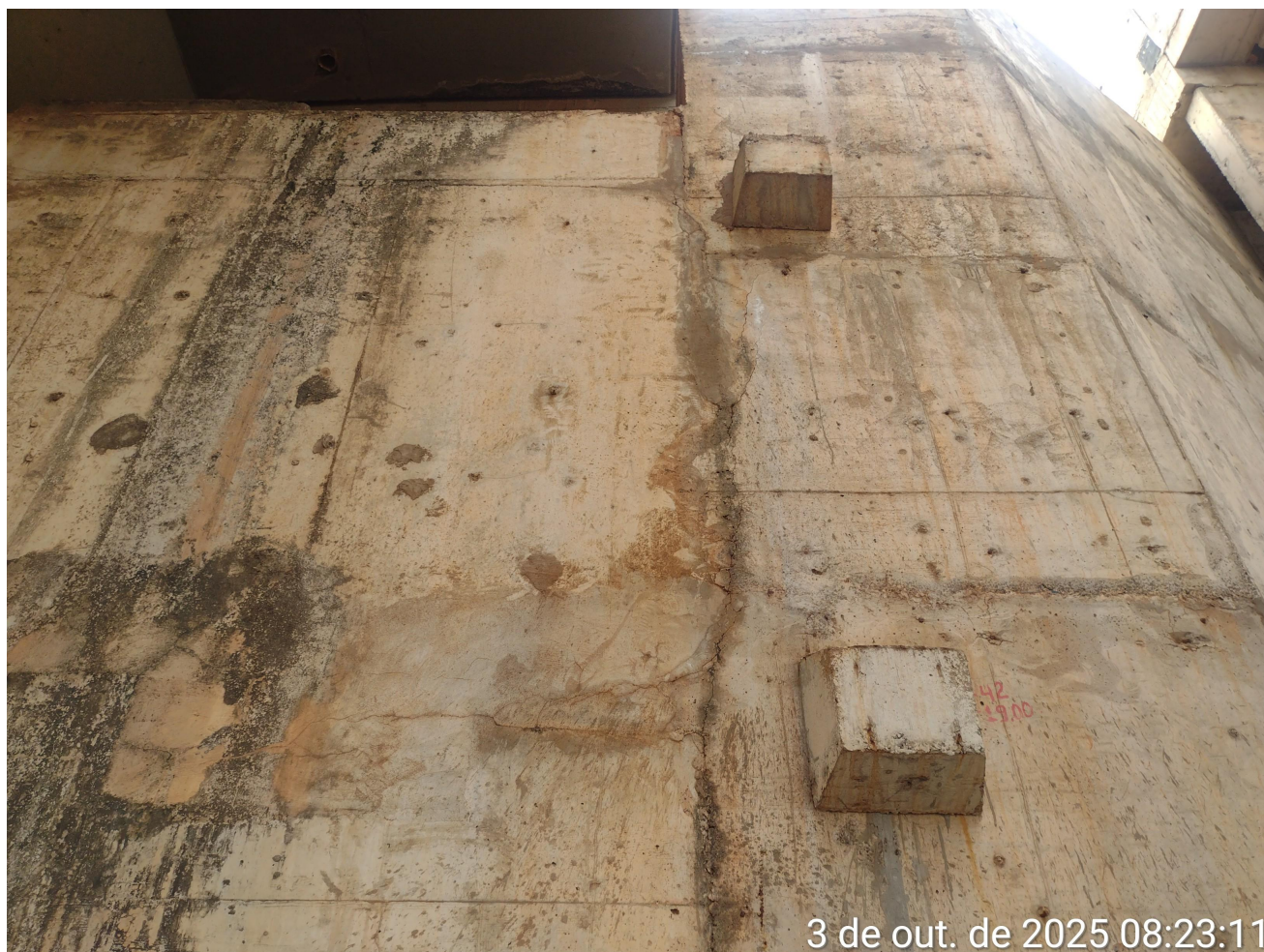
Figura 14 - Pontos de umidade ao longo da contenção e pontos de fissuras com alguns sinais de intervenções
