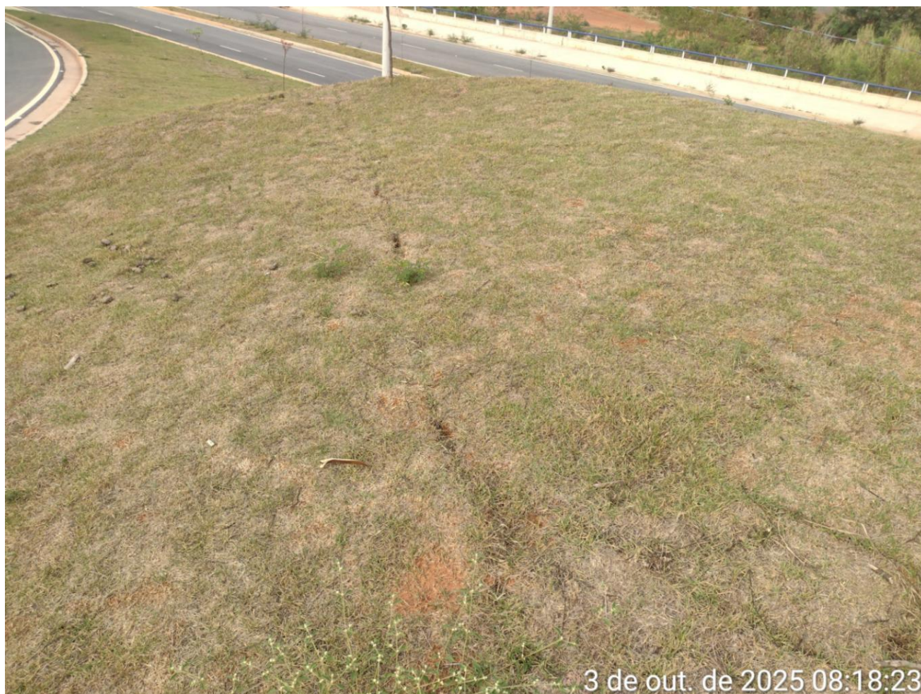
Figura 10 - Pontos de fissuração no aterro
