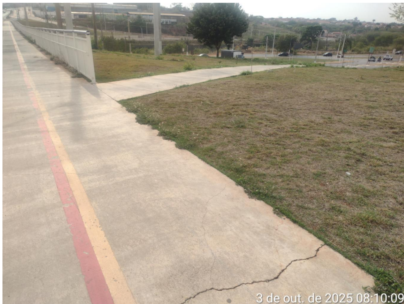
Figura 6 - Calçadas fissuradas, sem juntas de dilatação no intervalo esperado
