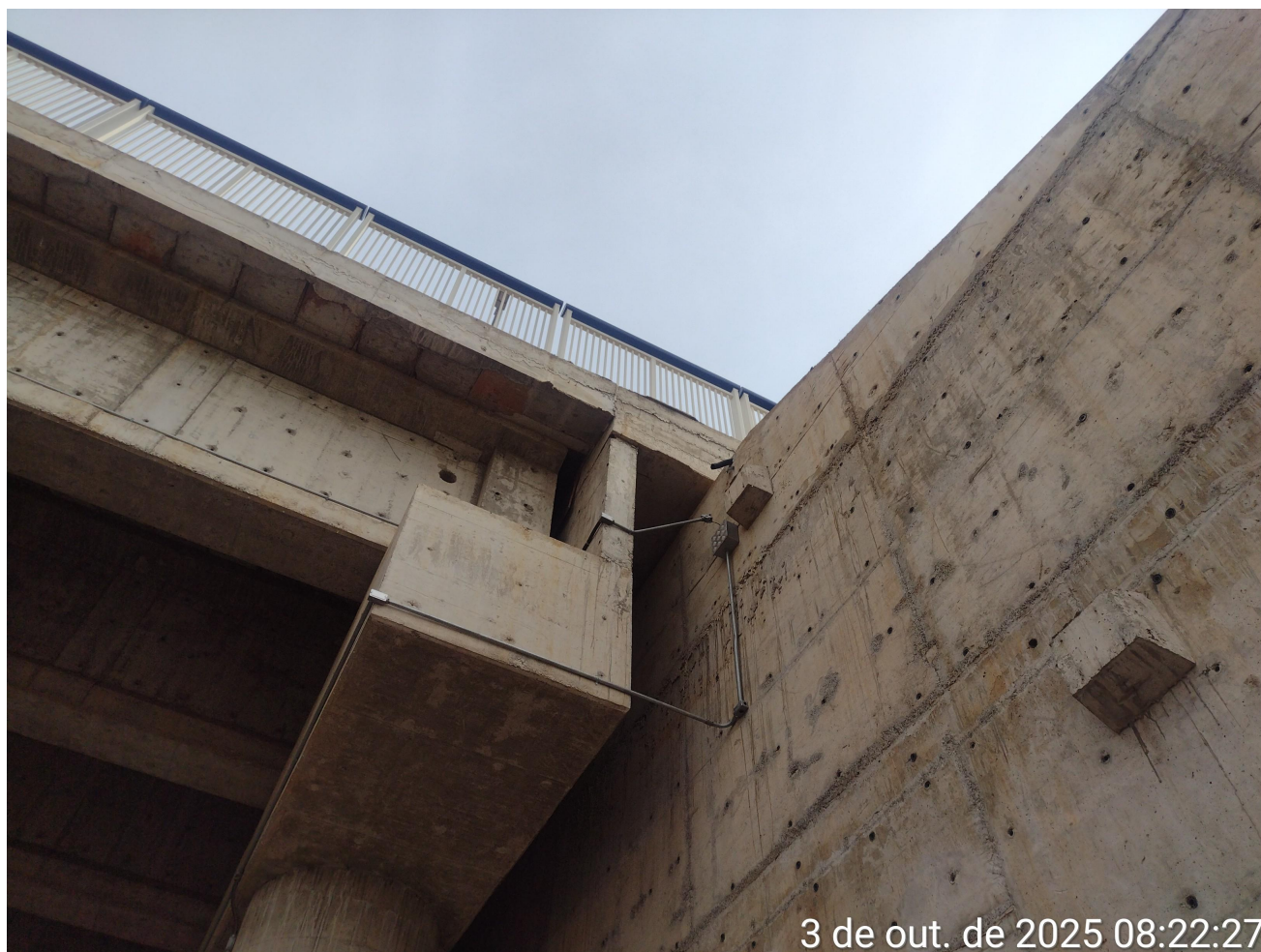
Figura 11 - Ponto de fiação elétrica exposto
