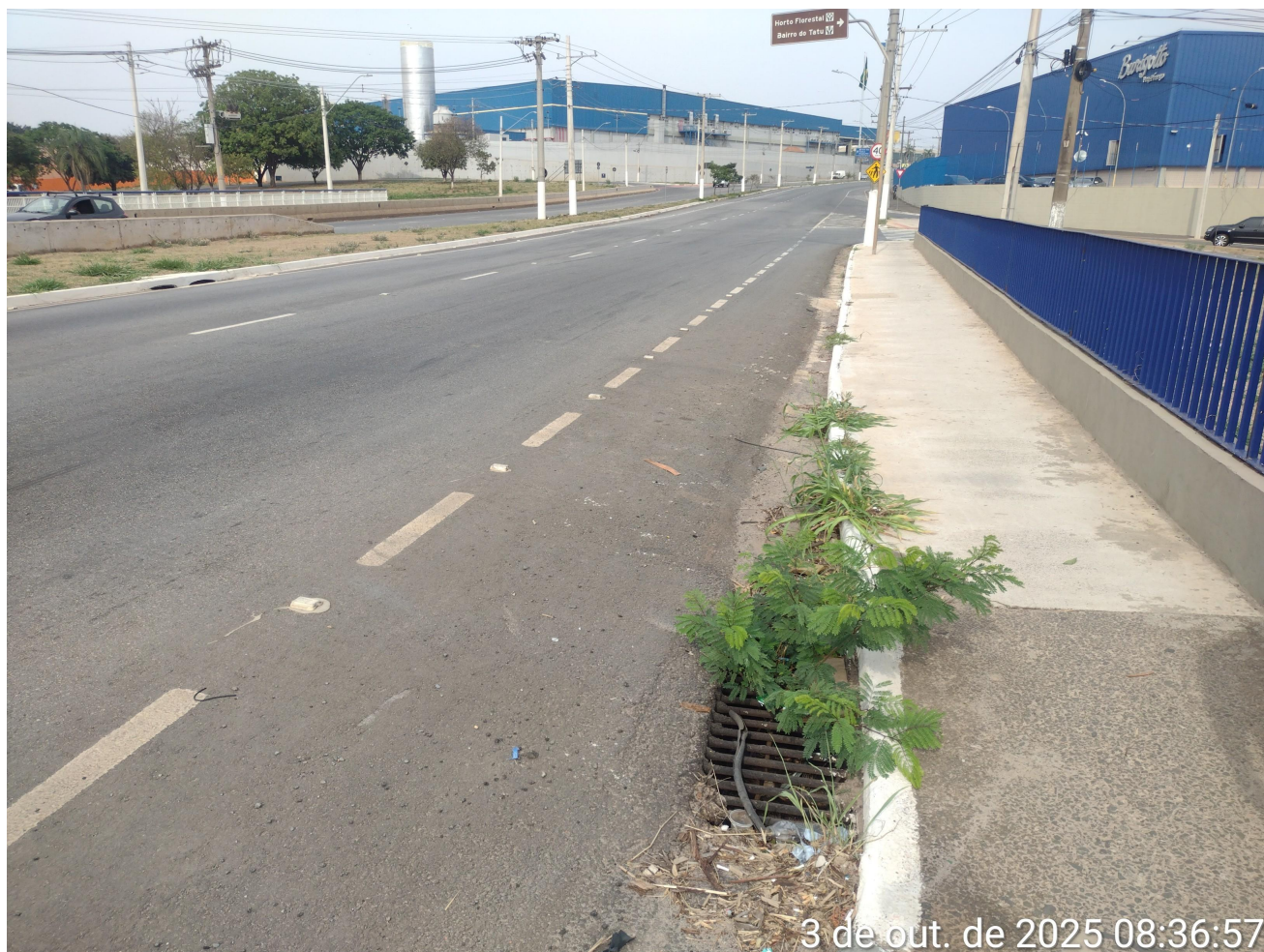
Figura 4 - Vegetação crescendo ao longo do pavimento, podendo causar danos à estrutura
