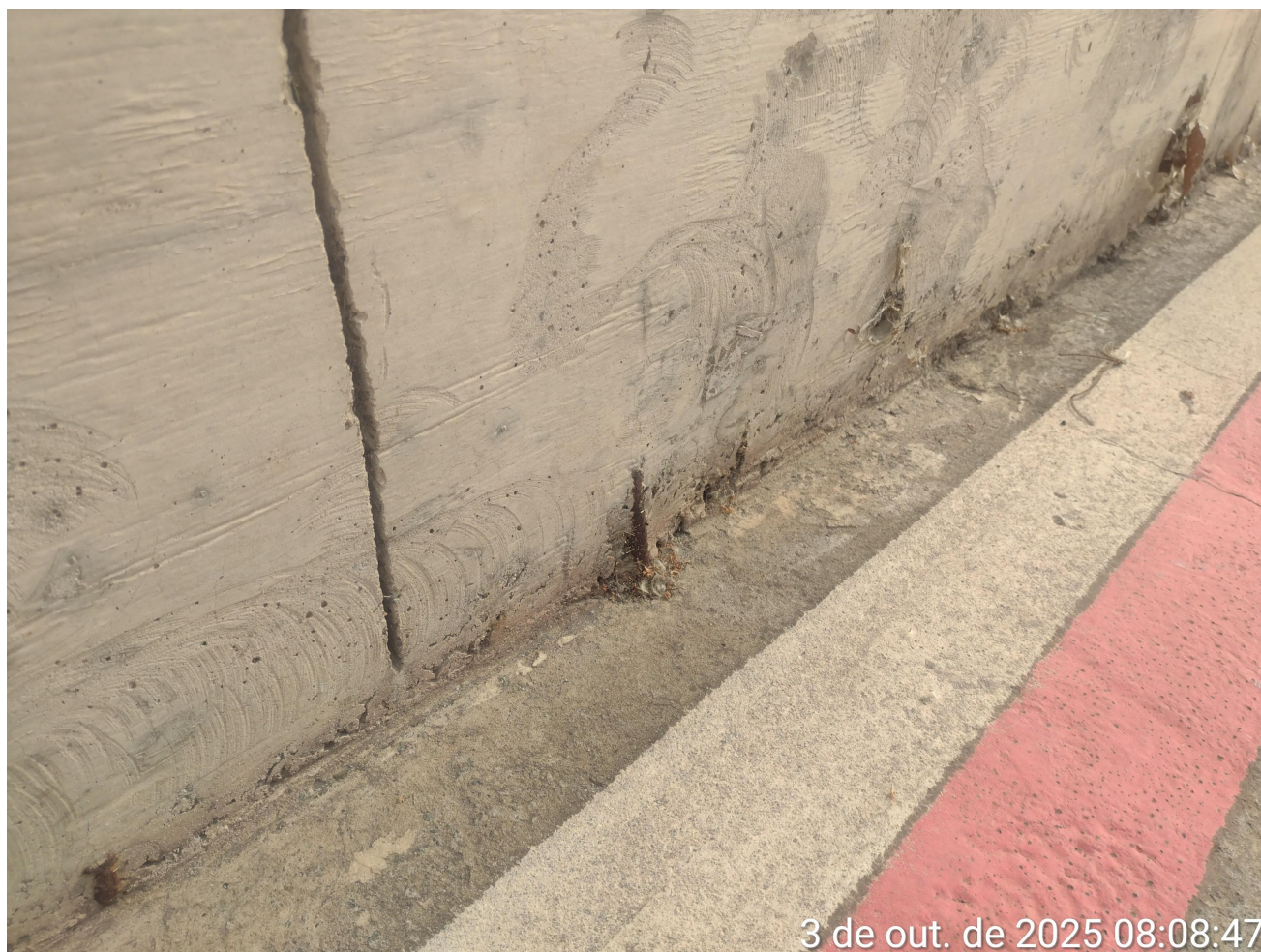
Figura 7 - Armadura exposta nos New Jerseys ao longo da calçada
