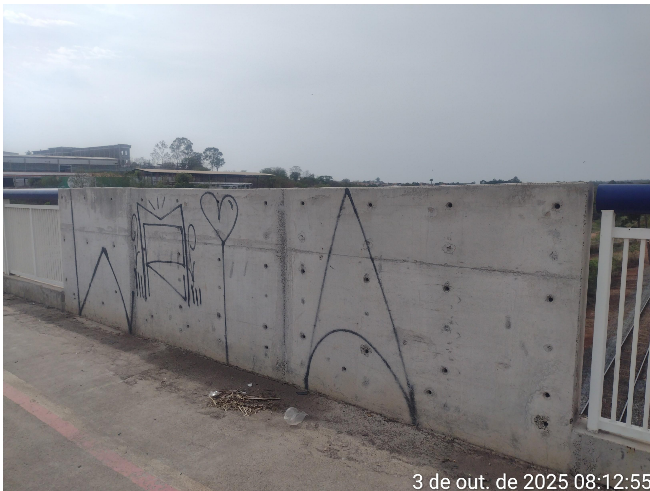
Figura 9 - Muros de proteção vandalizados
