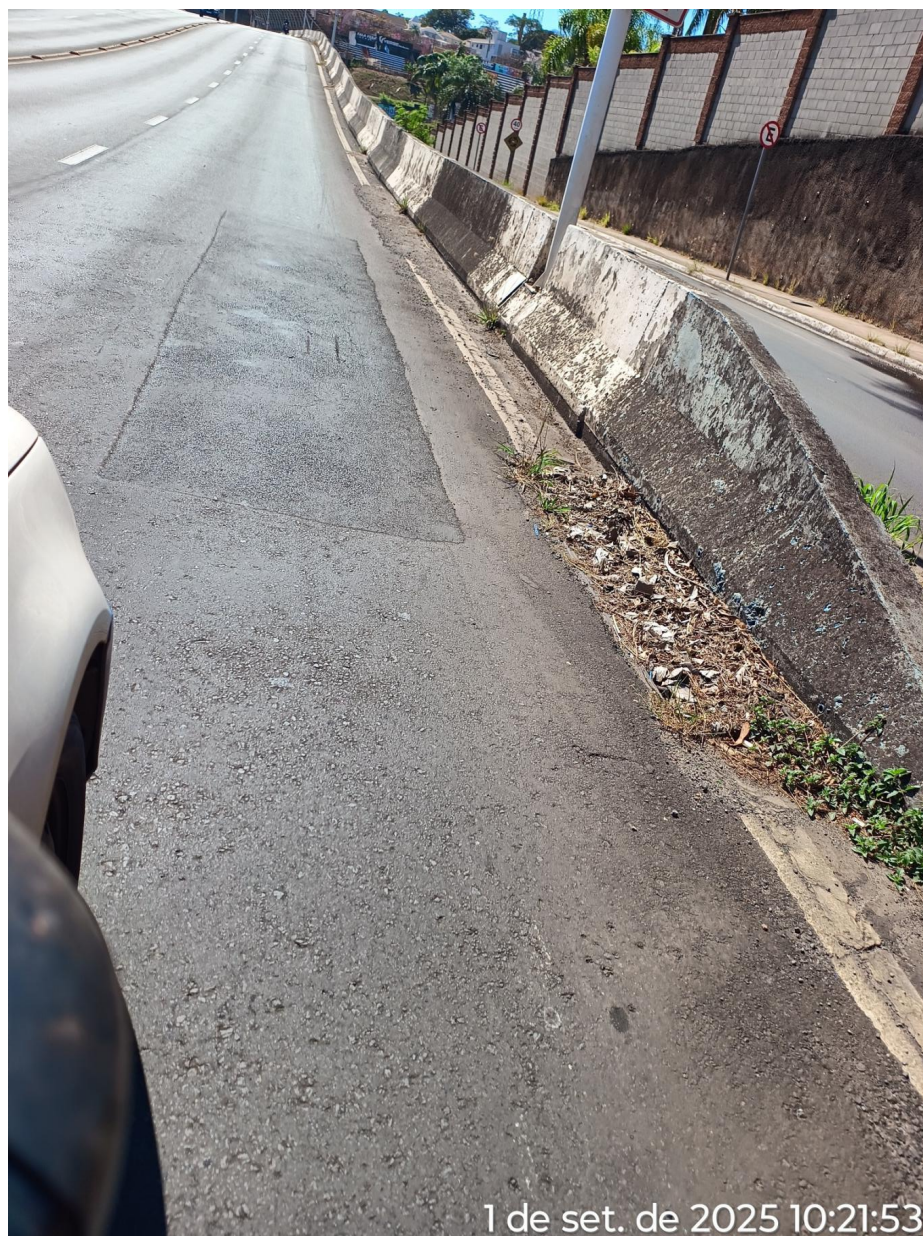
Figura 1 - O pavimento apresenta ações corretivas de tapa buraco, no aterro de aproximação
