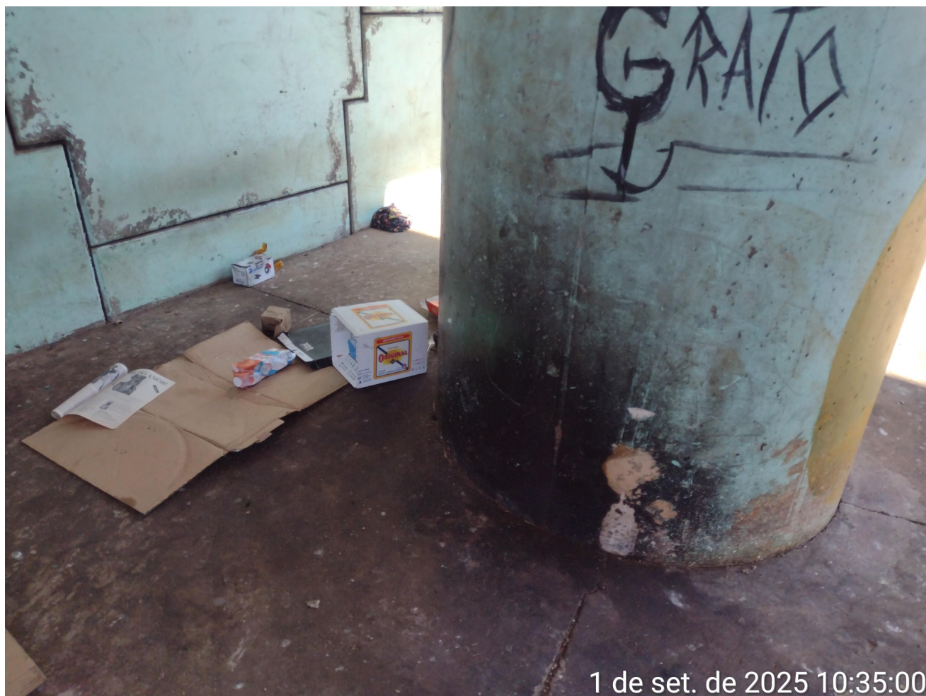
Figura 14 - Marcas de ação de fogo nos pilares
