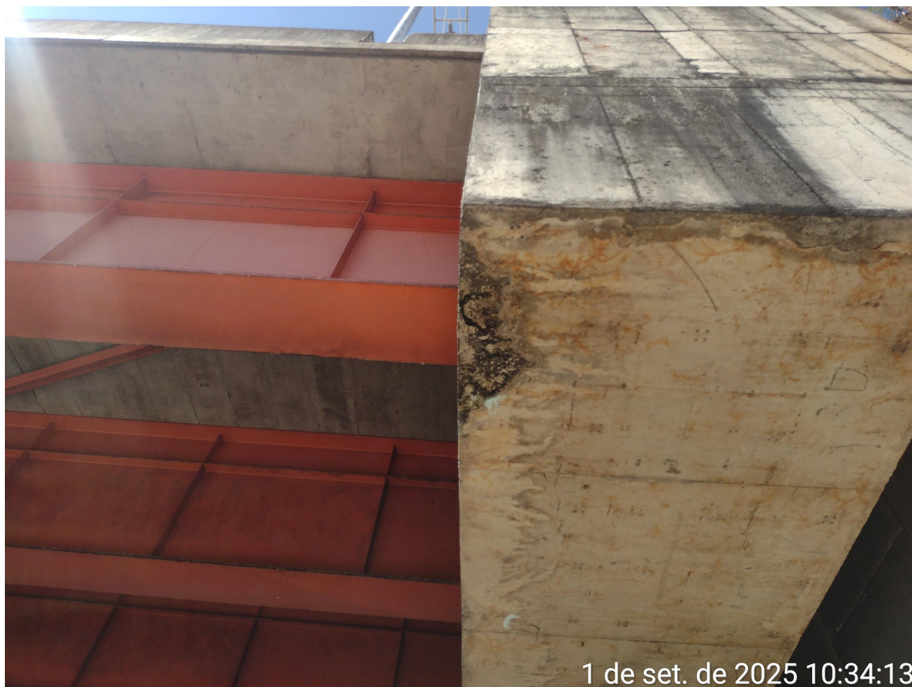
Figura 13 - Marcas de umidade pontual em uma das cabeceiras através da junta de dilatação
