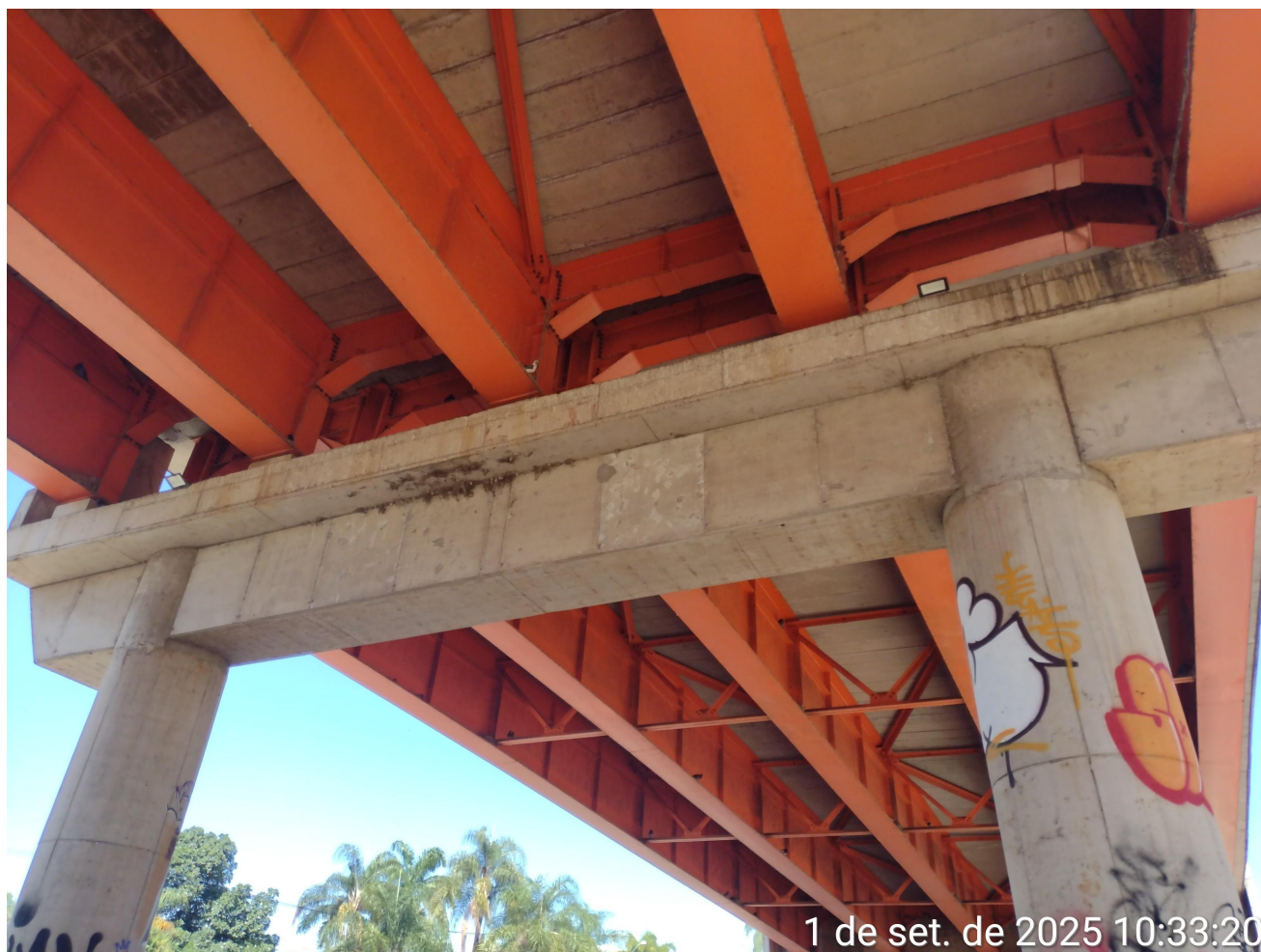
Figura 16 - Marcas pontuais de umidade através das juntas de dilatação
