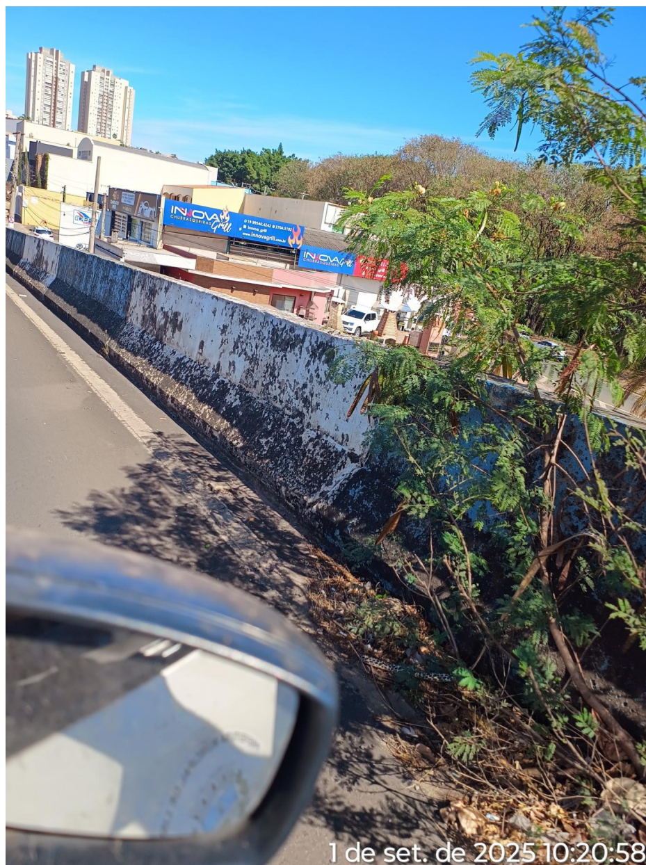
Figura 5 - Vegetação crescendo ao longo da estrutura do viaduto
