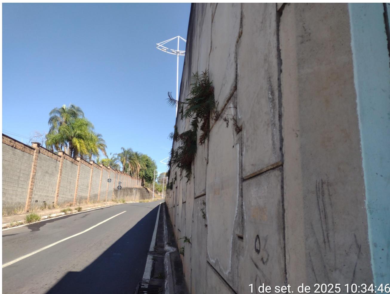
Figura 11 - Vegetação crescendo na encosta da contenção
