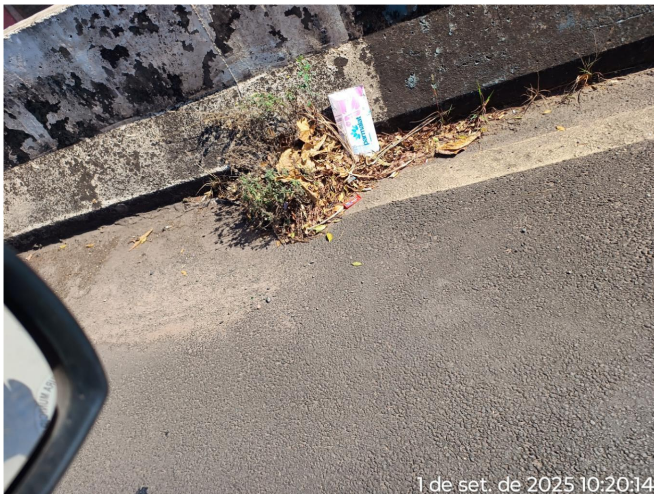
Figura 4 - Vegetação crescendo ao longo da estrutura do viaduto
