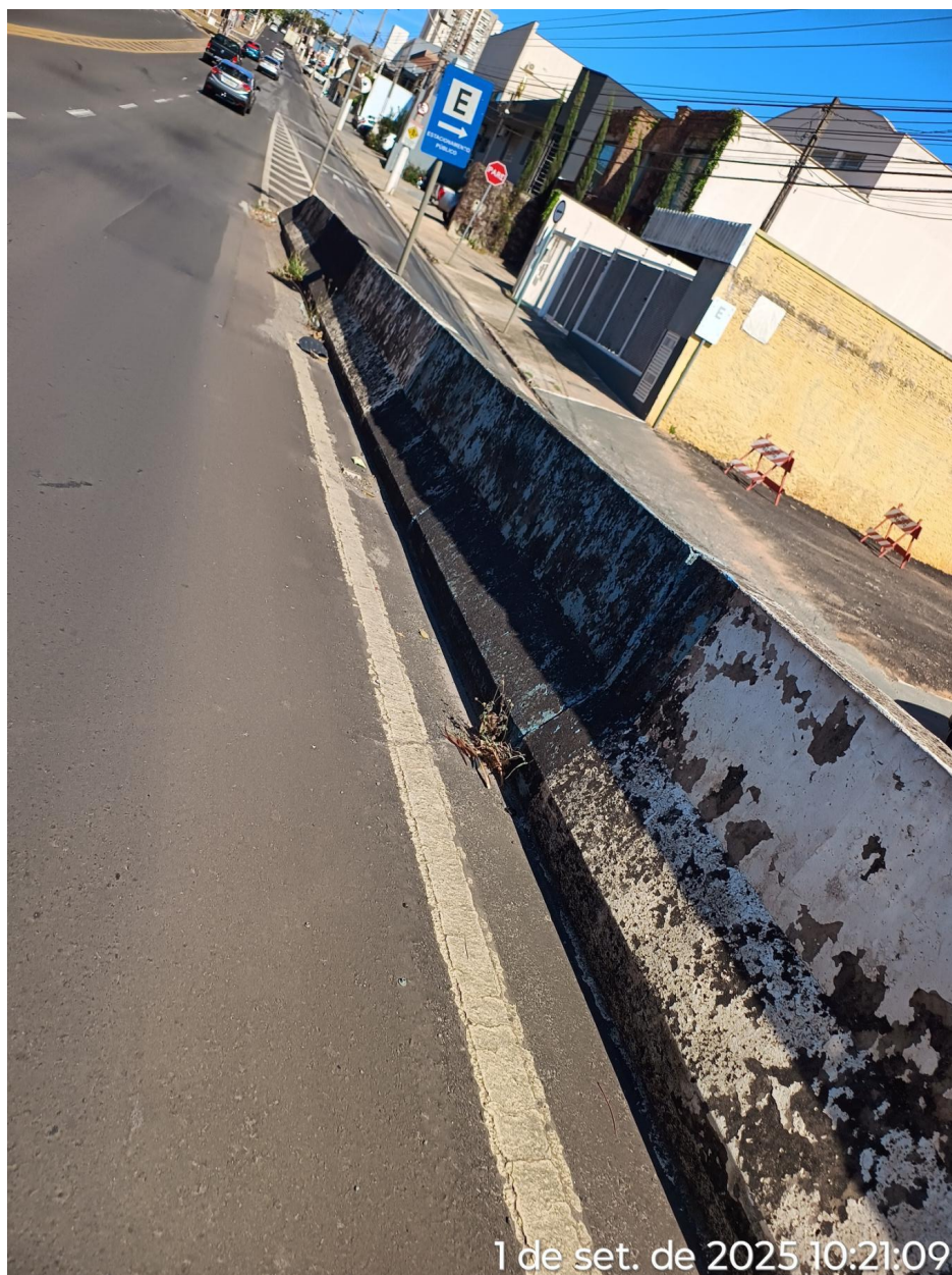
Figura 6 - New Jersey apresenta desgaste por intempéries
