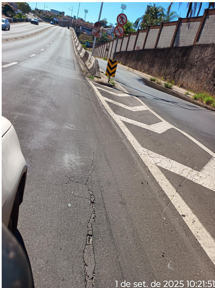
Figura 2 - Fissurações em malha tipo couro de jacaré
