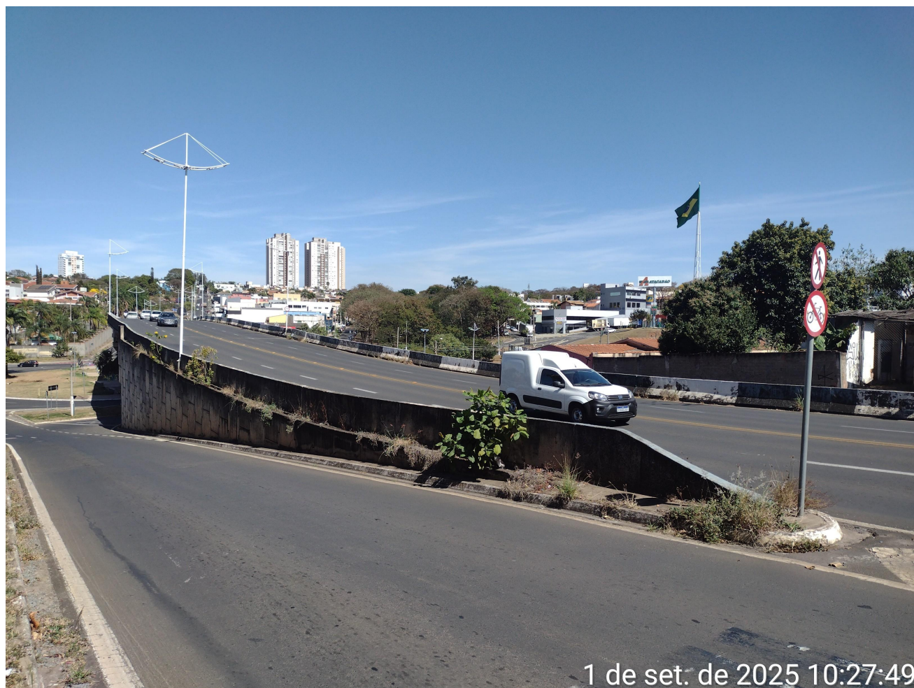
Figura 10 - Vegetação crescendo entre contenção e aterro, podendo comprometer a estabilidade
