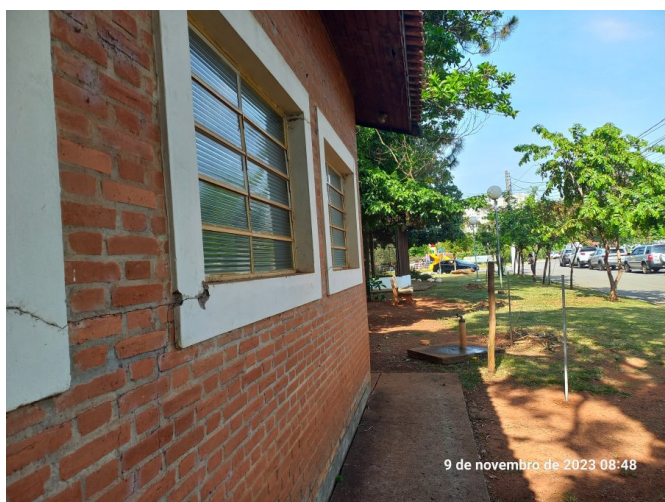
Trincas observadas na fachada da edificação.
