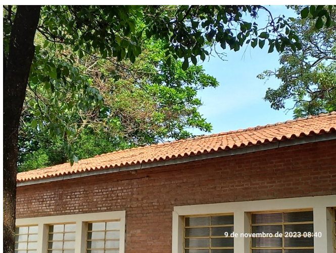
Telhado apresenta abaulamento do madeiramento.
