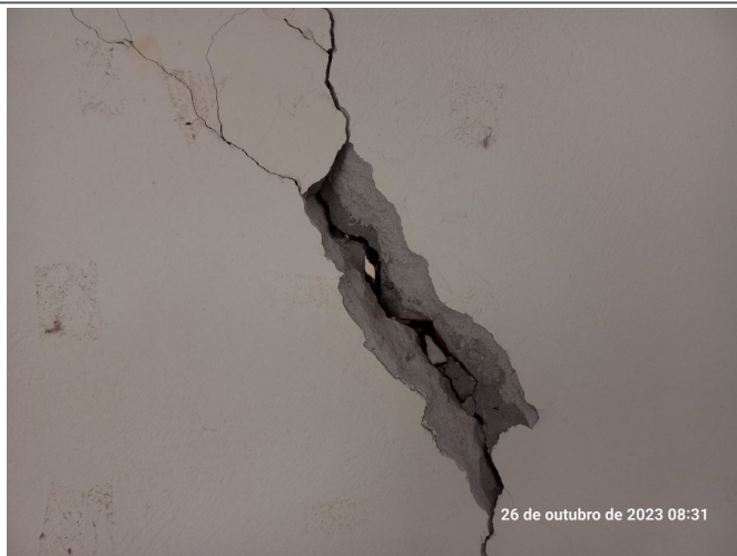
Trinca presente na sala dos fiscais do meio ambiente.
