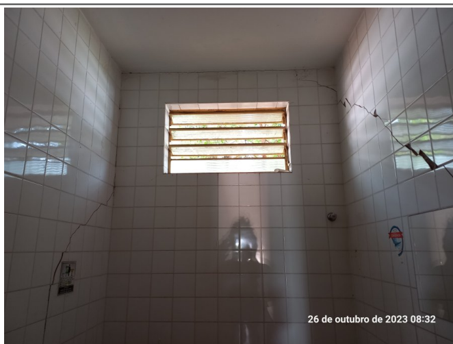
Trincas presentes no sanitário PCD.
