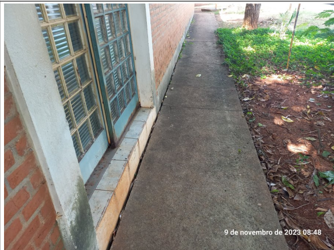
Calçada externa apresenta sinais de movimento de solo decorrente de recalque.
