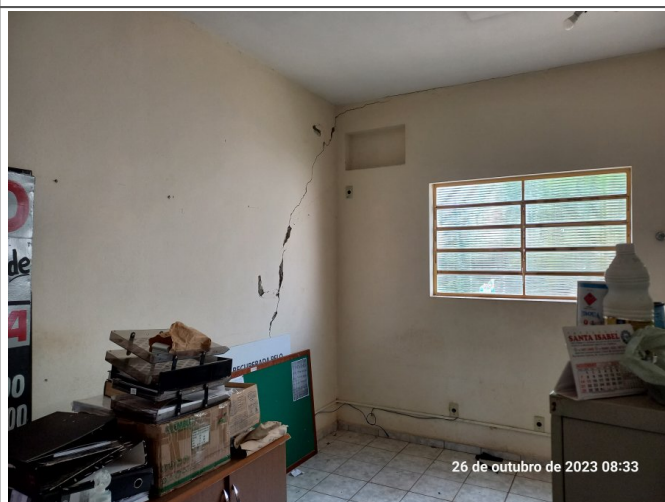
Trinca presente na sala dos fiscais de ambulantes e feirantes.
