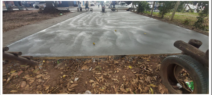
Rua Chico Mendes - Jd. Ernesto Kuhl - (Nivelamento do piso com acabadora de superfície)
