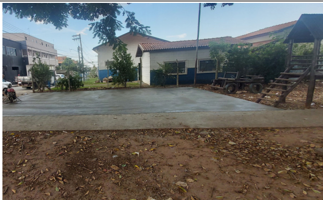
Rua Chico Mendes - Jd. Ernesto Kuhl - (Nivelamento do piso com acabadora de superfície)
