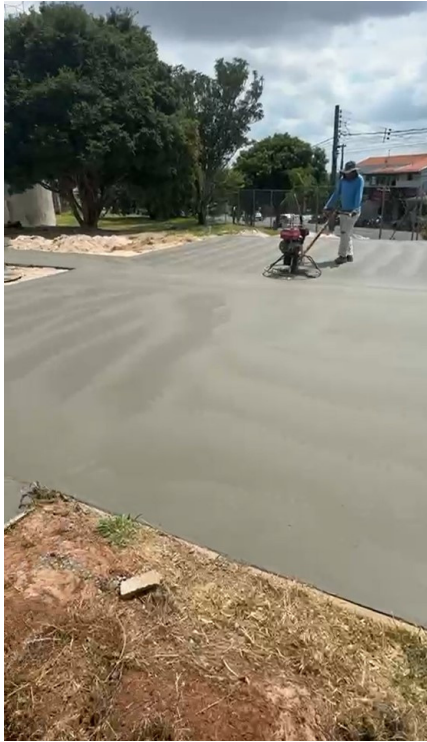
Rua Jose Aparecido Campanini (Centro Esportivo) Execução de nivelamento e acabamento do piso com acabadora de superfície
