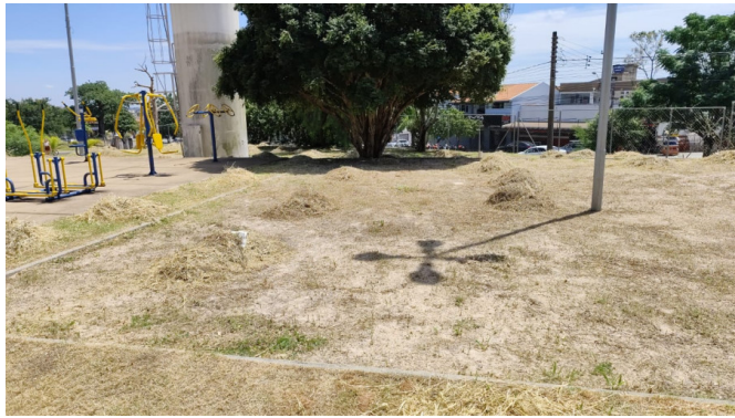
Rua José Aparecido Campanini (Centro Esportivo)- Jd. Roseira -(Limpeza e regularização do terreno)
