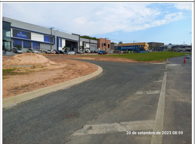
Base do pavimento do retorno no canteiro central da via Luís Varga.
