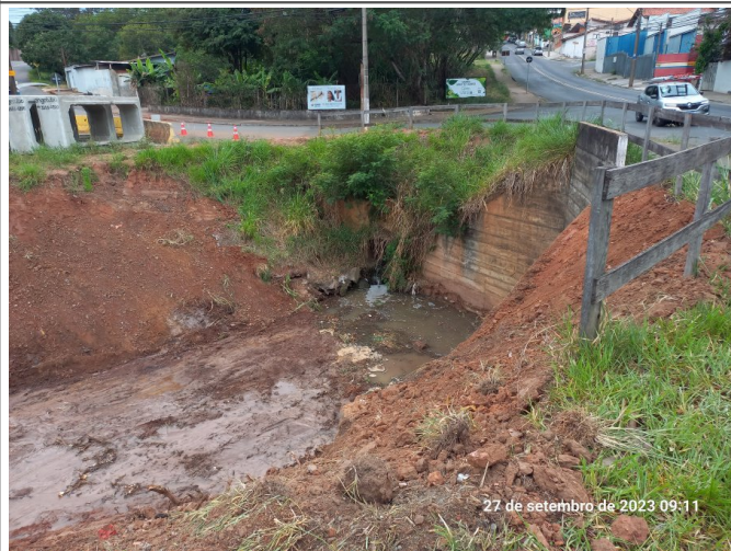
Movimentação de solo na travessia (aduela existente que será mantida, localizada na rua General Rondon).
