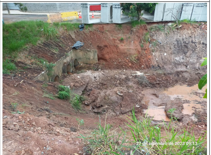
Tubulação de drenagem a ser substituída por aduela.
