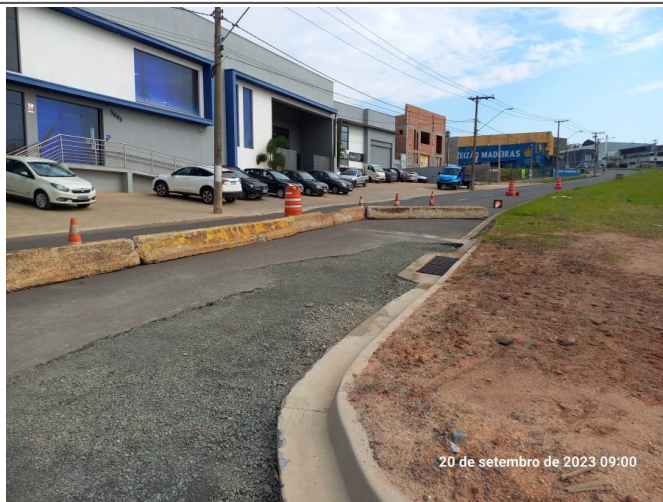
Base do pavimento do retorno no canteiro central da via Luís Varga.
