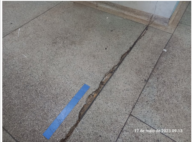
Trinca no piso, localizada no térreo e no pavimento superior.
