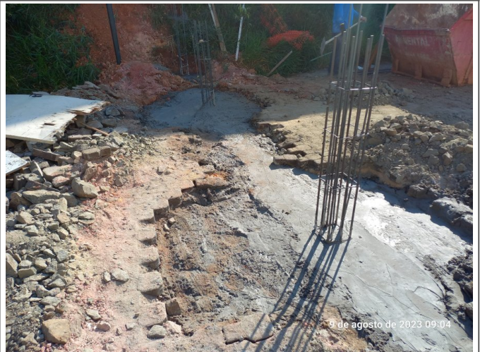
Concretagem de sapata e viga baldrame referentes à fundação do muro aos fundos.
