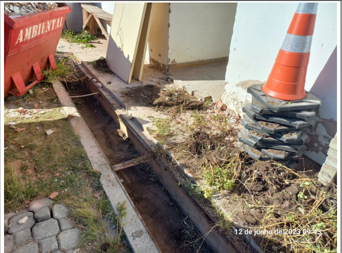
Limpeza de calha de drenagem de água pluvial e remoção de grade.
