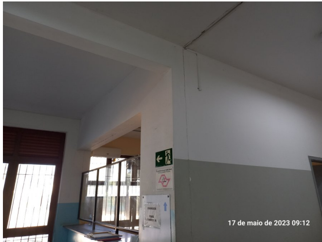
Fissura em parede, localizada no térreo e no pavimento superior.
