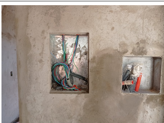
Instalações elétrica e dados.
