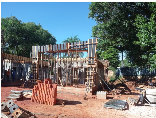
Execução da alvenaria, superestrutura e lajes, infraestrutura para instalações elétricas e hidrossanitárias
