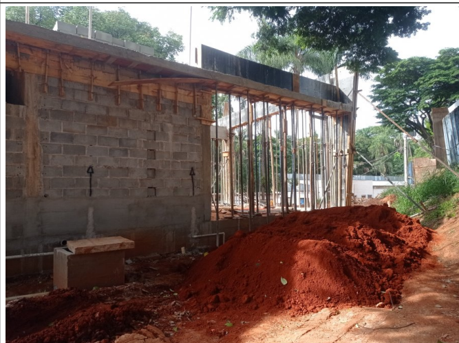
Execução da alvenaria e superestruturas, infraestrutura para instalações elétricas e hidrossanitárias, terraplenagem.
