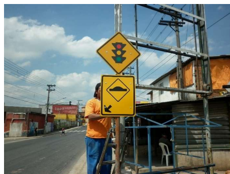
Placa de Advertência
