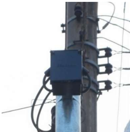
Caixa de entrada com disjuntor
