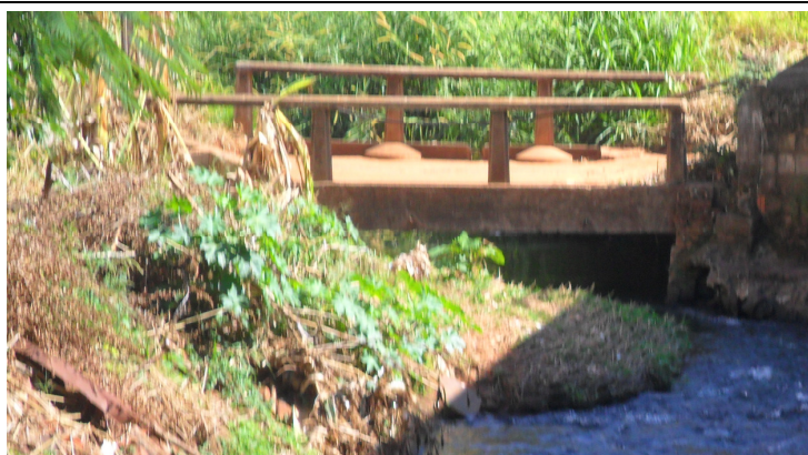
Figura 4 – Assoreamento a montante da seção existente
