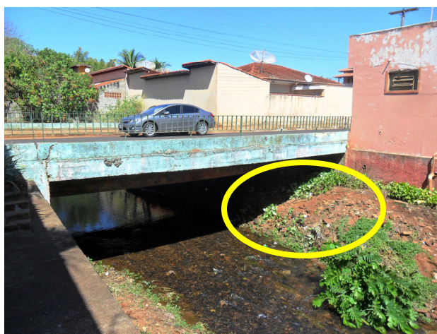
Figura 2 – Obstrução sob a ponte
