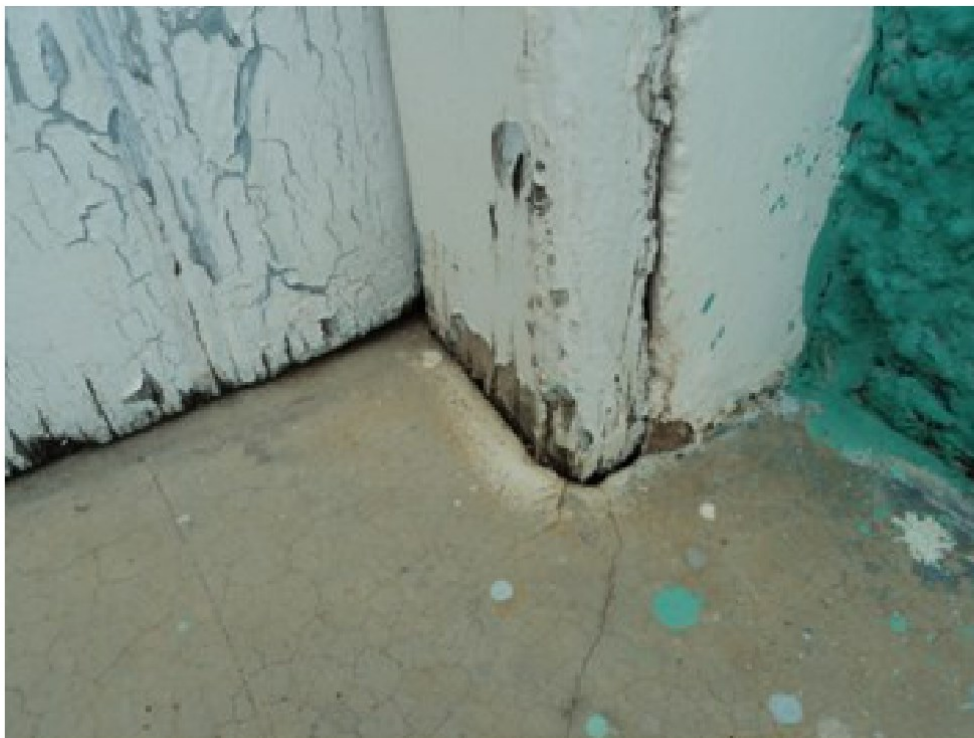
Foto 12 - Capela Nossa Senhora da Penha - Detalhe do portal danificado Dezembro/2022 - Foto: Fábio de Castro Alves
