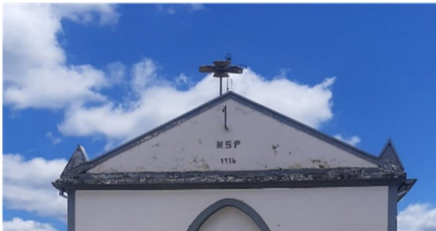
Foto 5 - Capela de Nossa Senhora da Penha - Detalhe do frontão (bastante deteriorado) Dezembro/2022 - Foto: Fábio de Castro Alves
