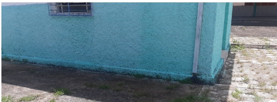
Foto 7 - Capela Nossa Senhora da Penha - Detalhe das manchas de umidade na lateral direita Dezembro/2022 - Foto: Fábio de Castro Alves
