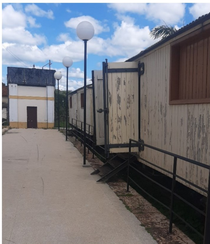
Foto 8 - Antigos Vagões da Cia Mogiana - Vista geral das laterais - camada pictória severamente danificada. Dezembro/2022 - Foto: Fábio de Castro Alves
