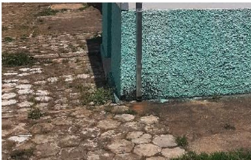
Foto 6 - Capela de Nossa Senhora da Penha - Detalhe do condutor provocando manchas pela base Dezembro/2022 - Foto: Fábio de Castro Alves
