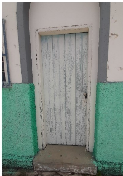
Foto 11 - Capela Nossa Senhora da Penha - Detalhe da porta (camada pictórica bastante danificada) Dezembro/2022 - Foto: Fábio de Castro Alves
