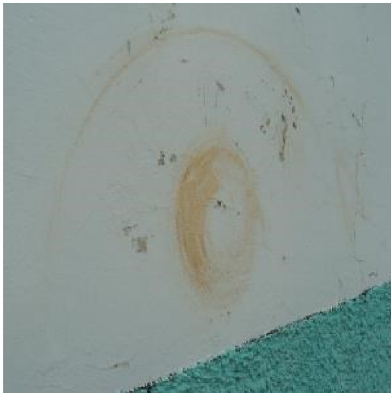
Foto 9 - Capela Nossa Senhora da Penha - Detalhe da fachada posterior com danos sofridos no reboco e pintura Dezembro/2022 - Foto: Fábio de Castro Alves
