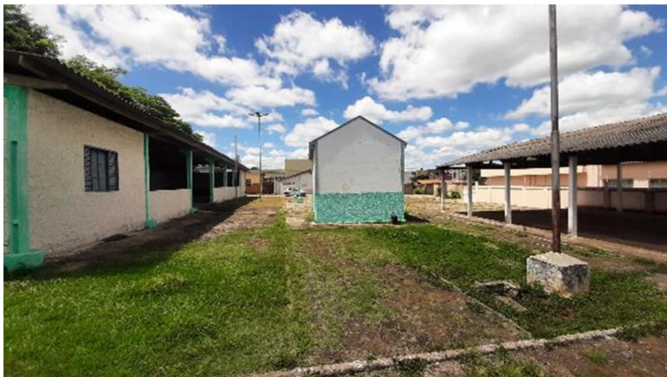
Foto 18 - Capela de Nossa Senhora da Penha – Visão geral – passeios externos por onde nascem gramineas, descaracterizando o bem. Dezembro/2022 - Foto: Fábio de Castro Alves
