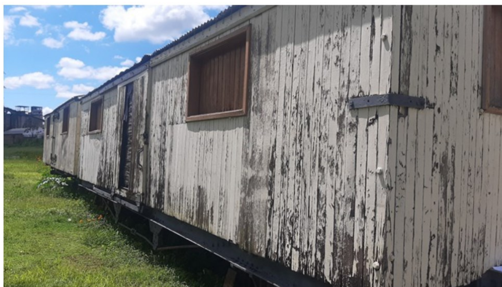
Foto 12 - Antigos Vagões da Cia Mogiana - Vista geral da frontal do vagão dormitório - camada pictórica danificada. Dezembro/2022 - Foto: Fábio de Castro Alves
