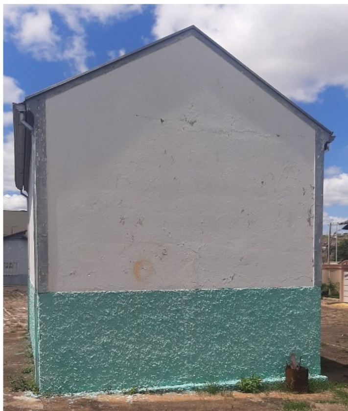
Foto 8 - Capela Nossa Senhora da Penha - Fachada posterior com danos sofridos na pintura (pintura apresentando desgastes) Dezembro/2022 - Foto: Fábio de Castro Alves
