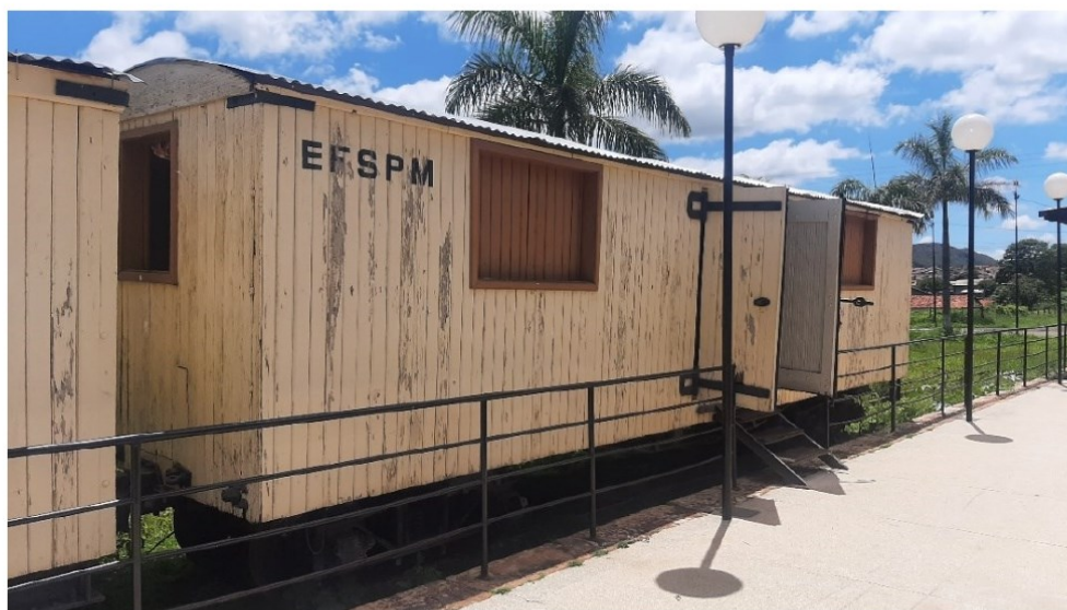
Foto 10 - Antigos Vagões da Cia Mogiana - Vista geral da lateral do vagão escritório - camada pictória danificada. Dezembro/2022 - Foto: Fábio de Castro Alves
