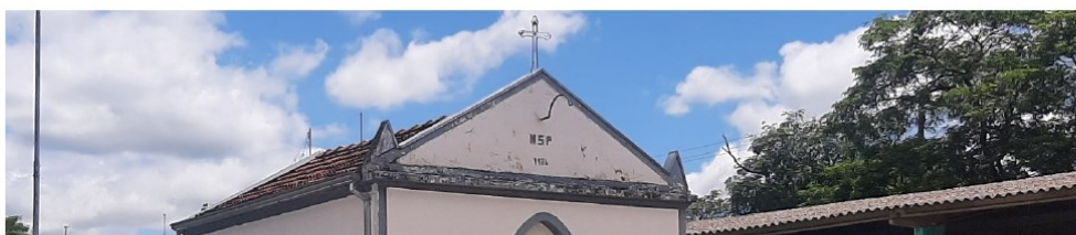
Foto 17 - Capela de Nossa Senhora da Penha – Detalhe da Cruz sobre frontão com danos e sem iluminação Dezembro/2022 - Foto: Fábio de Castro Alves
