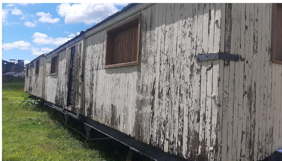
Foto 4 - Antigos Vagões da Cia Mogiana - Vista lateral do vagão dormitório - detalhe da lateral severamente danificada Dezembro/2022 - Foto: Fábio de Castro Alves
