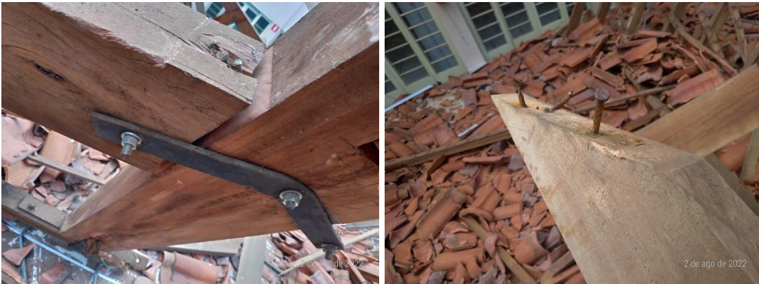
Esquerda: falta de encaixa na tesoura. Direita: emenda lisa na cumeeira, com apoio de apenas dois pregos, sem encaixe.
