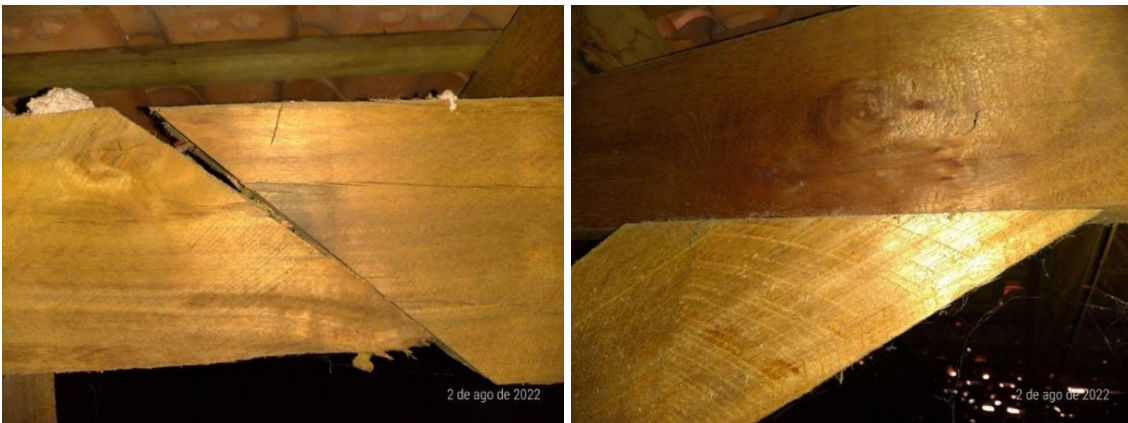
Imagens da estrutura do telhado dos prédios próximos, construídos pela mesma construtora, sem encaixes nas emendas. Necessário reforço do madeiramento.
