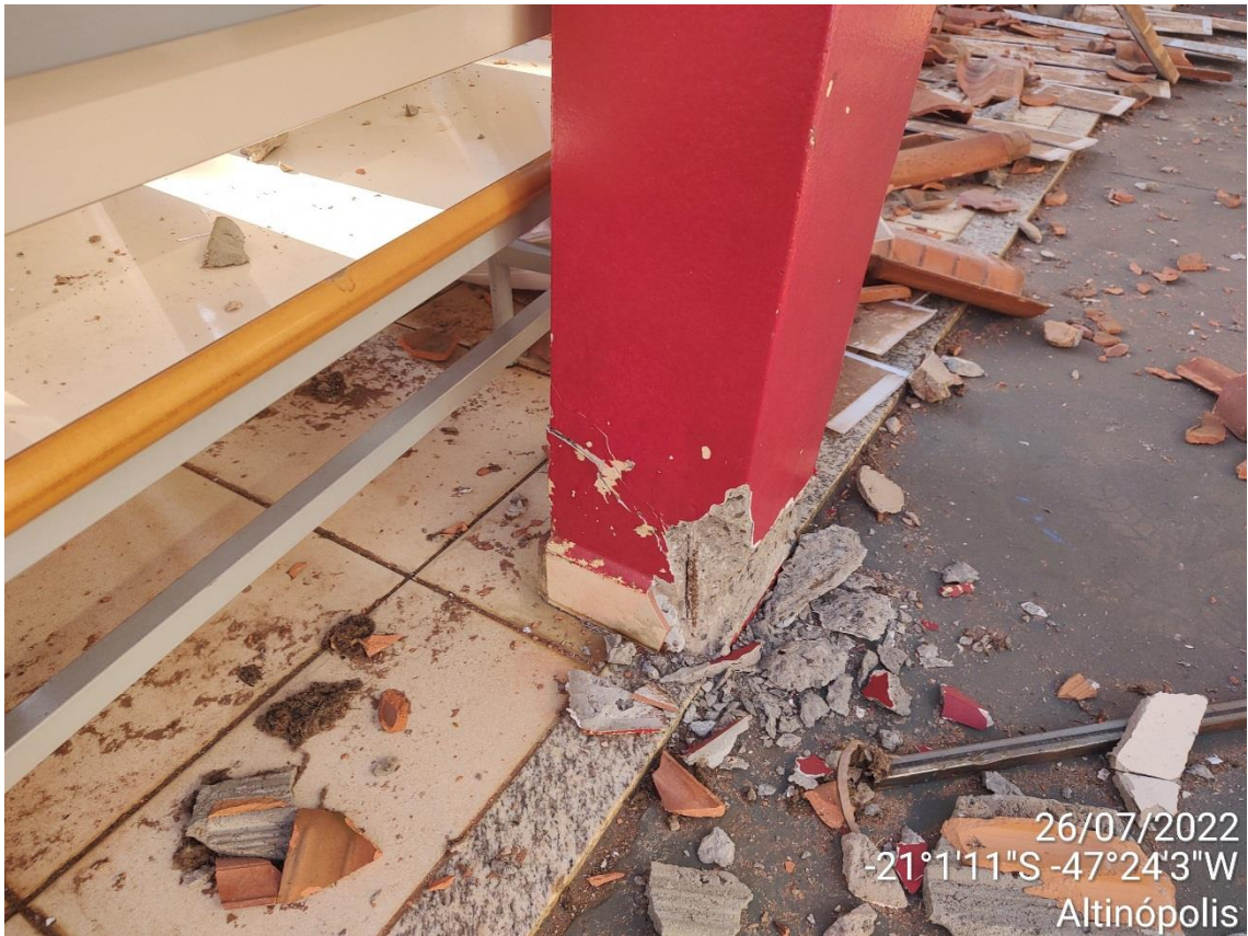
Foto 14 Mudanças nos esforços na estrutura da cobertura (torção)
