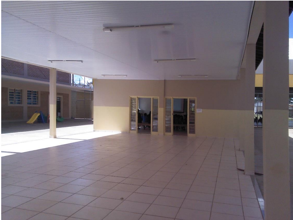
Foto 04 que mostra que não existia cobertura ligando o pátio com a salas de aula
