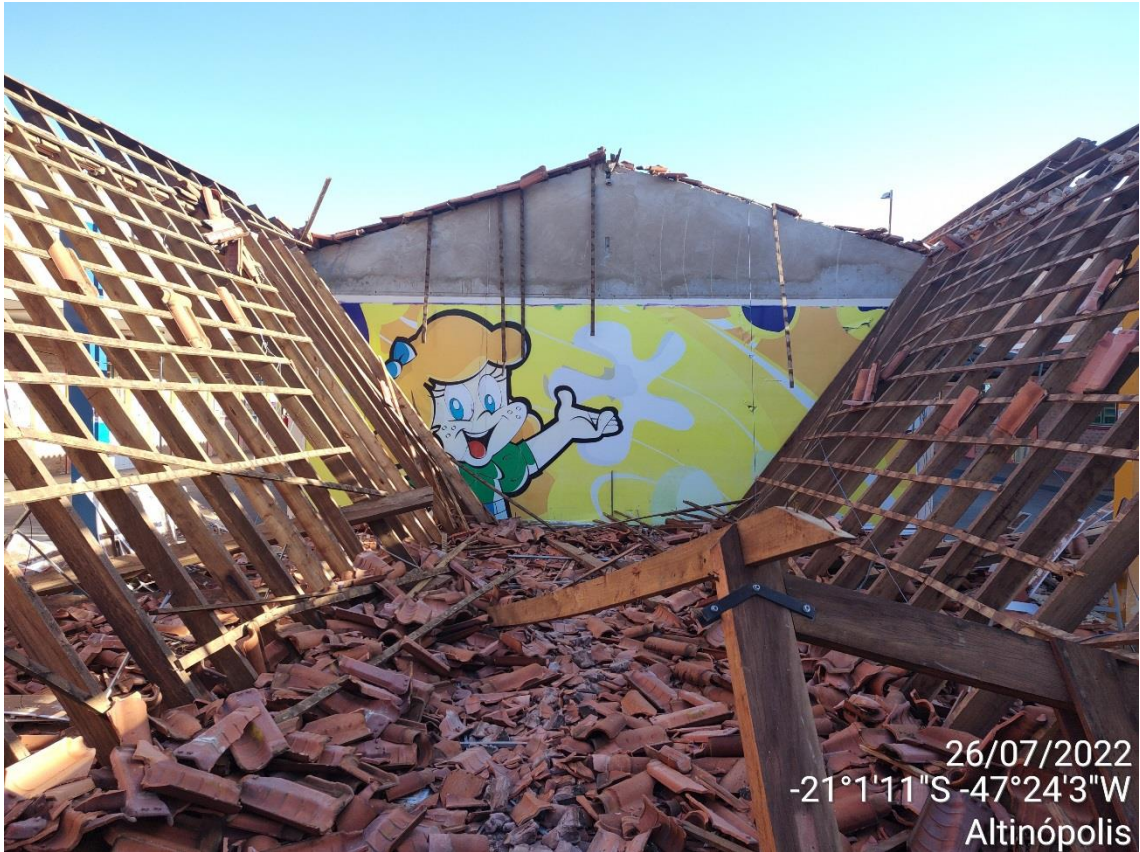
Foto 09 Com desencaixe do apoio das tesouras o telhado desmoronou.
