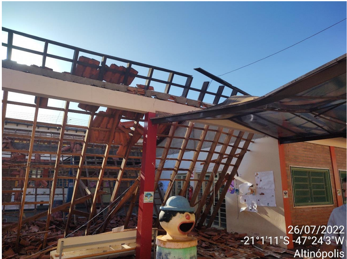
Foto 15 Cobertura construída pela Prefeitura posteriormente a entrega da obra pela Empresa
