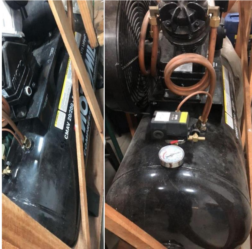
imagem 01,02 compressor de ar.
