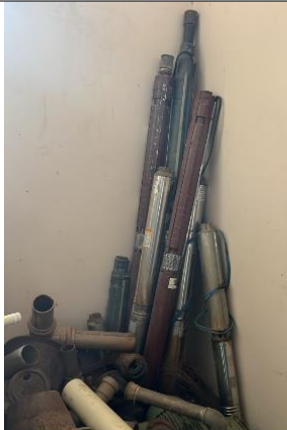
Bombas submersas com defeito.
