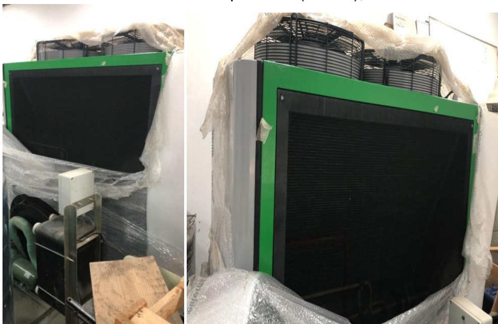
Imagem 01, 02 – sistema de água gelada.
