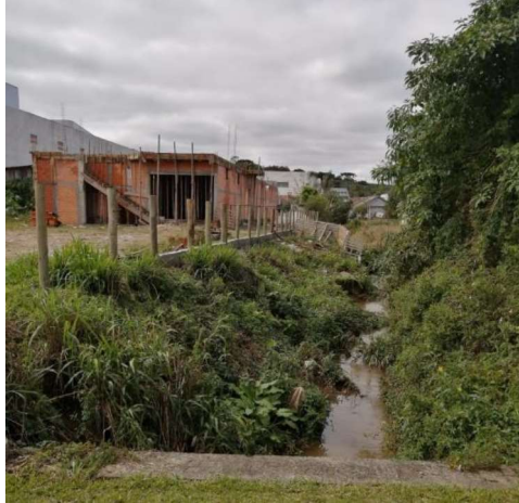
Figura 5-3 – Afluente do Rio dos Patos, com intervenção na APP e erosão do talude.
