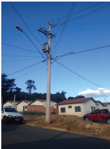
Figura 09— Vista do poste com transformador elétrico, na Avenida Santo Pelózio
