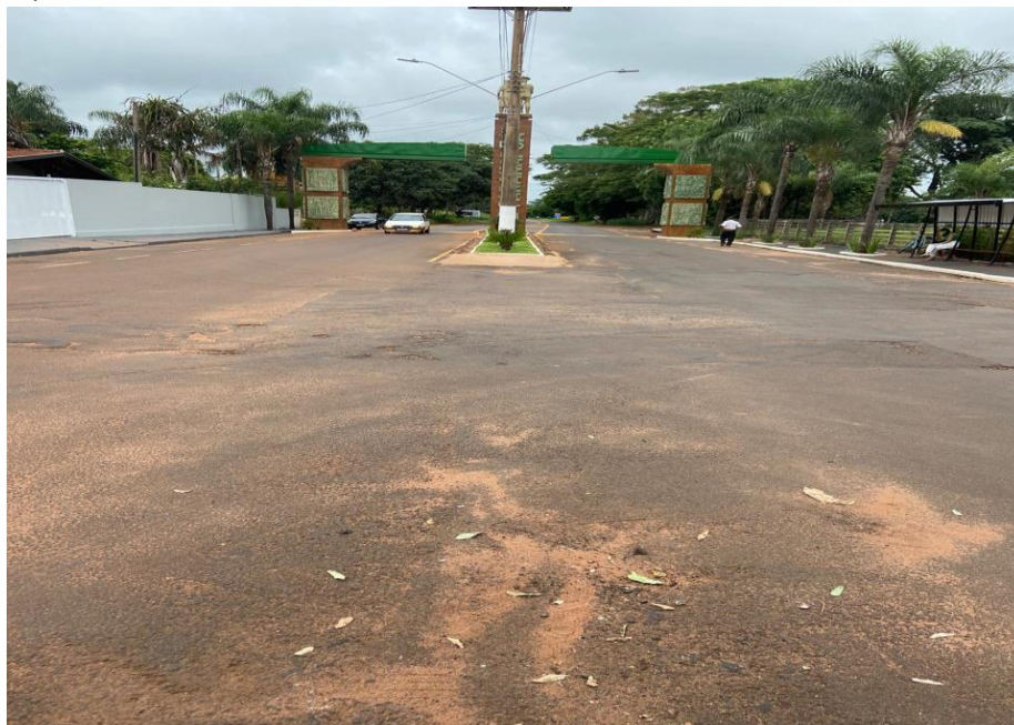
Avenida Ângelo Takaki entre a Avenida Circular C e Portal de Entrada do Município (23/02/2024)
