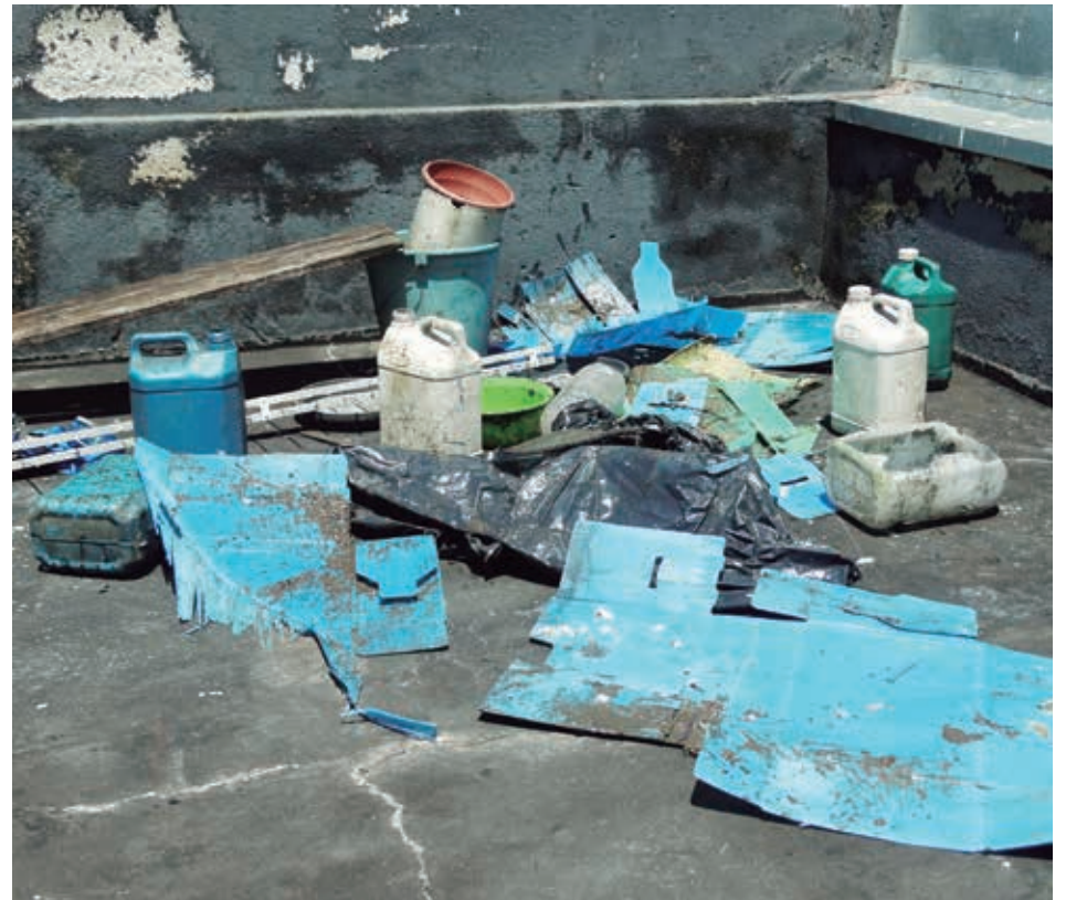
Lixo retirado da passagem de águas pluviais no telhado do Centro Educacional
