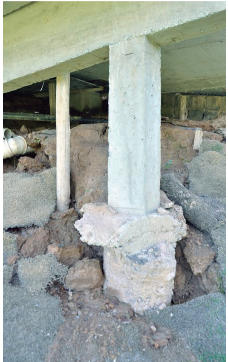
Coluna sob um aterro não está suportando o peso da laje que está cedendo e abrindo grandes fissuras no piso conforme mostra a foto ao lado
