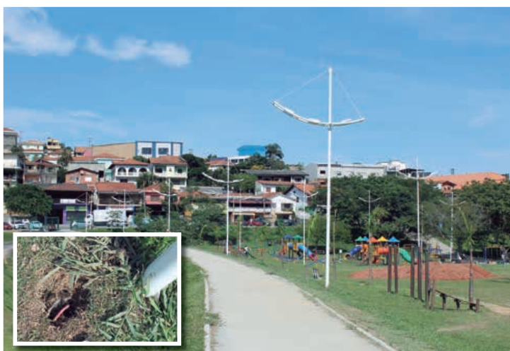
A ação dos vândalos fez com que 14 postes de iluminação deixassem de funcionar. No detalhe a caixa subterrânea por onde passava a fiação
