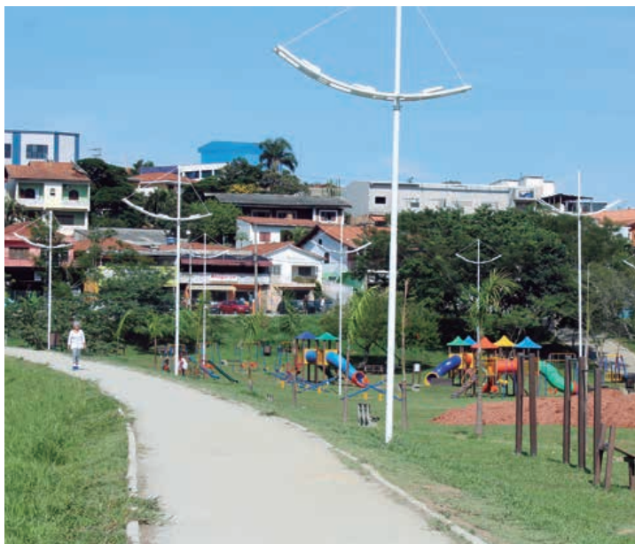
No total, mais de 20 luminárias não estão funcionando
