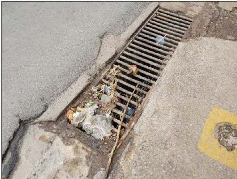
Figura 31 – Presença de resíduos nas bocas coletoras.
