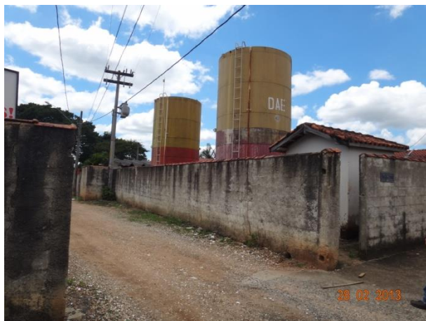
Foto 4.3 – EEAB Casa de Bombas e Reservatórios
