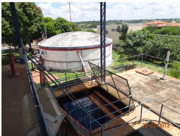
Foto 4.7 – Reservatório na ETA
