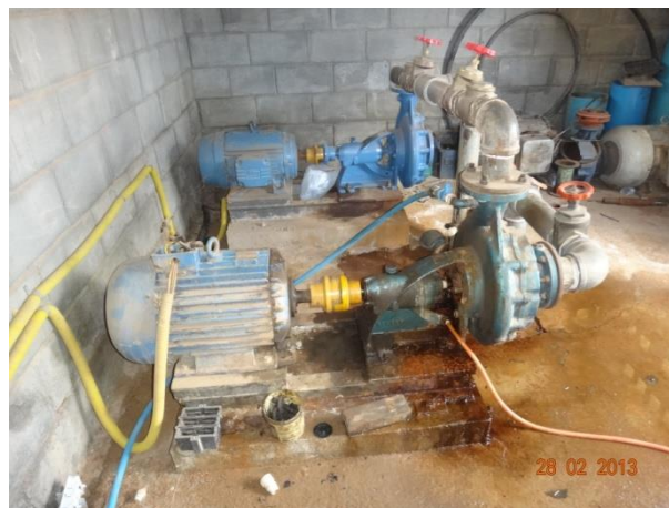
Foto 4.4 – EEAB – Conjuntos Motobomba
